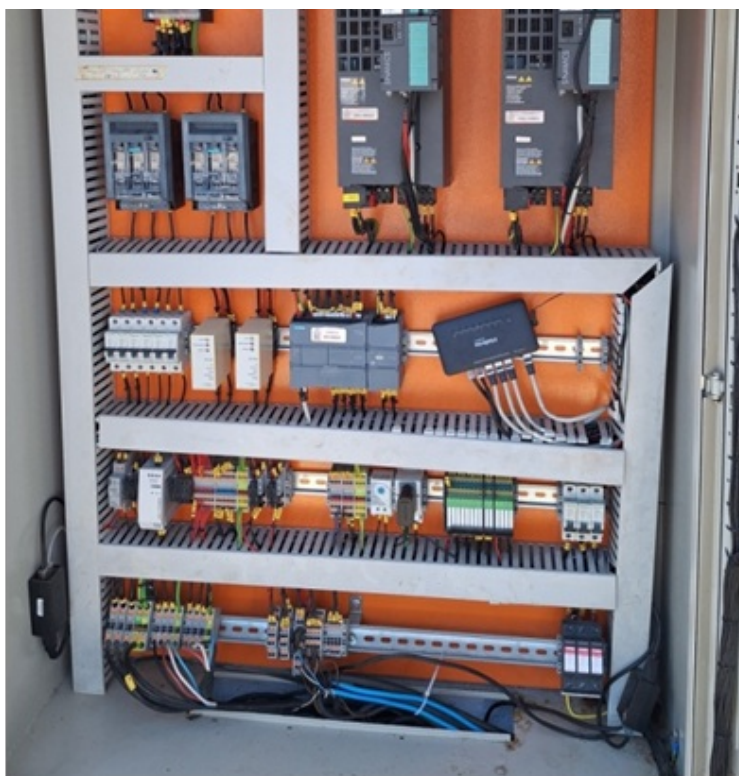
Fotos 3 – Quadro elétrico com telemetria, proteção e inversor de frequência
