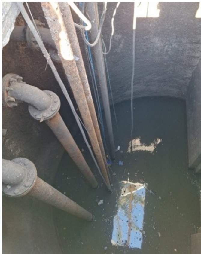
Fotos 4 – Poço das bombas
