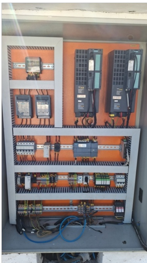
Fotos 3 – Quadro elétrico com telemetria, proteção e inversor de frequência
