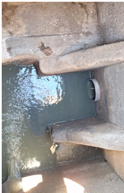
Foto 5 – CTS Miramar que capta de rede de águas pluviais, que recebem ligações de esgotos, desaguando na EEE.
