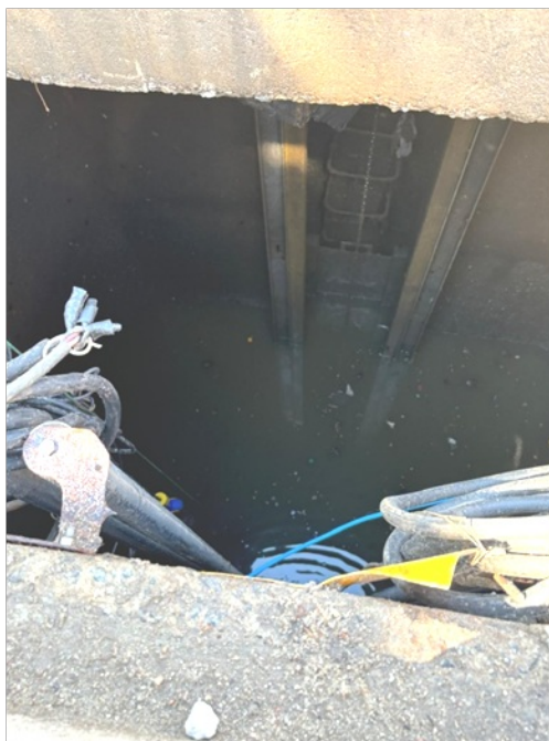
Fotos 4 – Poço das bombas
