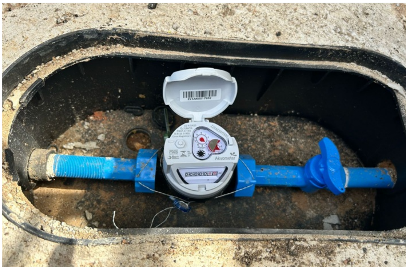
Foto 9 - Hidrômetro externo do imóvel com leitura zerada
