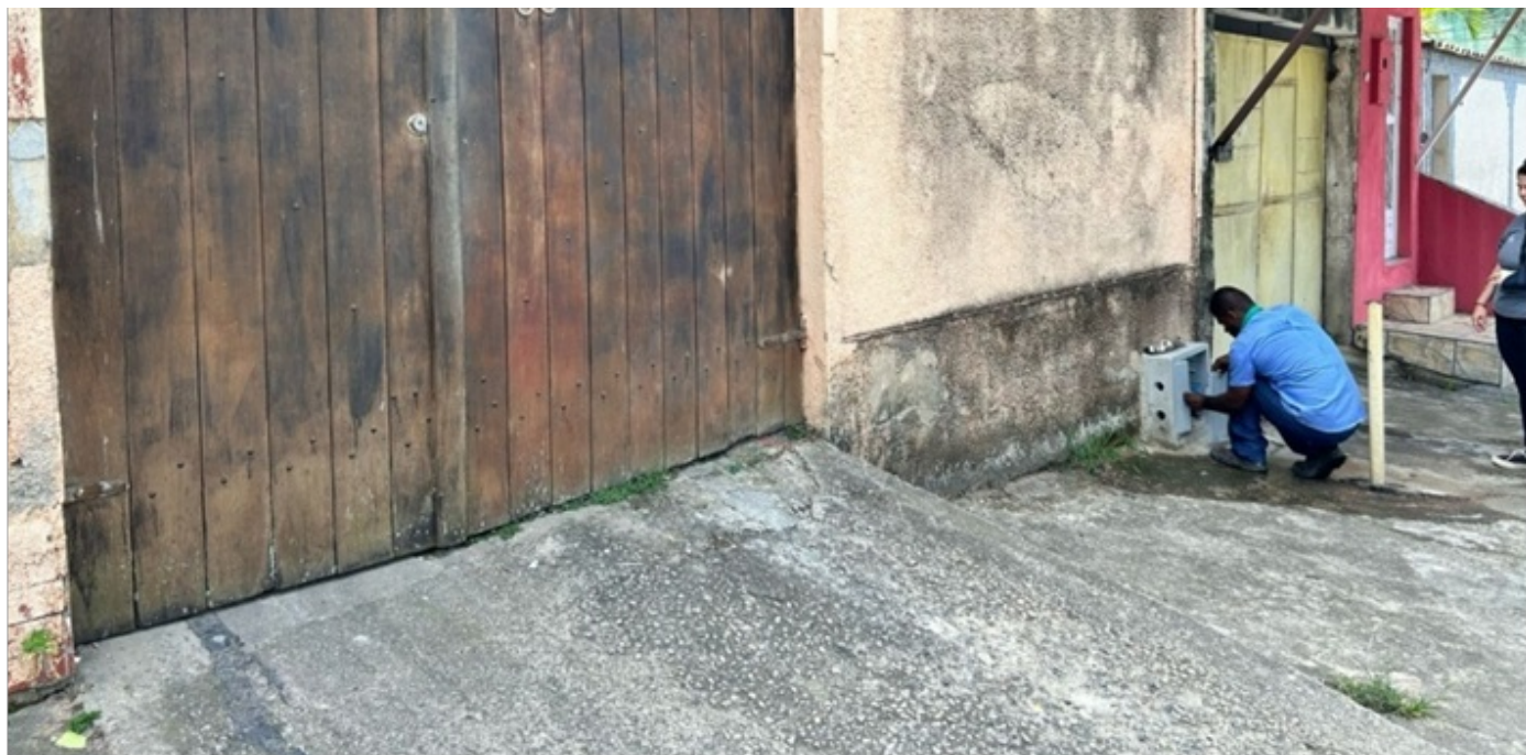
Foto 6 - Imóvel nº 56, Rua Macapá - Santa Cruz
