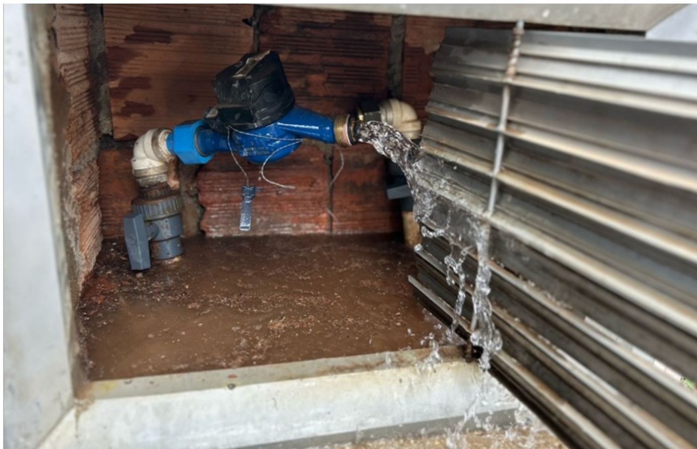
Foto 2 - Abastecimento via rede da Concessionária no hidrômetro no interior do imóvel.
