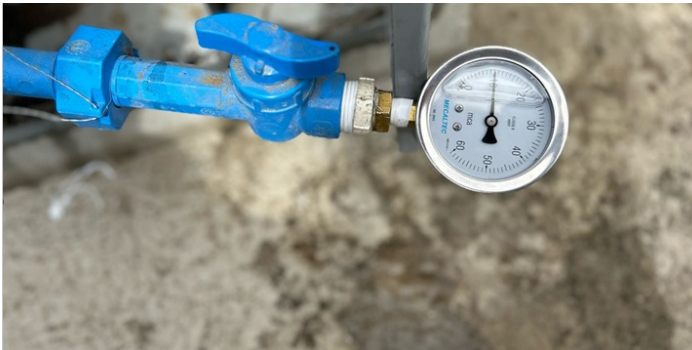
Foto 5 - Pressão aferida de 10 mca no hidrômetro externo
