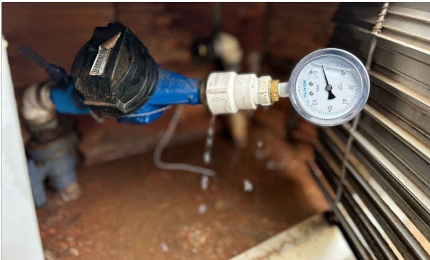
Foto 3 - Pressão aferida em 8 mca no momento da vistoria
