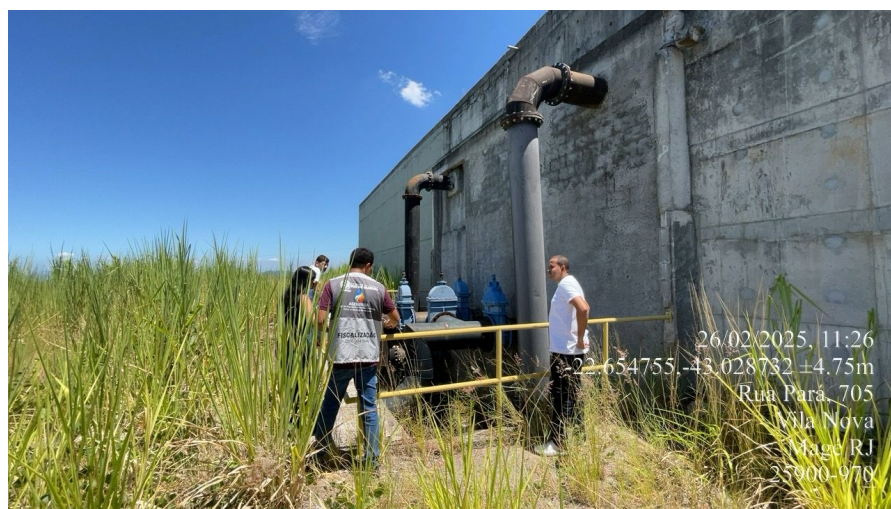
Foto 7 – Tubulações de recalque e extravasora
