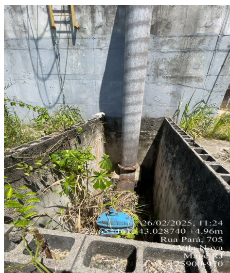
Foto 5 –Tubulação de entrada
