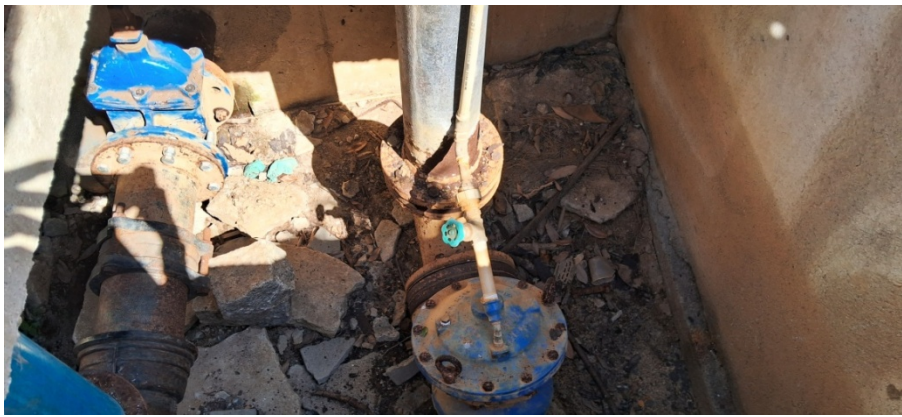
Foto 9 – Válvula controladora de nível
