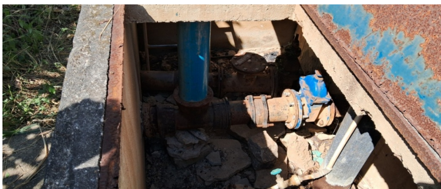
Foto 8 – Tubulação extravasora e limpeza ( todas DN 150 mm)
