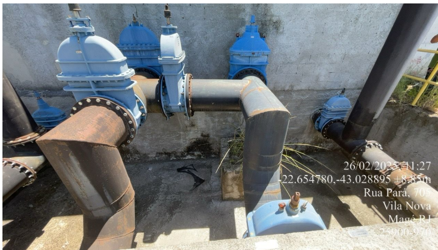
Foto 6 – Tubulação de recalque e extravasora ( ambas DN200 mm)
