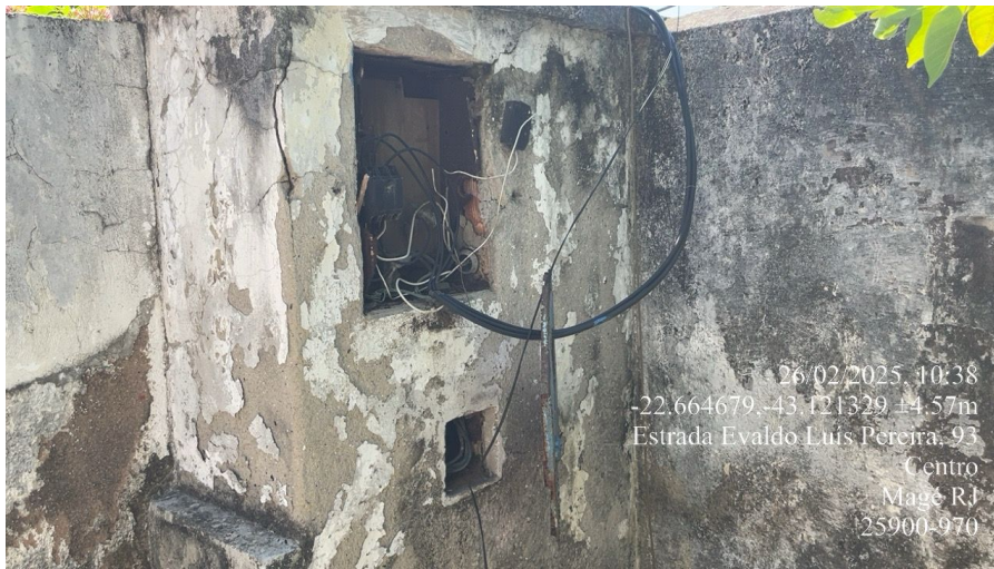
Foto 7 – Quadro de energia
