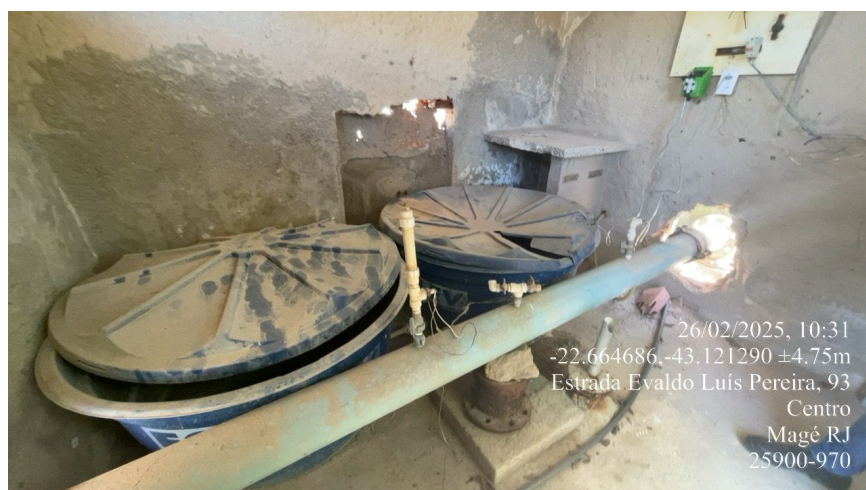
Foto 5 – Tanques de cloração
