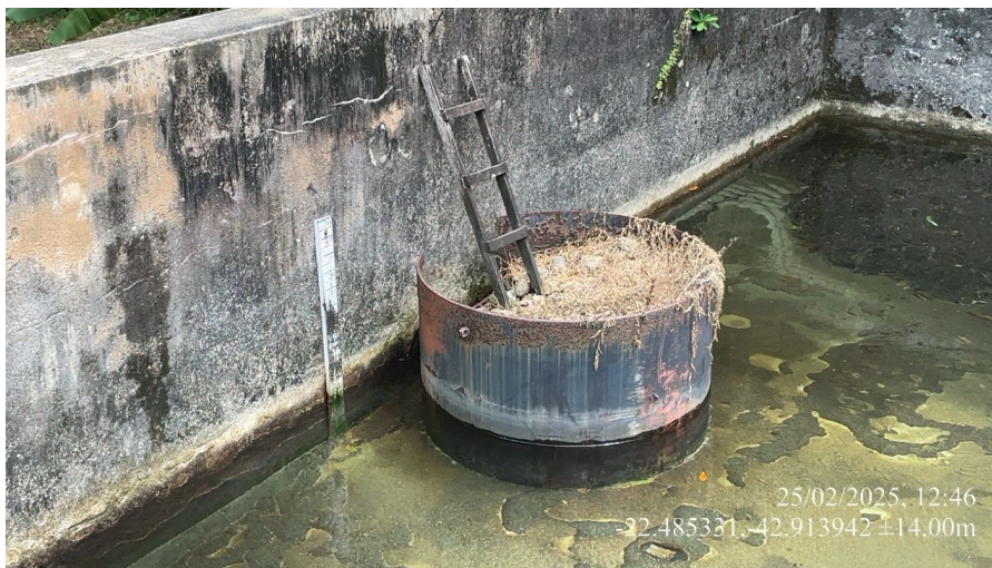
Foto 12 – Saída de água com régua medidora
