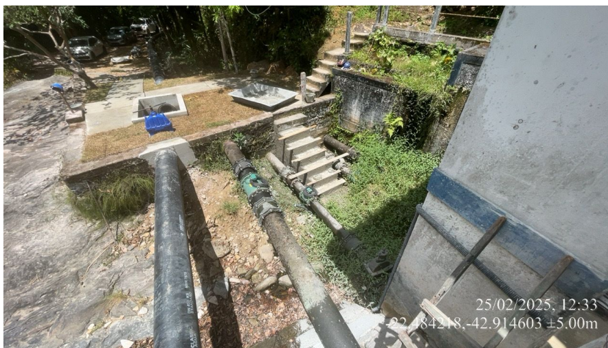
Foto 7 – Tubulação e gradeamento
