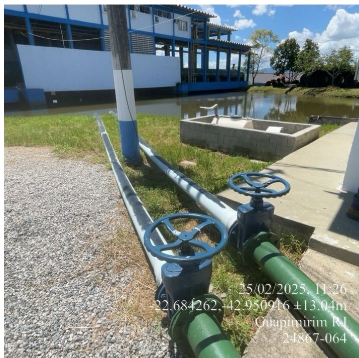
Foto 3 – Tubulação de recalque
