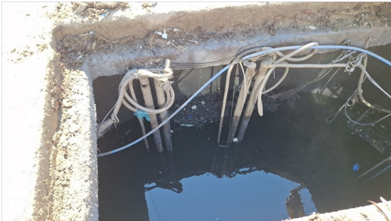
Foto 7 – Poço da Bomba
