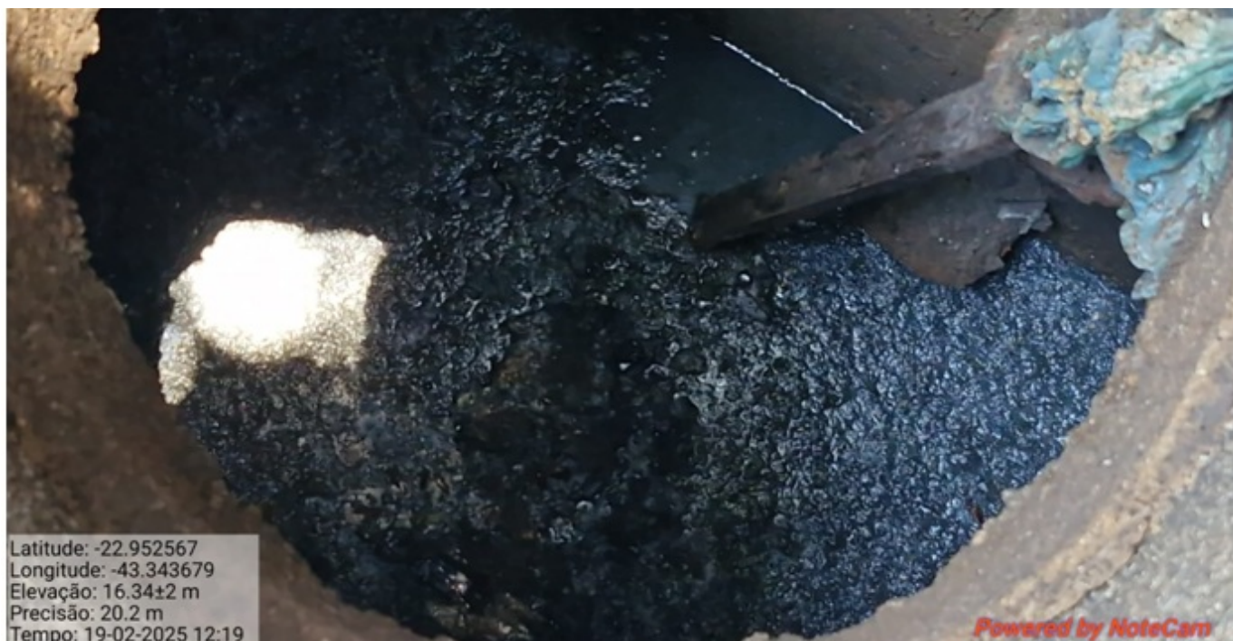
Foto 07 – Interior do 4º PV vistoriado, à jusante, com muito lodo no seu interior
