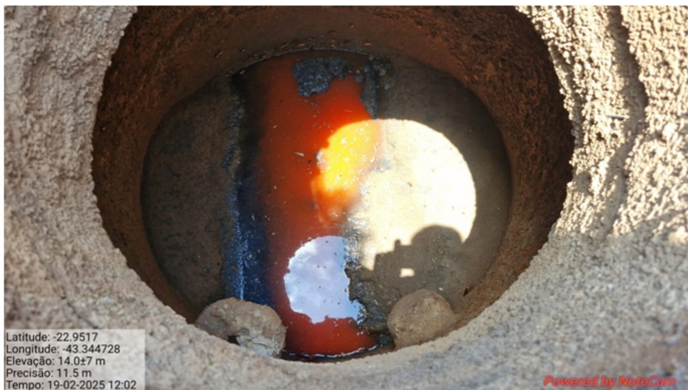
Foto 04 – Corante vermelho passando no PV a jusante, em frente a rua Soldado João Alves
