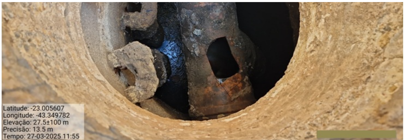
Foto 13 – PV do Coletor Tronco
