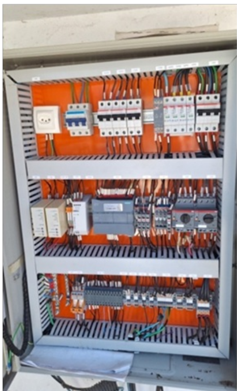
Foto 4 – Quadro Elétrico com telemetria e proteção
