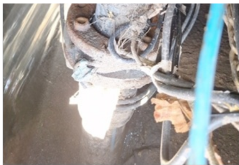
Foto 10 – Recalque da Bomba
