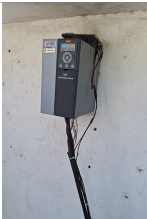
Foto 5 – Inversor de frequência
