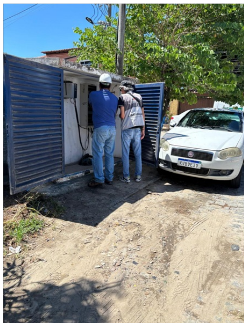
Foto 2 –EEE Pitória – Abrigo do quadro elétrico
