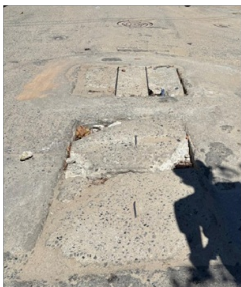
Foto 8 – Tampões de concreto quebrados
