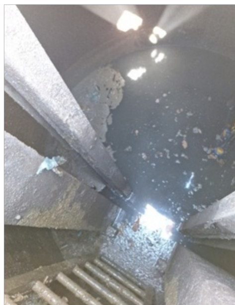
Foto 9 – Caixa de areia e cesto da EEE, com perfis para colocação de comporta em caso de manutenção/limpeza
