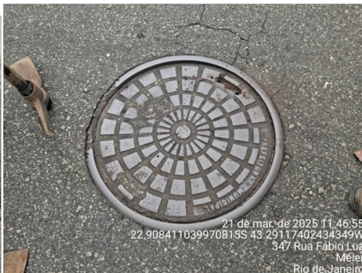
Imagem 9 – Tampa do PV de águas pluviais
