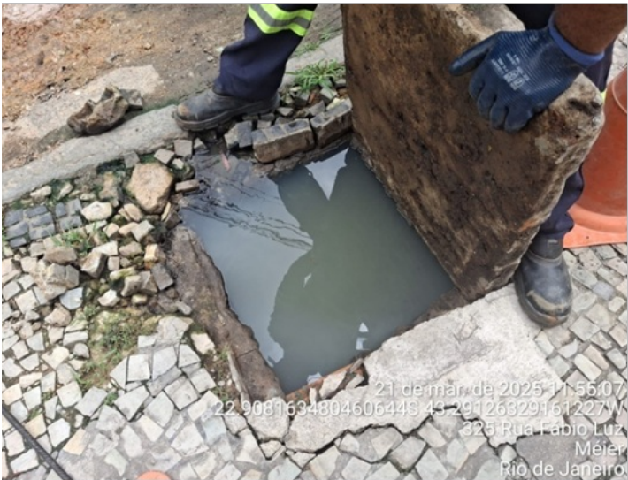
Imagem 4 - Caixa de águas pluviais “afogada”
