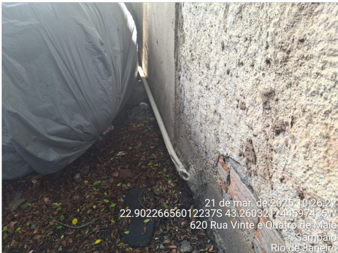
Foto 5 – Possível ligação irregular
