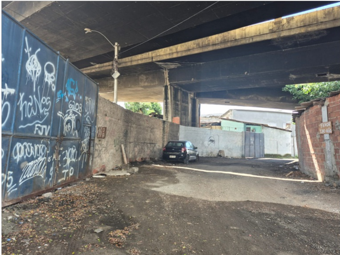
Foto 6 – Viaduto com possível problema no escoamento pluvial
