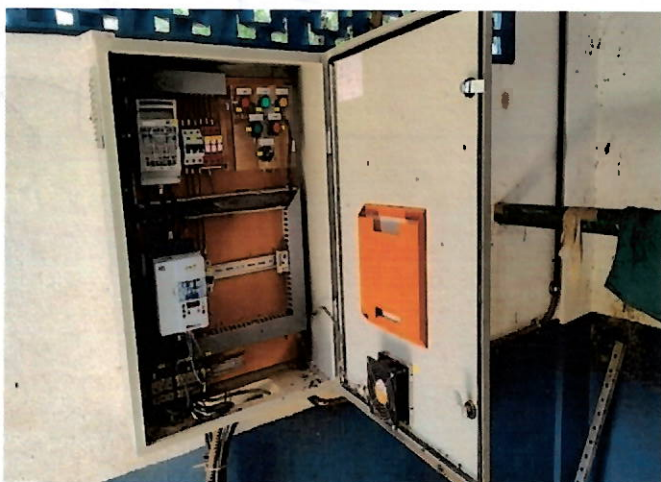
Foto 5: Vista interna do painel elétrico.
