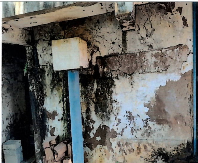
Foto 17: Sinais de vazamentos e infiltrações.
