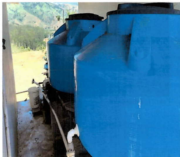
Foto 16: armazenamento de sulfato de alumínio (ausência de bacia de contenção).
