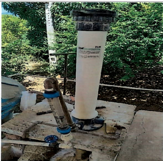
Foto 9: Equipamento dosador de cloro.
