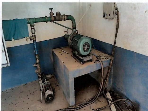
Foto 4: Grupo motobomba 25 CV.
