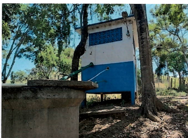
Foto 6: Vista do Abrigo do conjunto motobomba.
