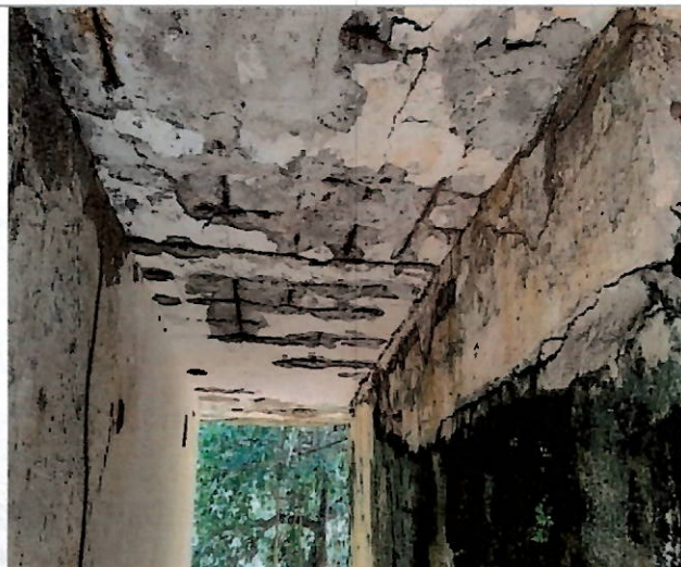
Foto 18: Estruturas do decantador danificadas (necessita de recuperação estrutural).
