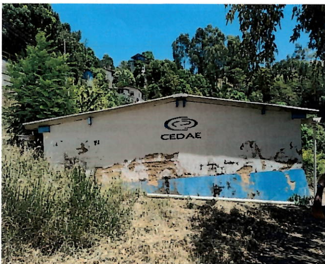
Foto 23: Vista do reservatório (necessitando de restauração do revestimento).
