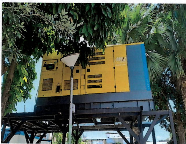
Foto 5: Gerador de energia elétrica.
