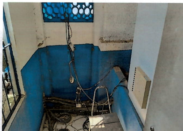
Foto 4: instalações elétricas em desconformidade a NR 10.
