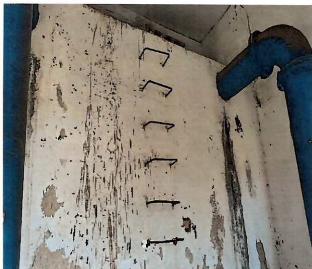
Foto 26: Escada com ausência de gaiola de proteção.
