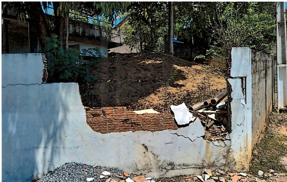
Foto 6: Muro da estação de tratamento necessitando de reparos.
