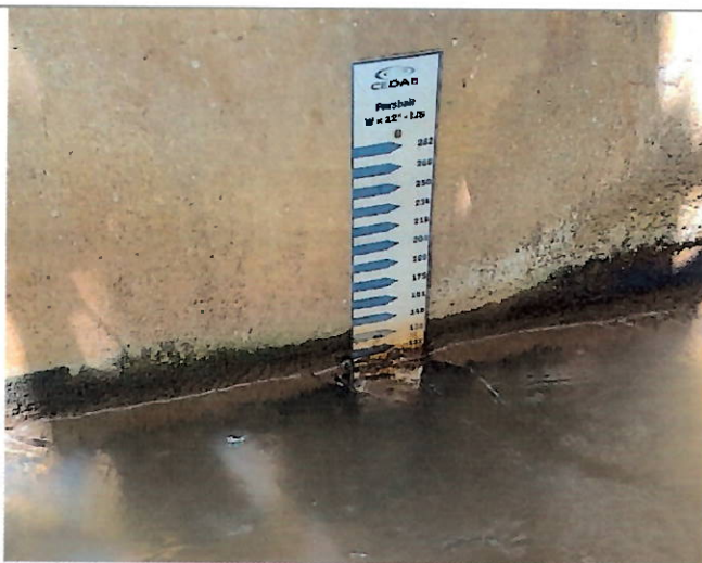
Foto 7: Régua medidor de vazão Calha Parshall.
