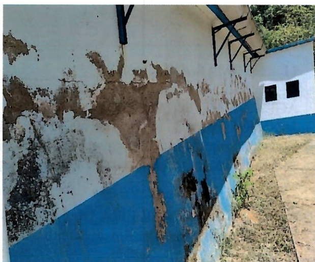
Foto 24: Vista lateral do reservatório (necessitando de restauração do revestimento).
