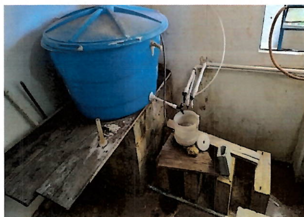
Foto 16: Armazenamento de sulfato de alumínio (ausência de bacia de contenção).
