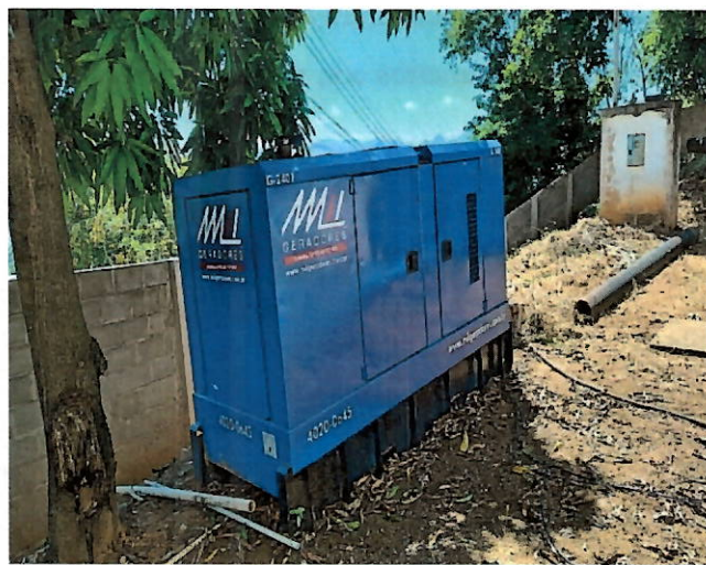
Foto 20: Gerador de Energia.
