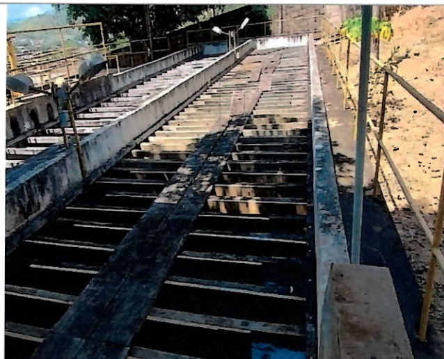
Foto 8: início da passagem da água pelo tanque de floculação.
