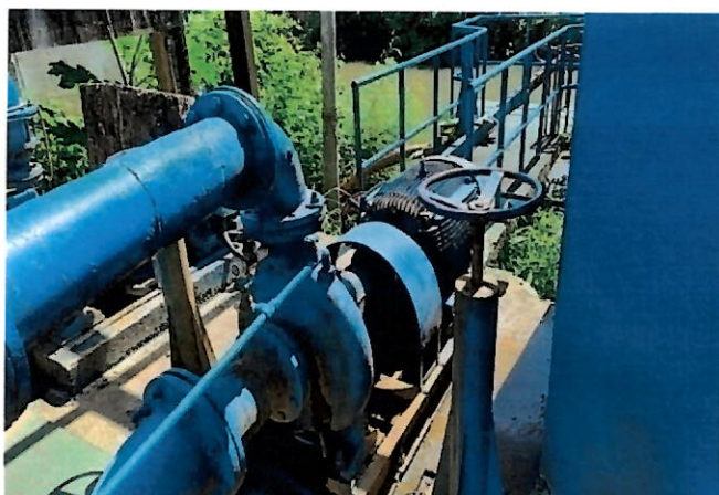
Foto 3: Conjuntos motobombas para adução de água bruta.
