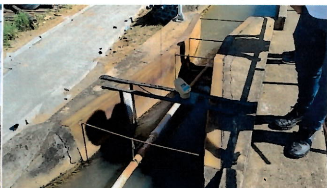
Foto 12: Calha Parshall com régua de medição de vazão. (existe medidor eletrônico, mas não está em funcionamento).
