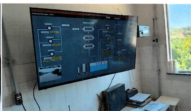
Foto 31: CCO em fase de teste.
