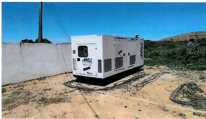
Foto 32: Grupo gerador de 500 KVA.
