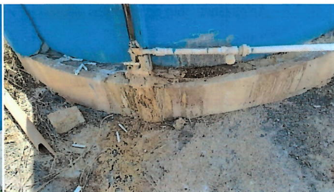
Foto 26: indícios de vazamento nas conexões (parte inferior).
