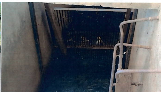
Foto 4: Grade em funcionamento.
