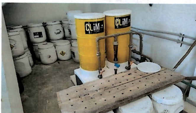
Foto 21: área de armazenamento de Hipoclorito de Cálcio.
