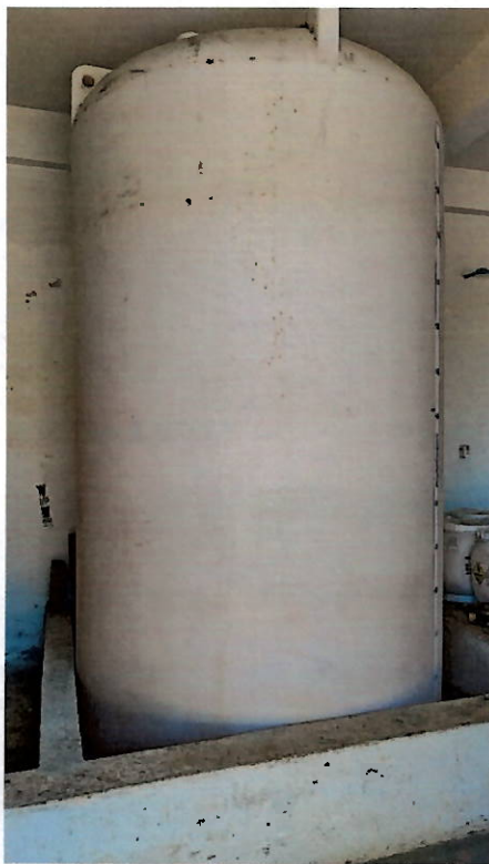
Foto 27: Armazenamento Ácido Fluossilícico (bacia de contenção subdimensionada).
