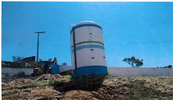
Foto 23: Tanque de armazenamento de Sulfato de Alumínio (30.000 litros).
