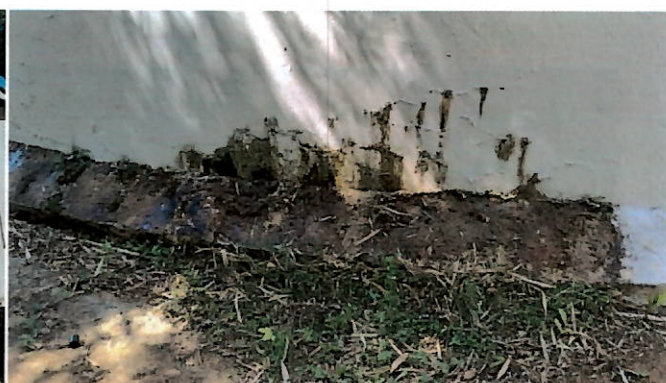
Foto 41: Pontos de infiltração.
