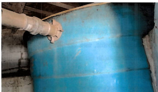
Foto 50: tanque de armazenamento desativado.
