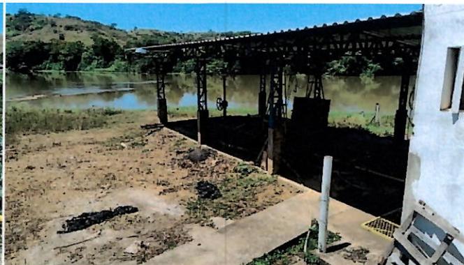
Foto 2: Unidade de captação (ausência de placa de identificação do manancial indicando que o mesmo é utilizado para abastecimento humano).
