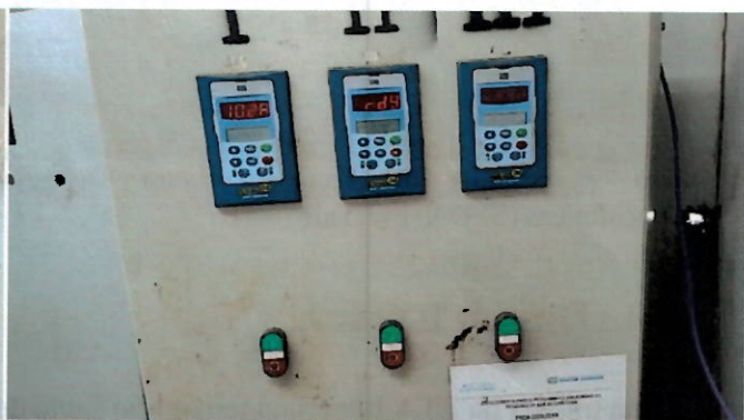
Foto 6: painel elétrico dos CMB.
