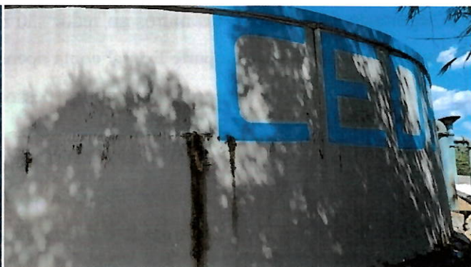
Foto 39: Ponto de infiltração.
