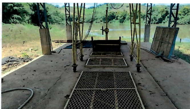
Foto 3: Sistema de gradeamento da captação.
