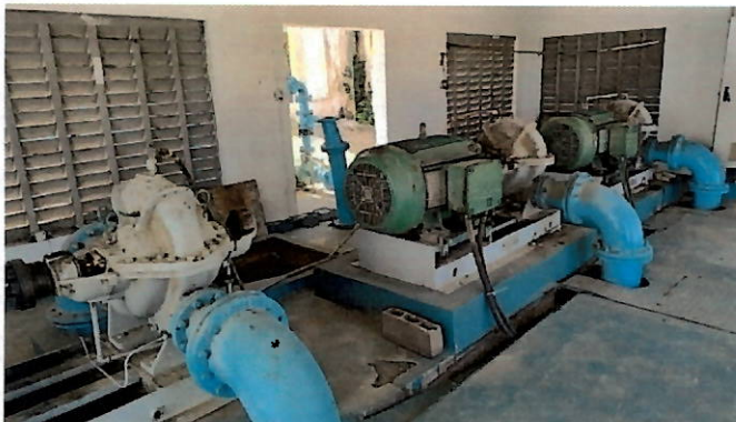
Foto 19: Conjuntos motobombas de 250 CV (o primeiro, da esquerda para a direita, foi retirado para manutenção).
