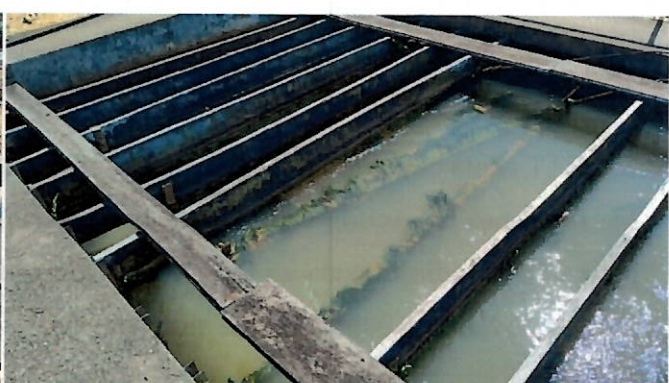
Foto 14: Floculador - chicanas danificadas.
