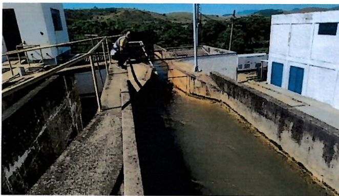
Foto 11: Entrada de água bruta no sistema de tratamento com aplicação do coagulante Sulfato de Alumínio.
