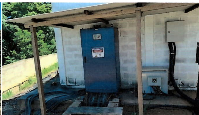
Foto 33: Painel elétrico dos grupos geradores.
