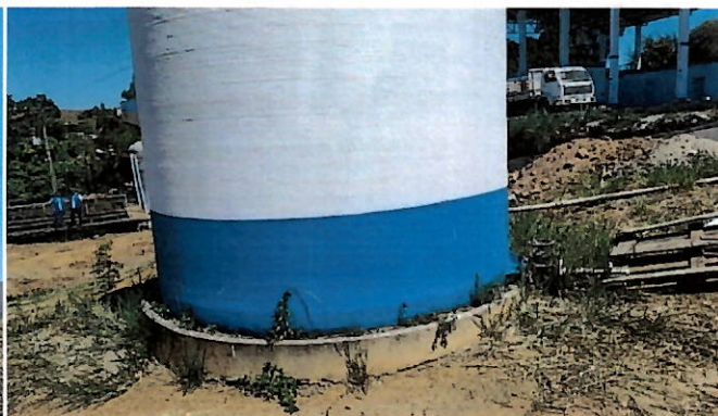
Foto 24: ausência de bacia de contenção.
