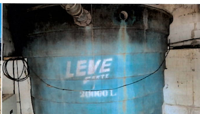
Foto 49: tanque de armazenamento desativado.
