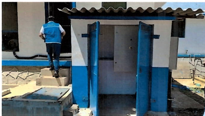
Foto 46: abrigo do painel elétrico.
