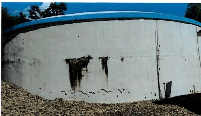
Foto 40: Pontos de infiltração.
