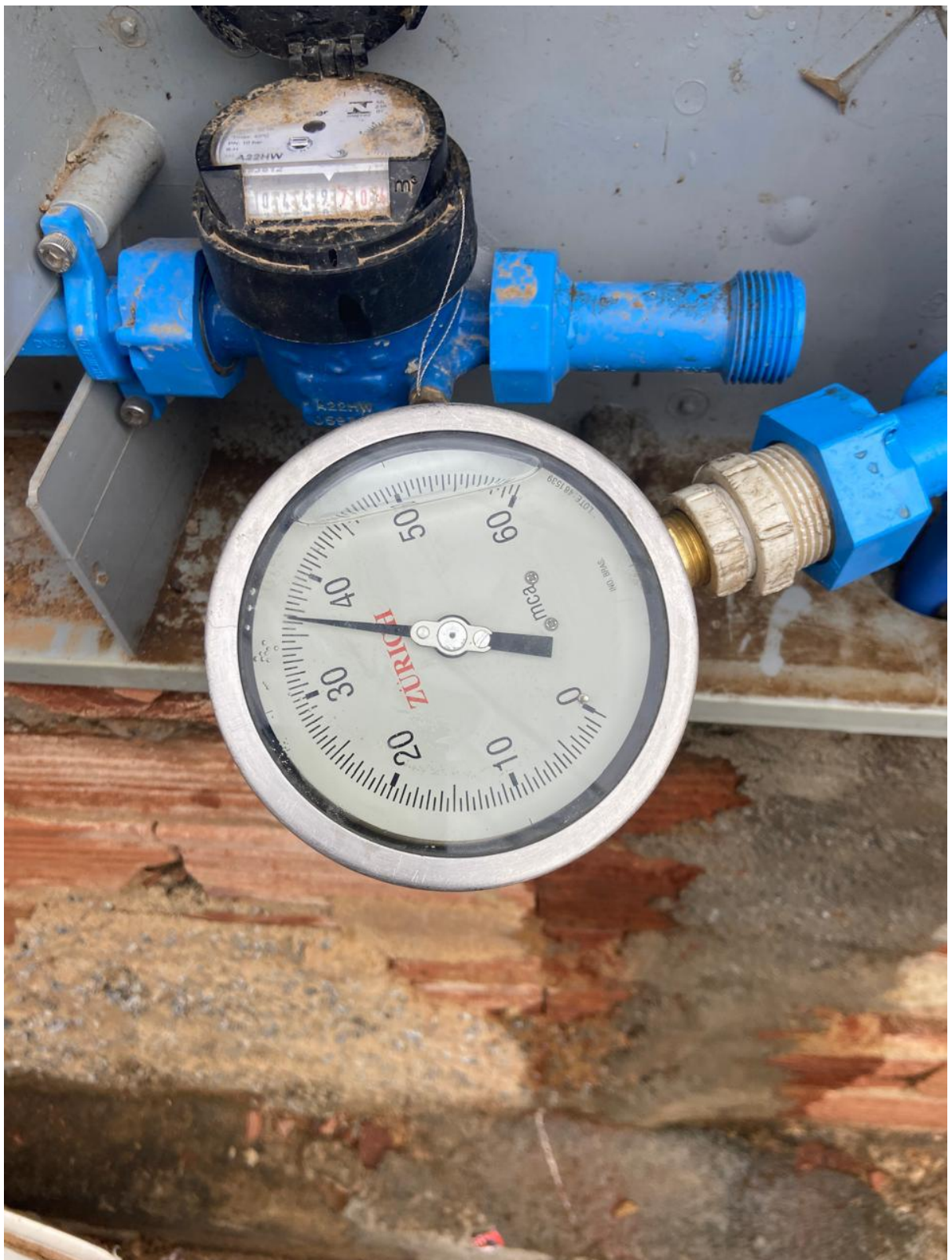
FOTO 04 – Abastecimento realizado diariamente e com boa pressão nos logradouros visitados.
