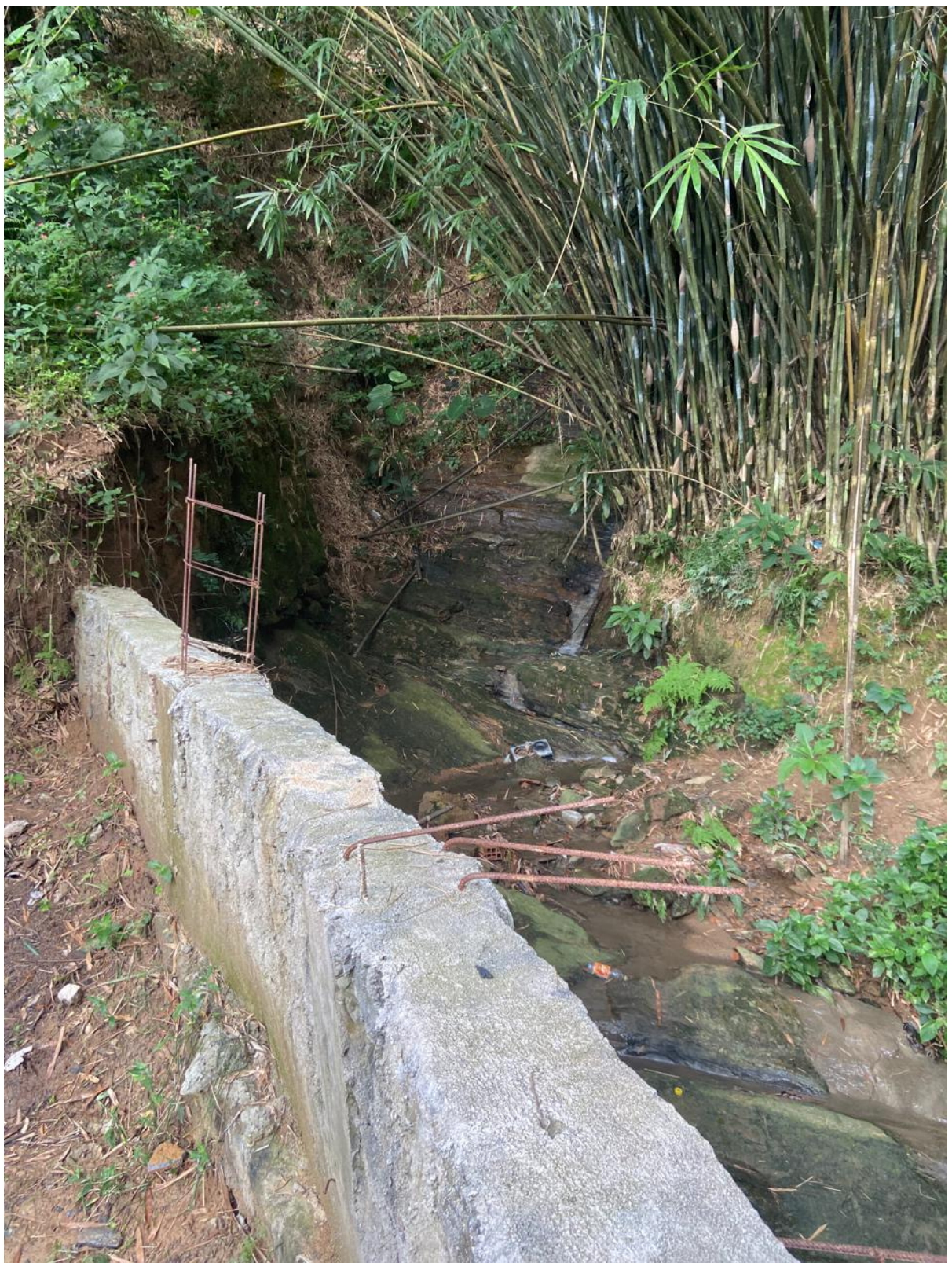
FOTO 05 – Esgoto in natura , chegando ao Rio Paraíba do Sul, através do Sistema de drenagem.
