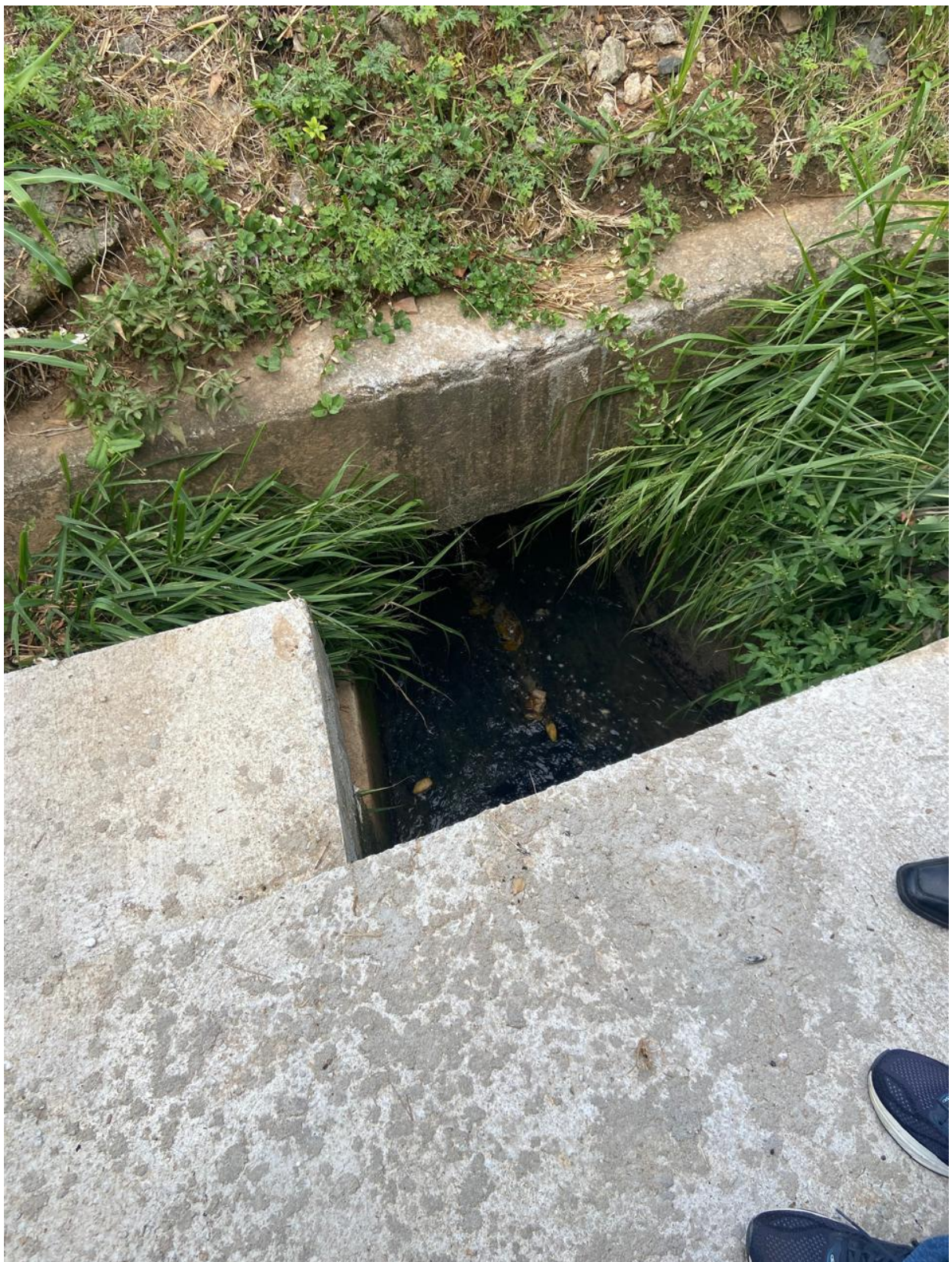
Foto 07 – Rua Izaura Barbosa, esgoto lançado no sistema de drenagem.
