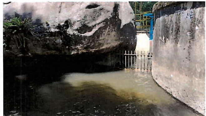
Foto 6: Entrada de água no sistema com gradeamento.
