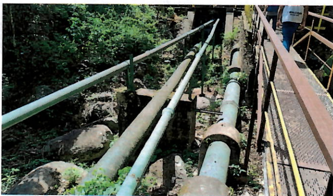
Foto 9: Adutoras de água bruta (ausência de vazamento aparente).
