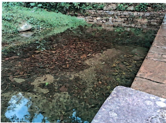
Foto 24: Acúmulo de sedimentos e M.O no poço.
