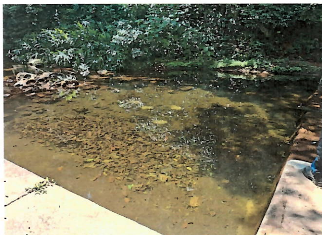
Foto 8: Acúmulo de sedimentos e matéria orgânica
