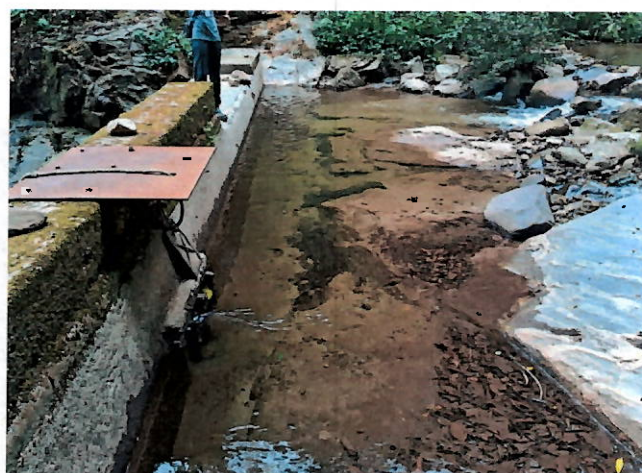
Foto 4: Acúmulo de sedimentos próximo a captação.
