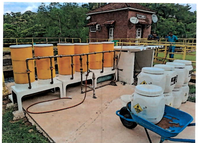
Foto 31: Sistema de desinfecção.
