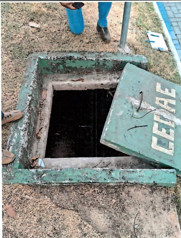
Foto 25: Acesso ao medidor.
