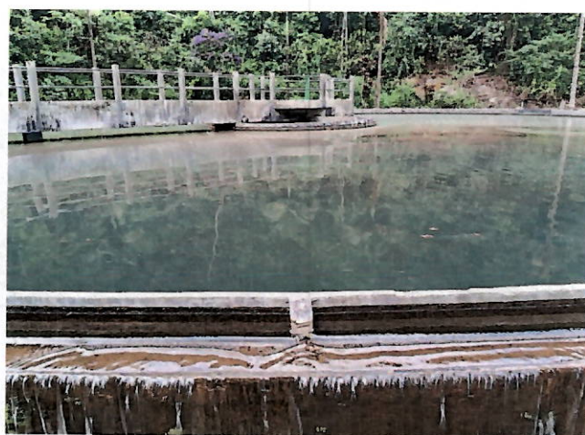
Foto 6: Vazão baixa no canal de coleta de água da estrutura.
