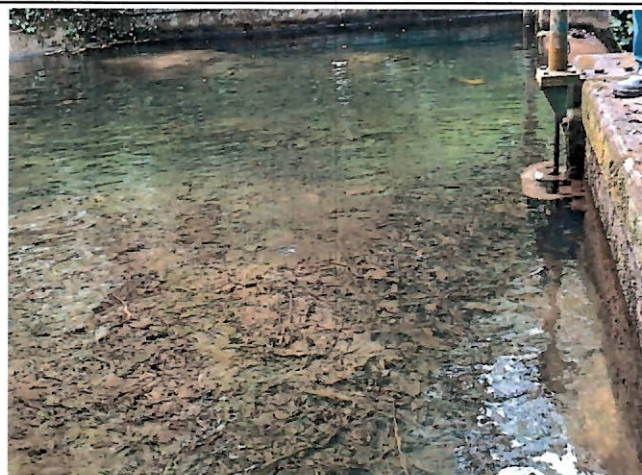
Foto 17: Acúmulo de sedimentos e matéria orgânica próximos a captação.
