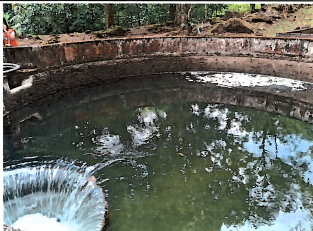
Foto 15: Caixa de areia com baixo nível de água.
