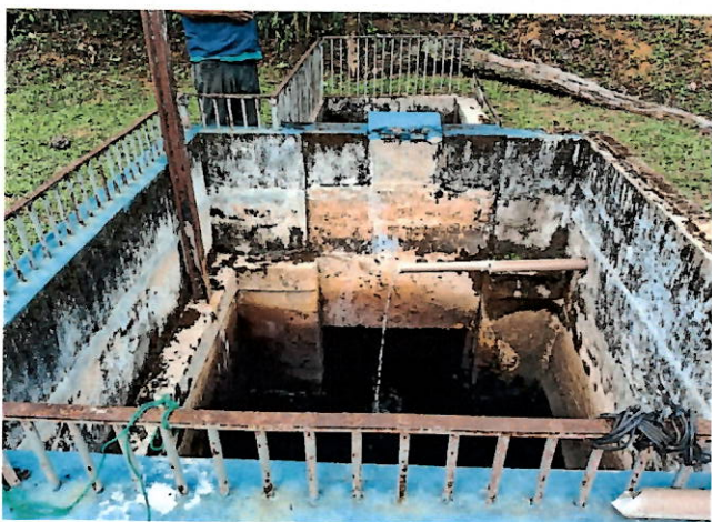
Foto 7: Tanque de cloração.
