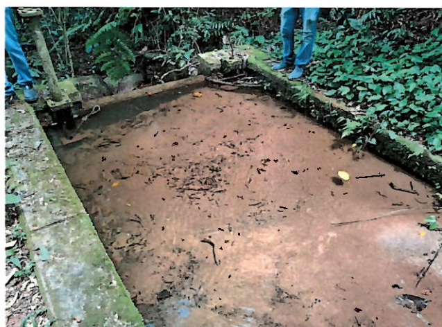
Foto 22: Acúmulo de sedimentos
