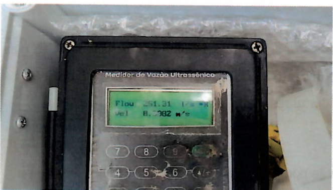
Foto 27: Medidor Ultrassônico (251 L/s).
