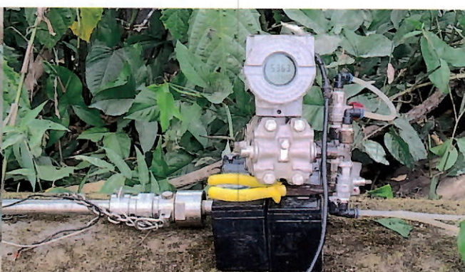
Foto 26: Pitot Diferencial - Pressão medida de 53 mmH 2 O (equivalente a 524 L/s – conversão realizada pelos técnicos da concessionária).
