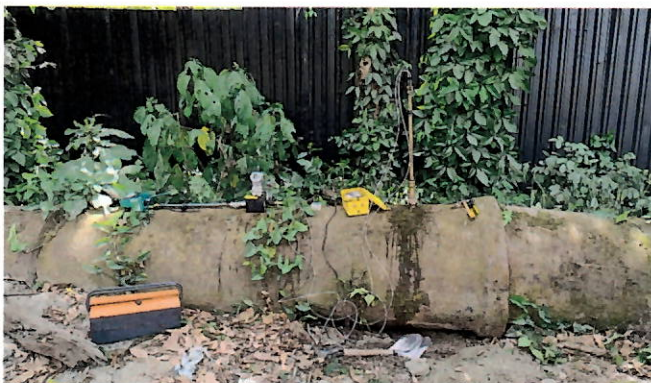
Foto 23: Ponto de medição de vazão (Pitot Diferencial e Eletromagnético).
