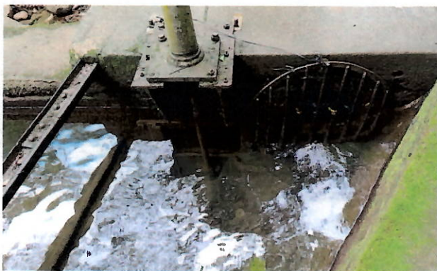
Foto 17: Entrada de água no sistema.
