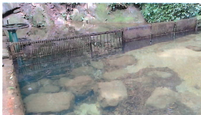
Foto 5: Entrada de água no sistema.
