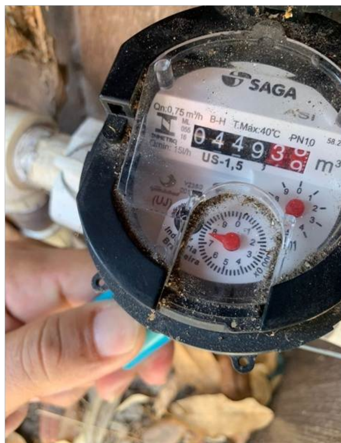
Foto 5 – Leitura do hidrômetro
