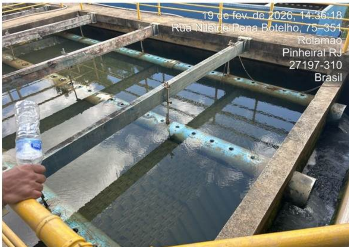
Foto 16 – Decantador lamelar de concreto armado
