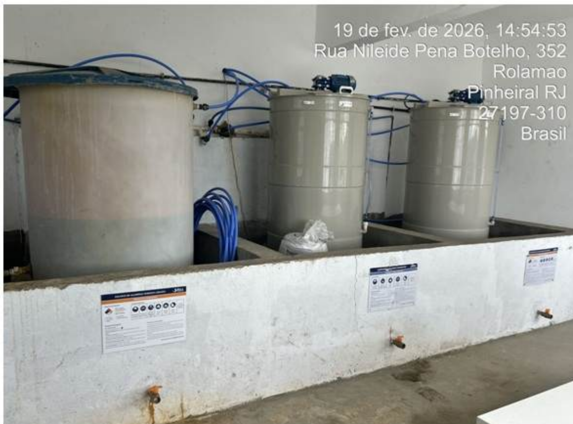
Foto 20 – Tanques de acondicionamento de produtos químicos
