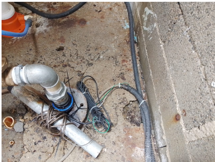
Foto 8 – Fios no chão do abrigo
