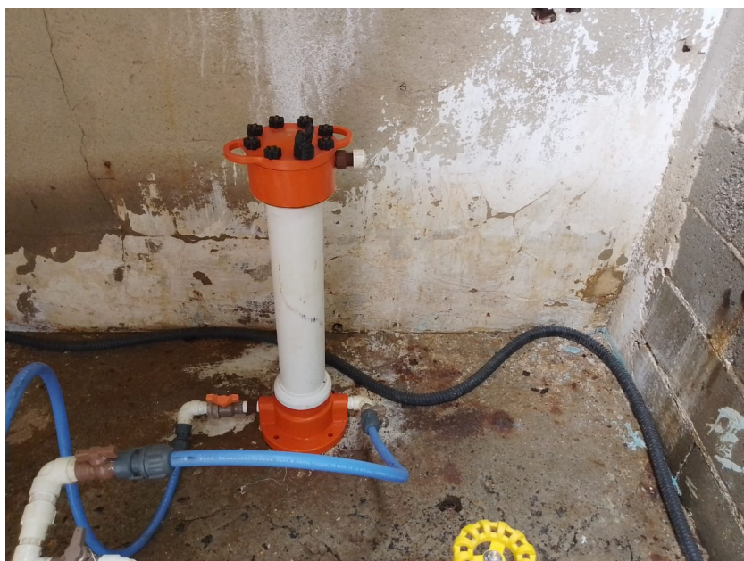
Foto 11 – Torre de cloro
