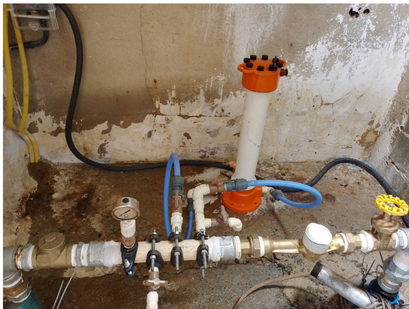
Foto 10 – Hidrômetro e torre de cloro
