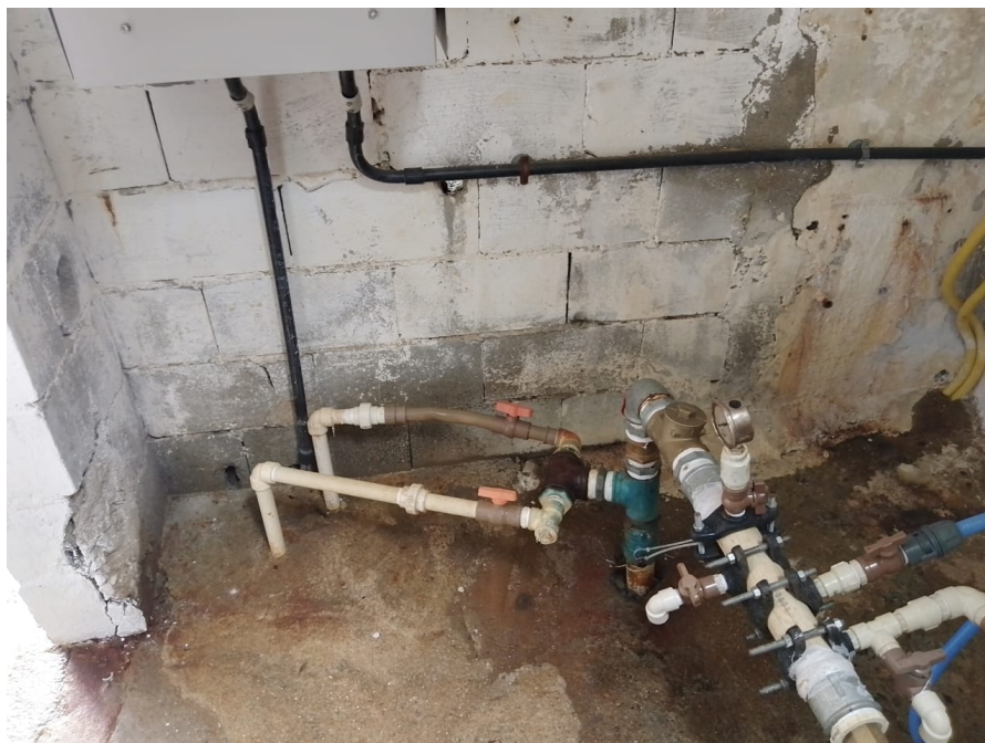
Foto 14 – Duas tubulações de DN ¾"
