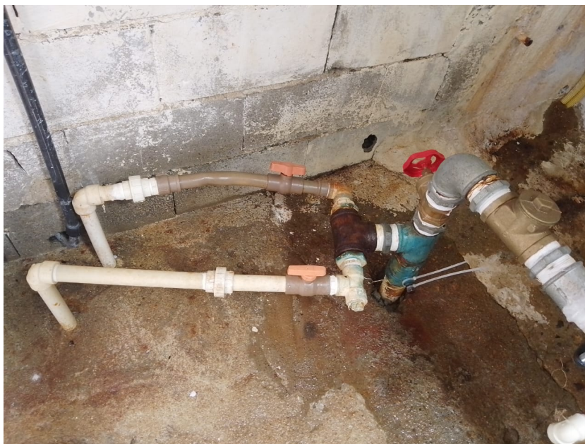
Foto 13 – Duas tubulações de DN ¾"
