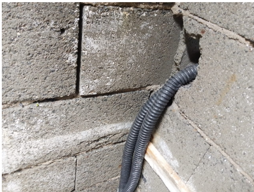
Foto 6 – Paredes sem emboço com conduites instalados inadequadamente
