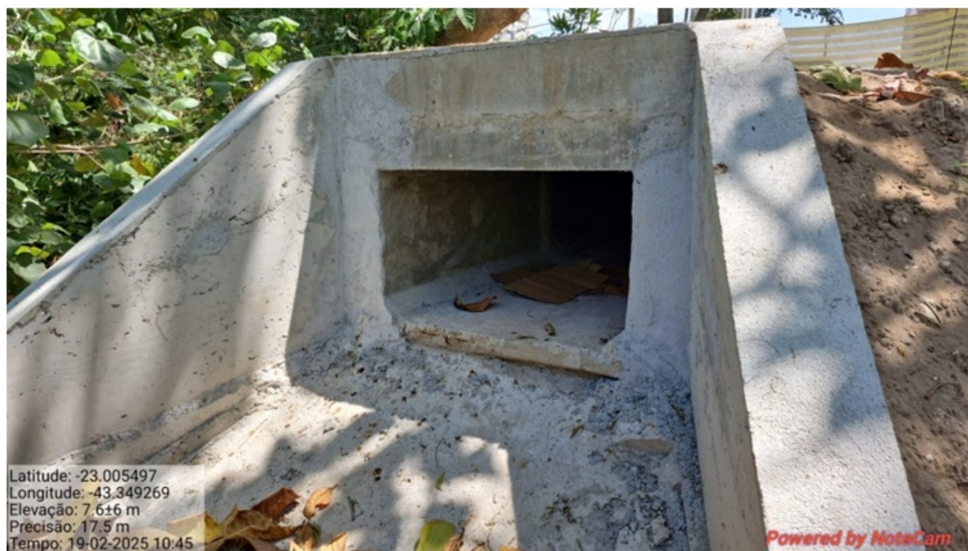
Foto 02 – Ponto de lançamento da GAP, próximo ao nº 2900
