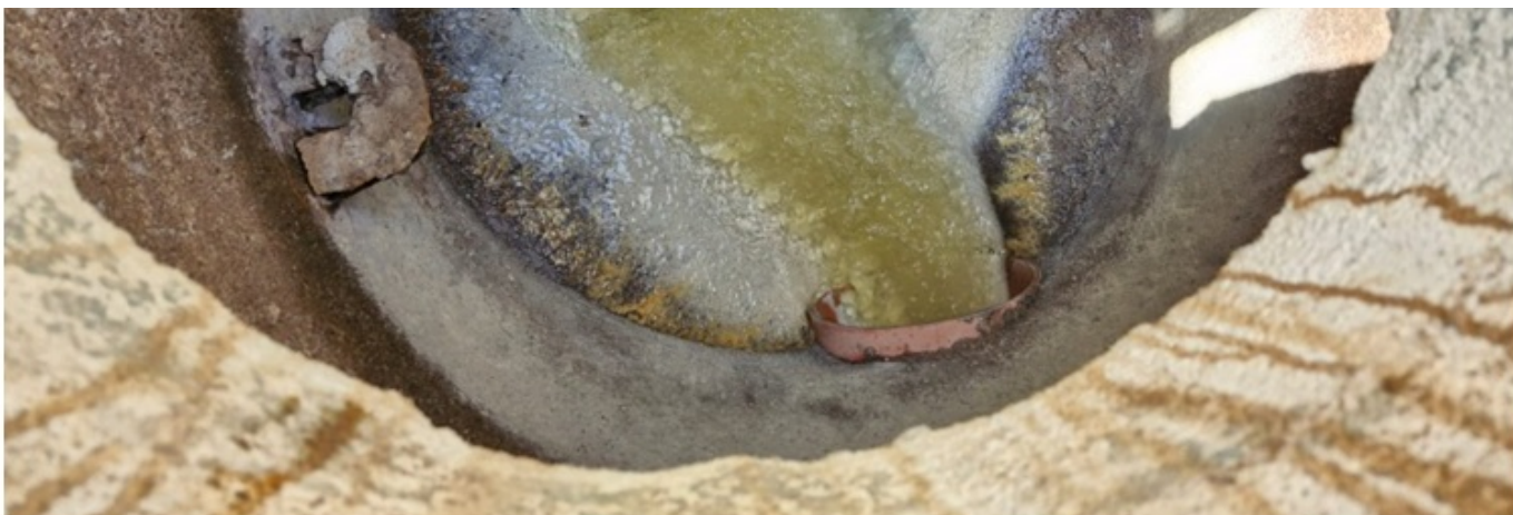
Foto 04 – PV de ligação do empreendimento
