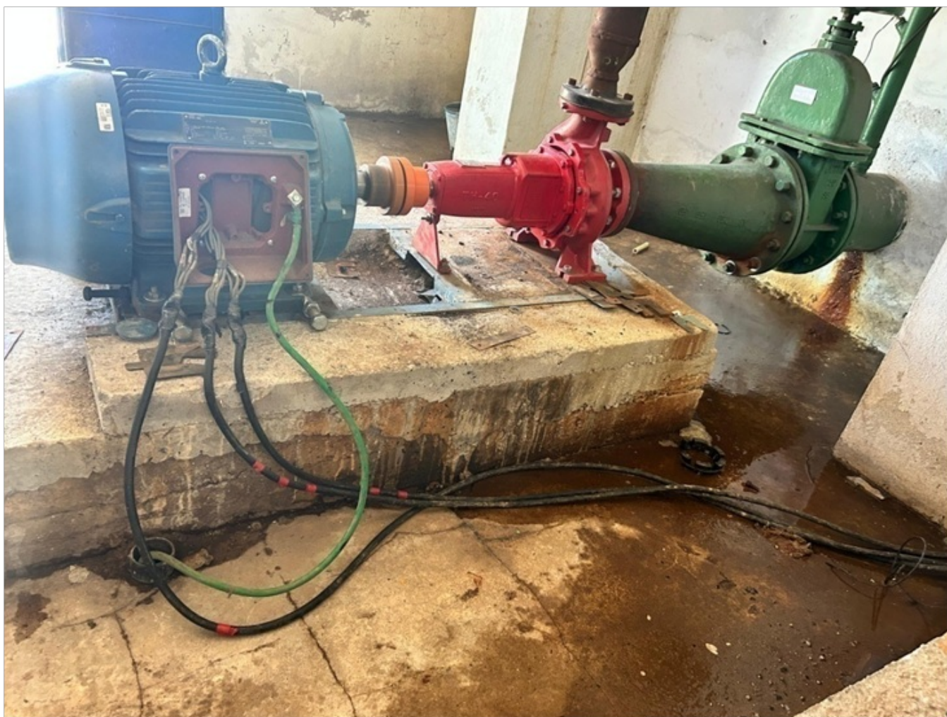
Foto 8 - Fiação disposta de forma desorganizada e em contato com a água presente no chão da unidade
