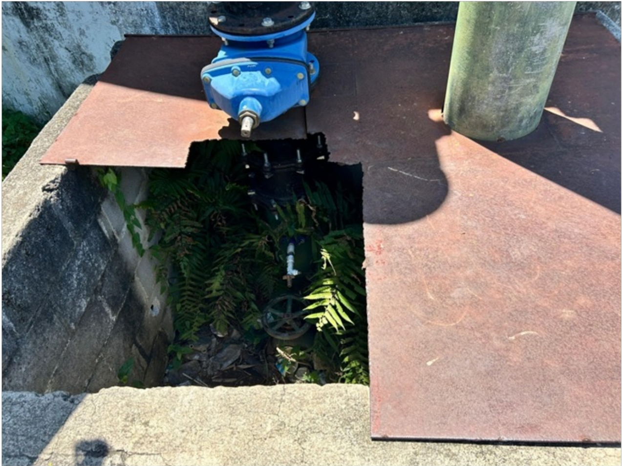
Foto 15 - Caixa de inspeção do barrilete
