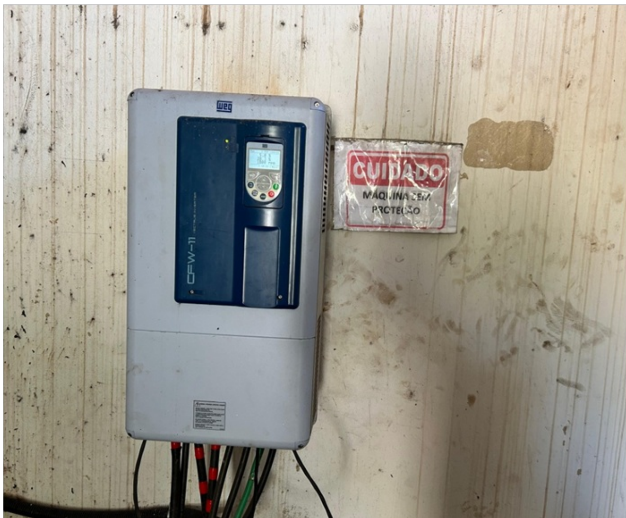
Foto 11 - Inversor de frequência
