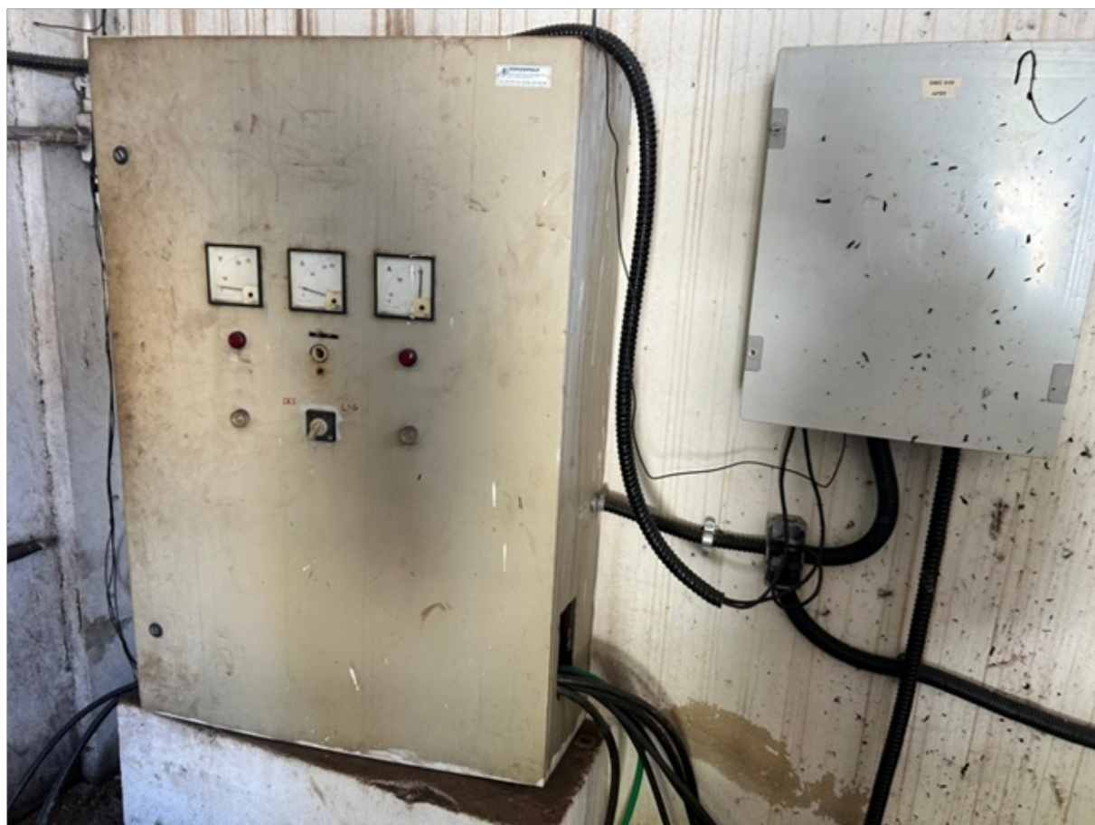
9 - Abrigo do painel de automação sem sinalização de perigo
