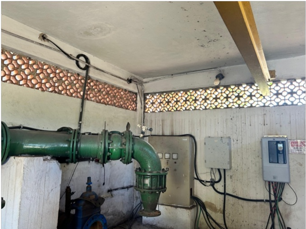
Foto 12 - Localização dos cobogós e iluminação artificial que não funciona
