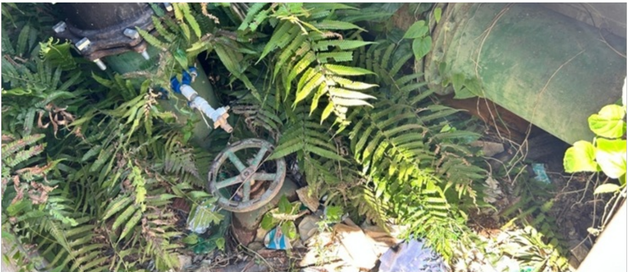
Foto 16 - Vista interna da caixa de inspeção do barrilete com presença de bastante vegetação e lixo
