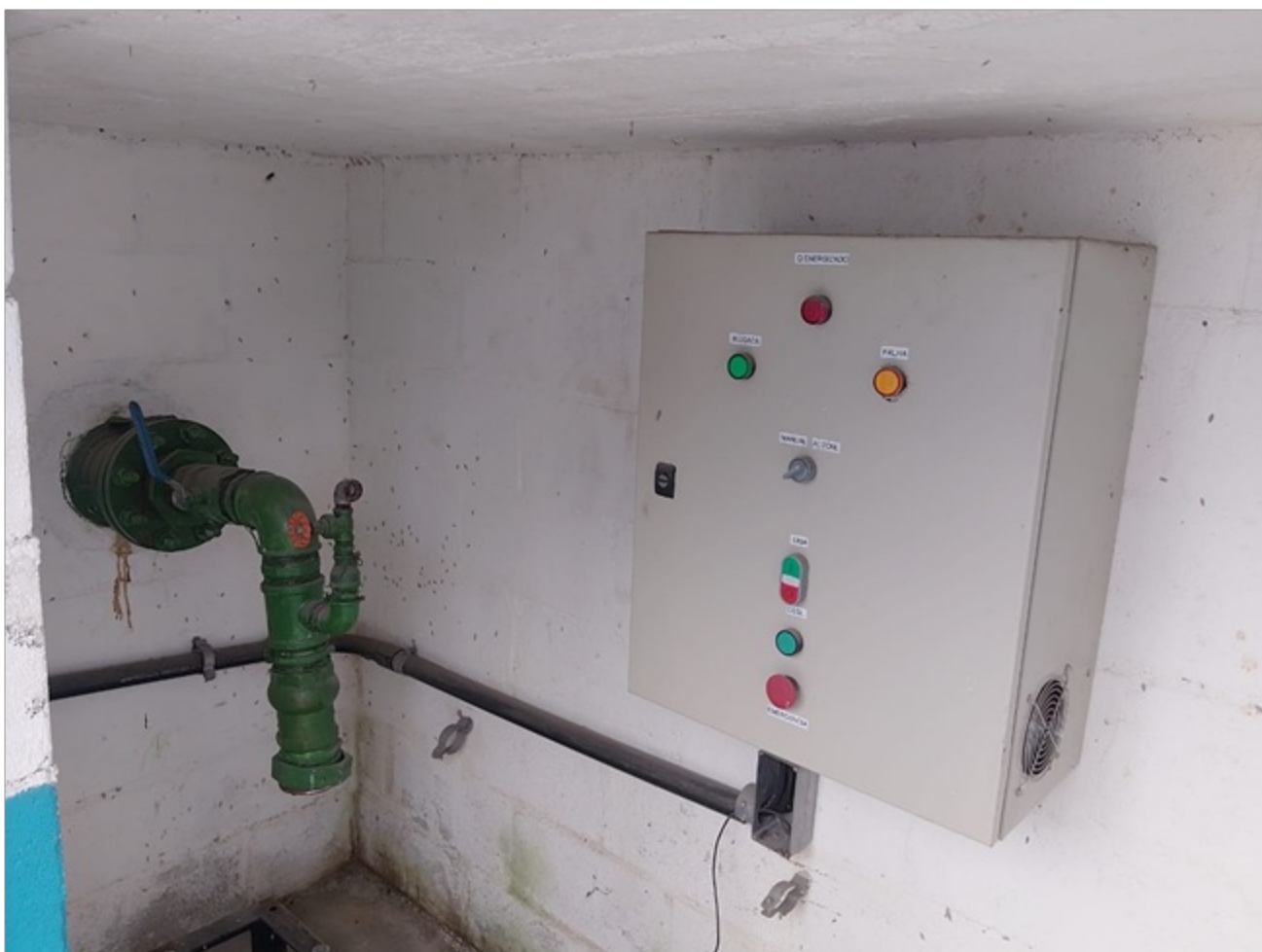
Foto 6 – Tubulação de recalque
