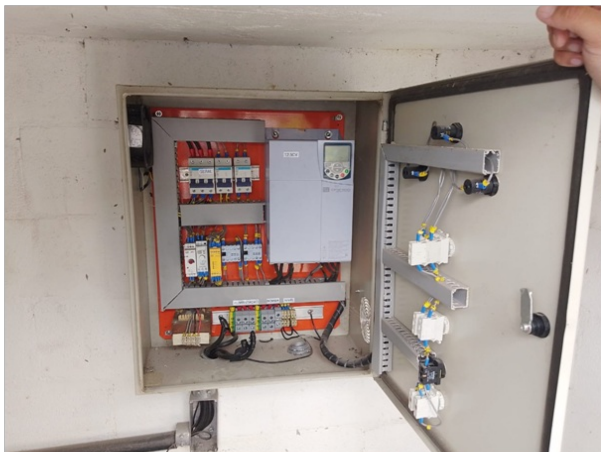
Foto 9 – Painelelétrico da elevatória aberto
