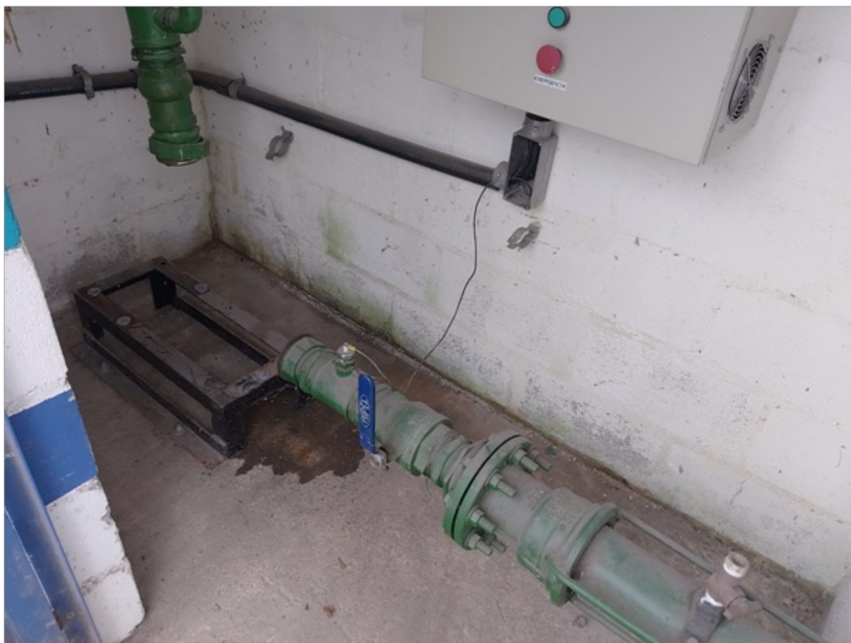
Foto 10 – Conjunto motobomba retirado
