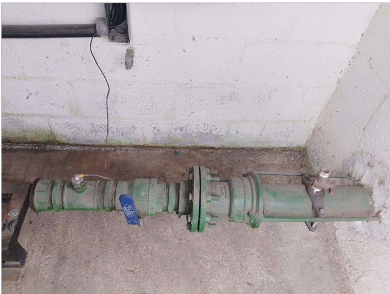
Foto 5 – Tubulação de retaguarda (sucção)
