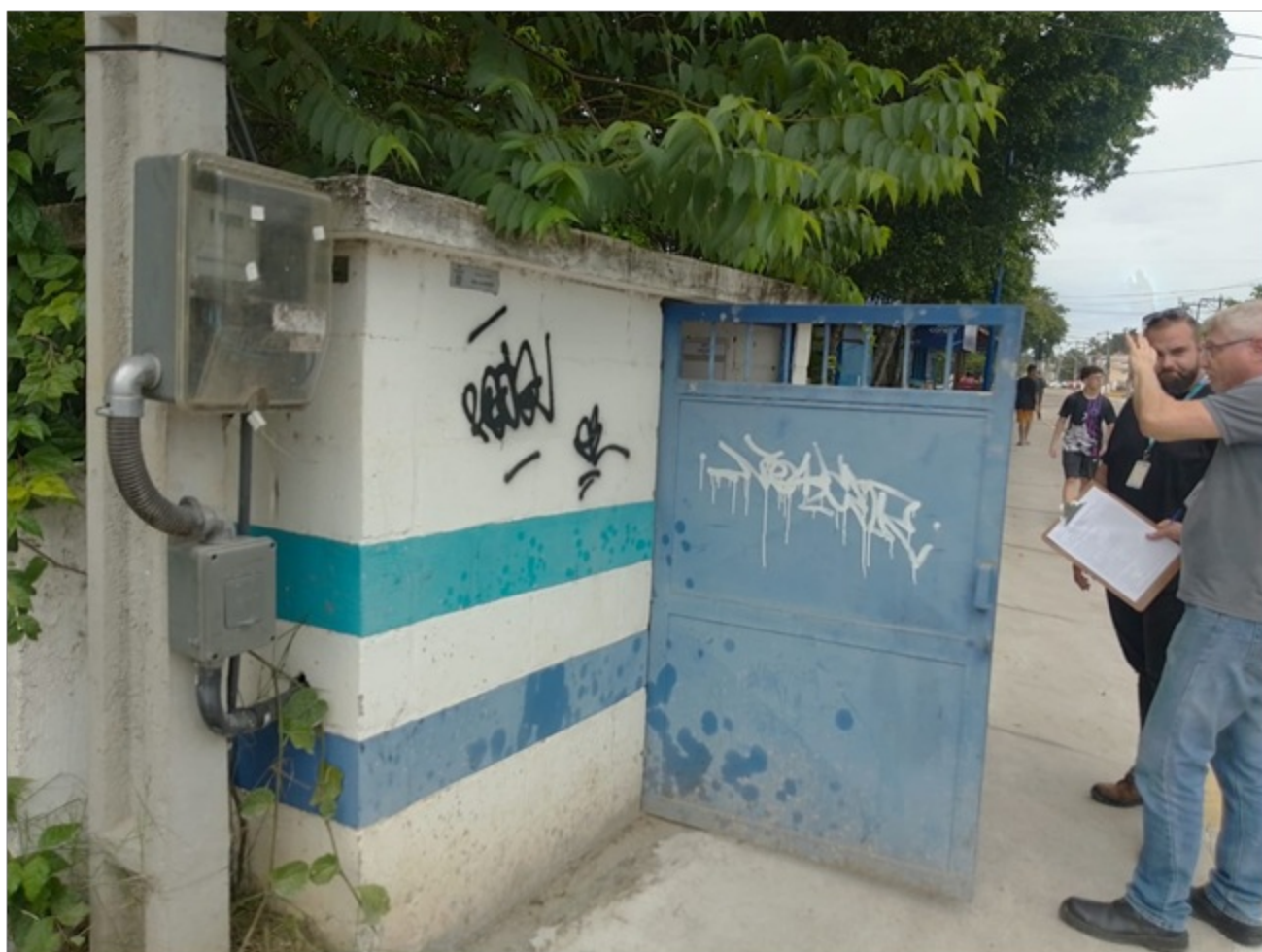
Foto 1 – EEAT localizada no passeio público e sem identificação
