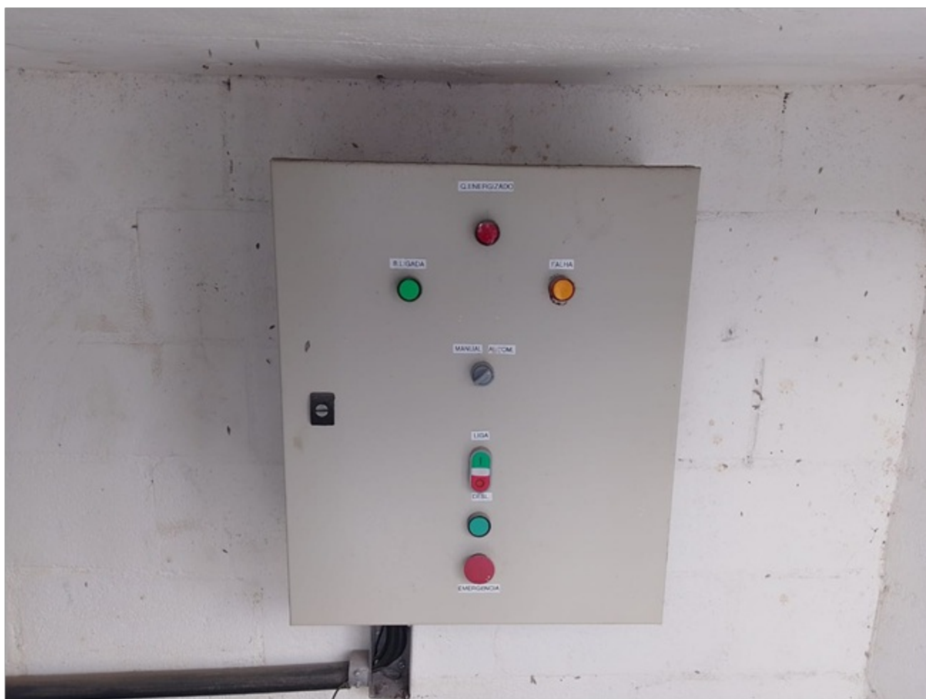
Foto 8 – Painelelétrico da elevatória
