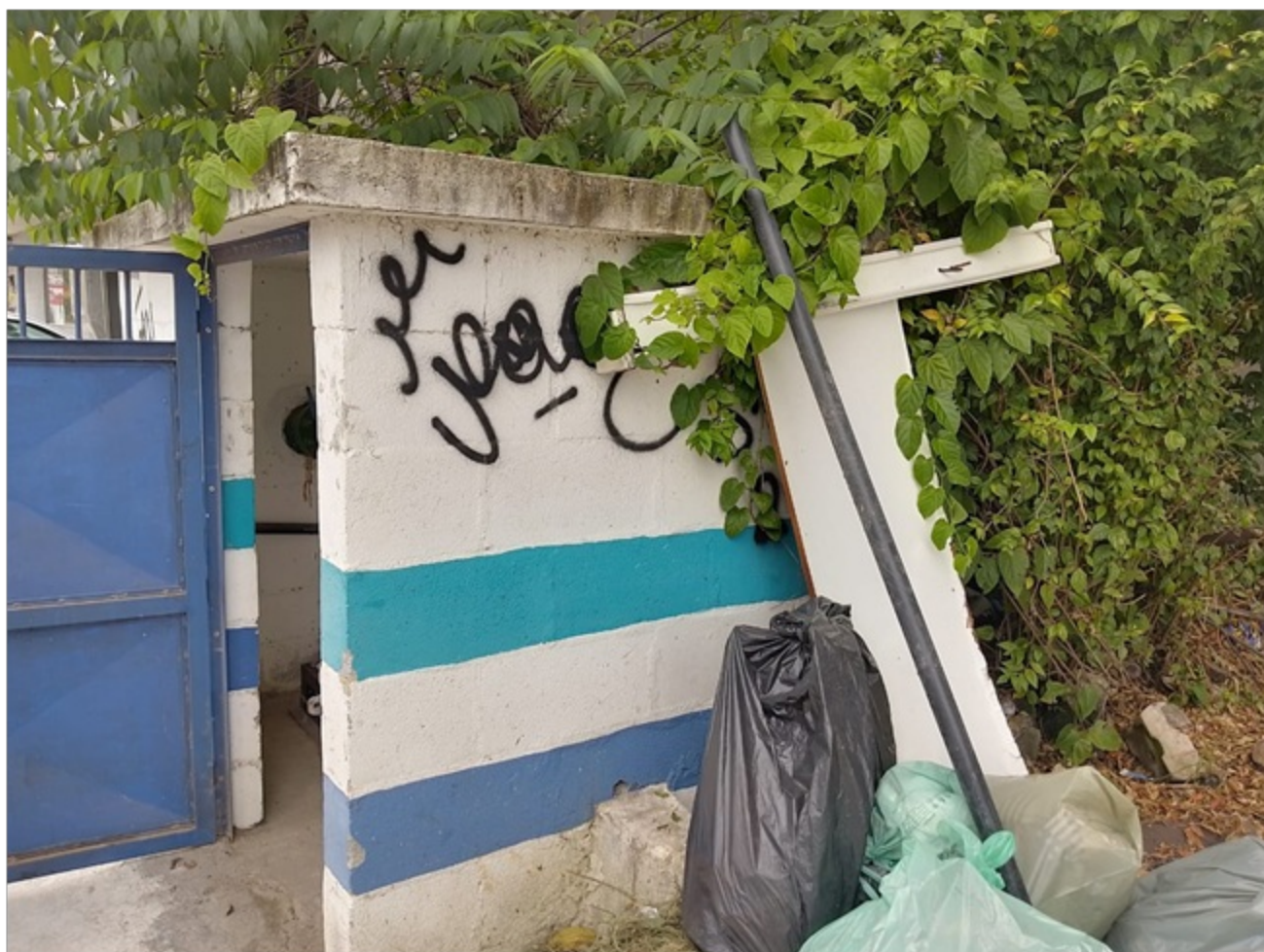
Foto 2 – EEAT sem identificação
