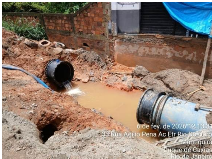
Foto 17 – Trecho da adutora que rompeu
