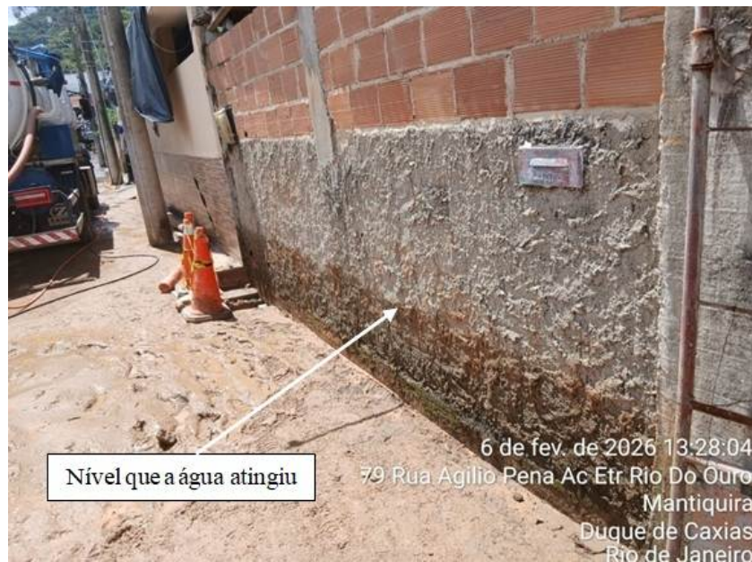
Foto 7 – Nível atingido pela água
