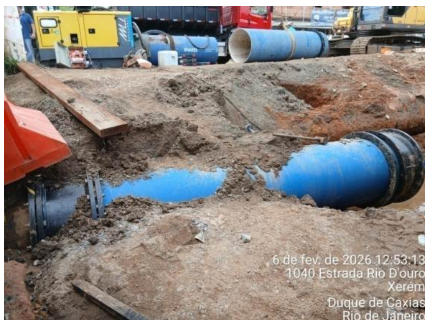
Foto 18 – Trecho da adutora que rompeu anteriormente
