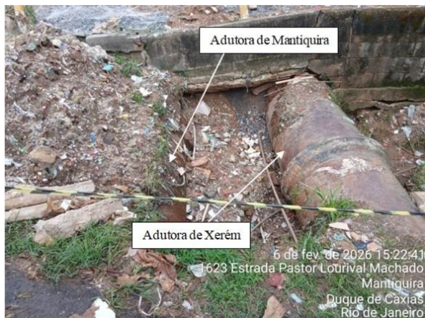
Foto 20 – Adutora de Xerém ao lado da Adutora de Mantiquira
