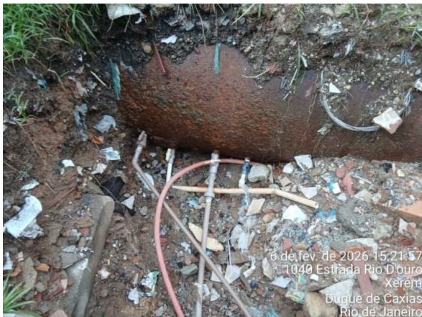
Foto 22 – Ligações não oficiais na Adutora de Mantiquira
