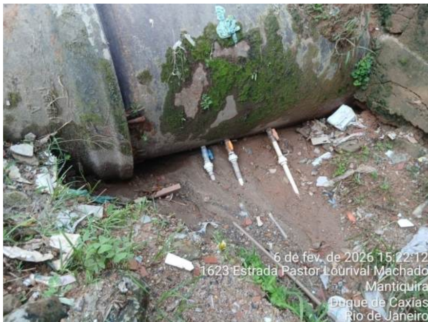
Foto 21 – Ligações não oficiais na Adutora de Xerém
