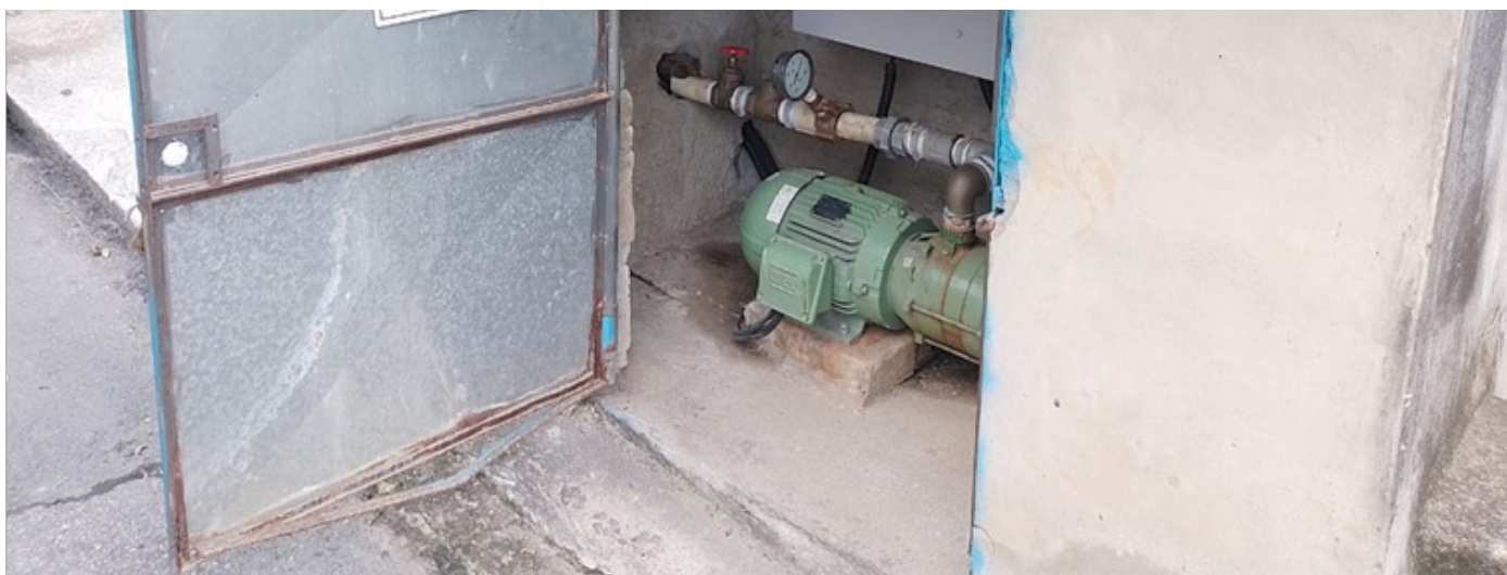
Foto 4 – Inexistência de sinalização de risco de choque elétrico
