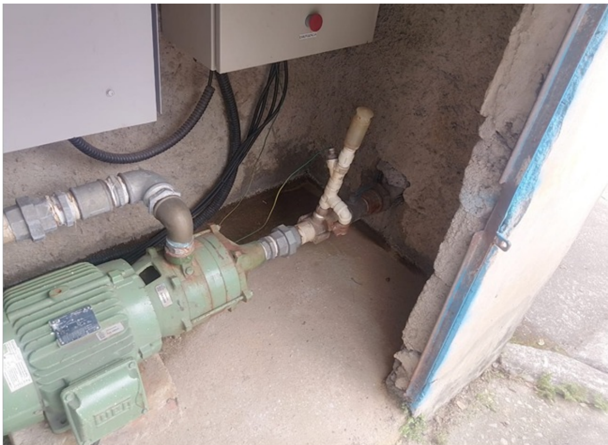
Foto 9 – Fiação do conjunto motobomba
