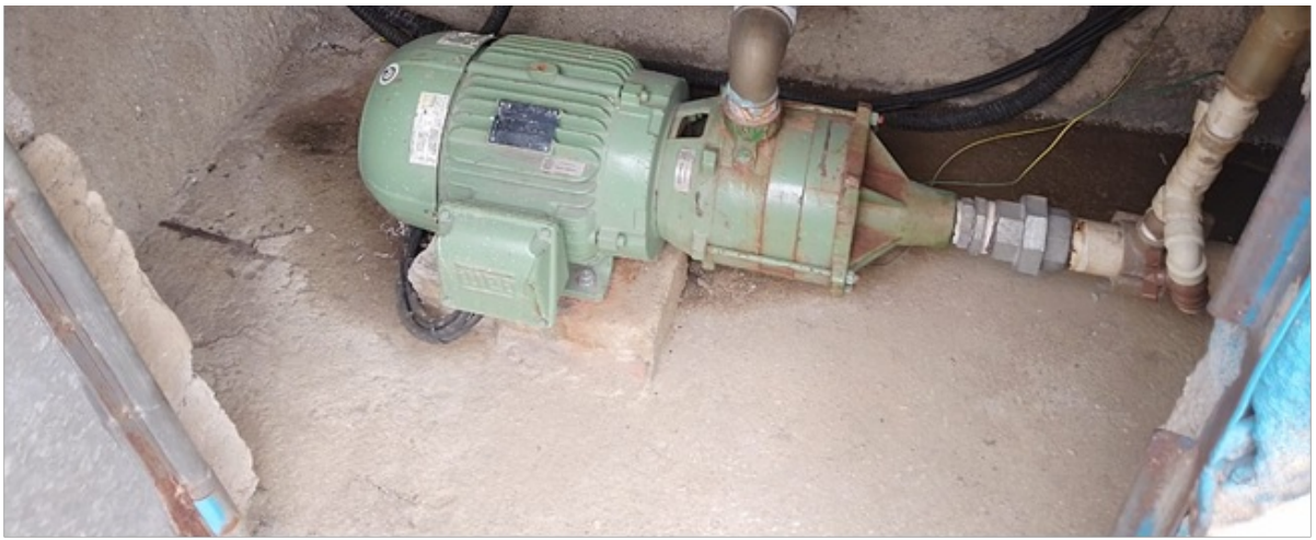
Foto 12 – Conjunto motobomba e tubulações de recalque (com válvula de retenção) e retaguarda
