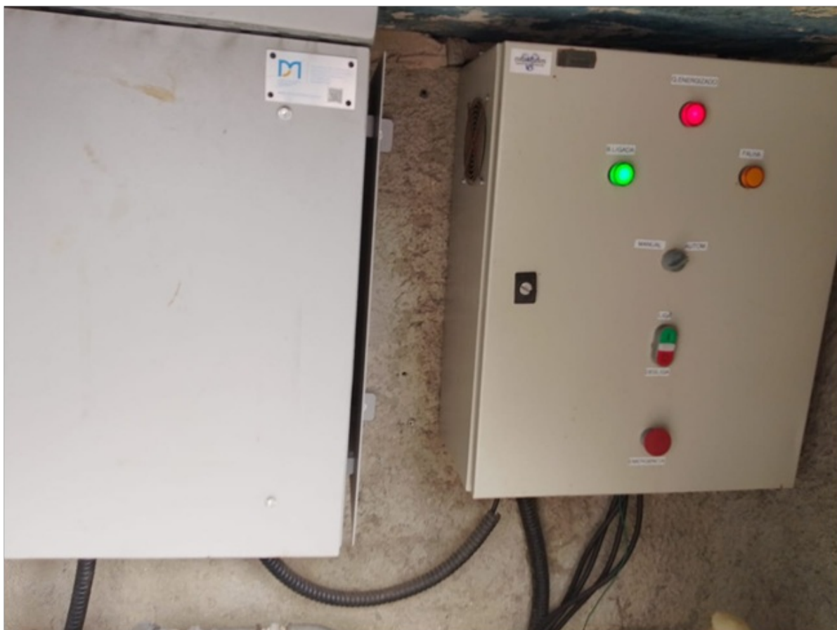
Foto 8 – Painel do conjunto motobomba
