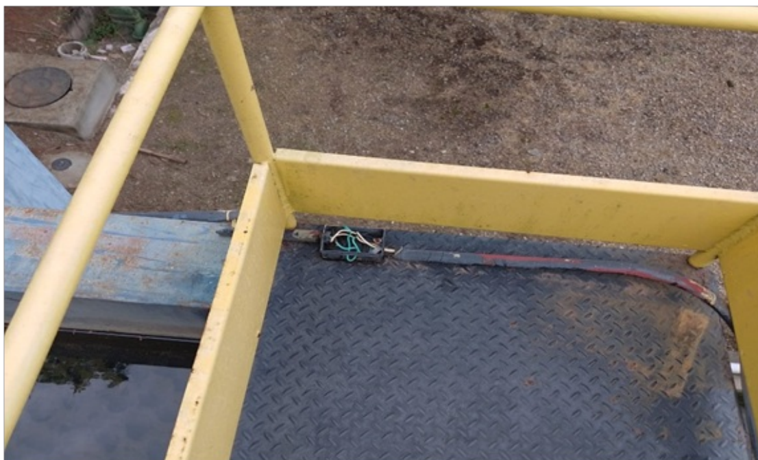
Foto 16 - Instalação elétrica inadequada (NBR 5410:2004/ABNT;
