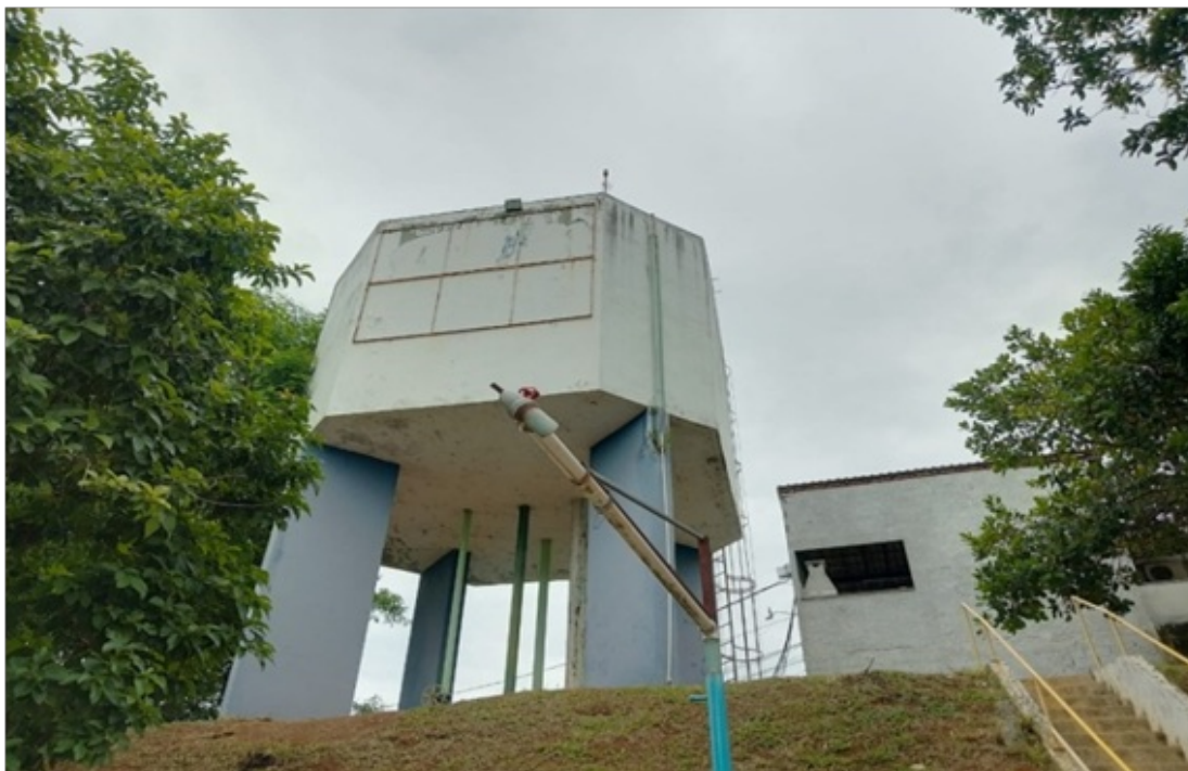
Foto 15 – Reservatório com capacidade de 500 m 3 para lavagem dos filtros e abatecimento da ETA
