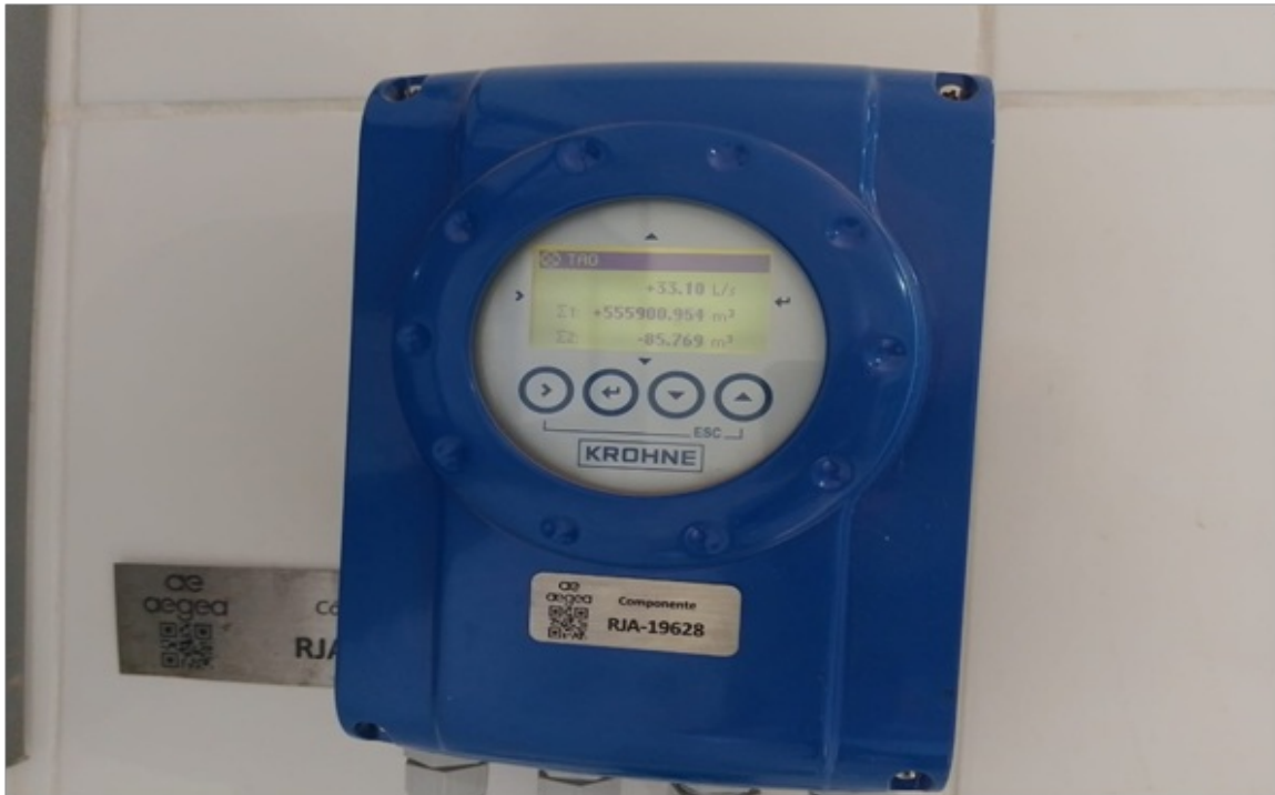
Foto 9- Medidor de Vazão Eletromagnético
