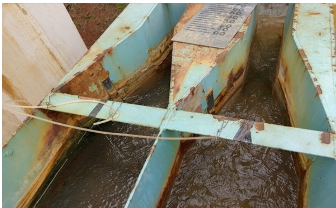
Foto 3 – Calha Parshall e aplicação de agente coagulante
