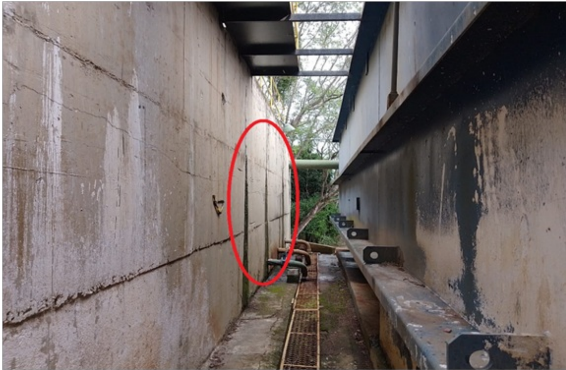
Foto 17 - Existência de vazamentos aparentes (Art. 2º da Lei Federal 11.445/2007; NBR 12218:2004; Resolução nº 396/2008 da ANVISA)
