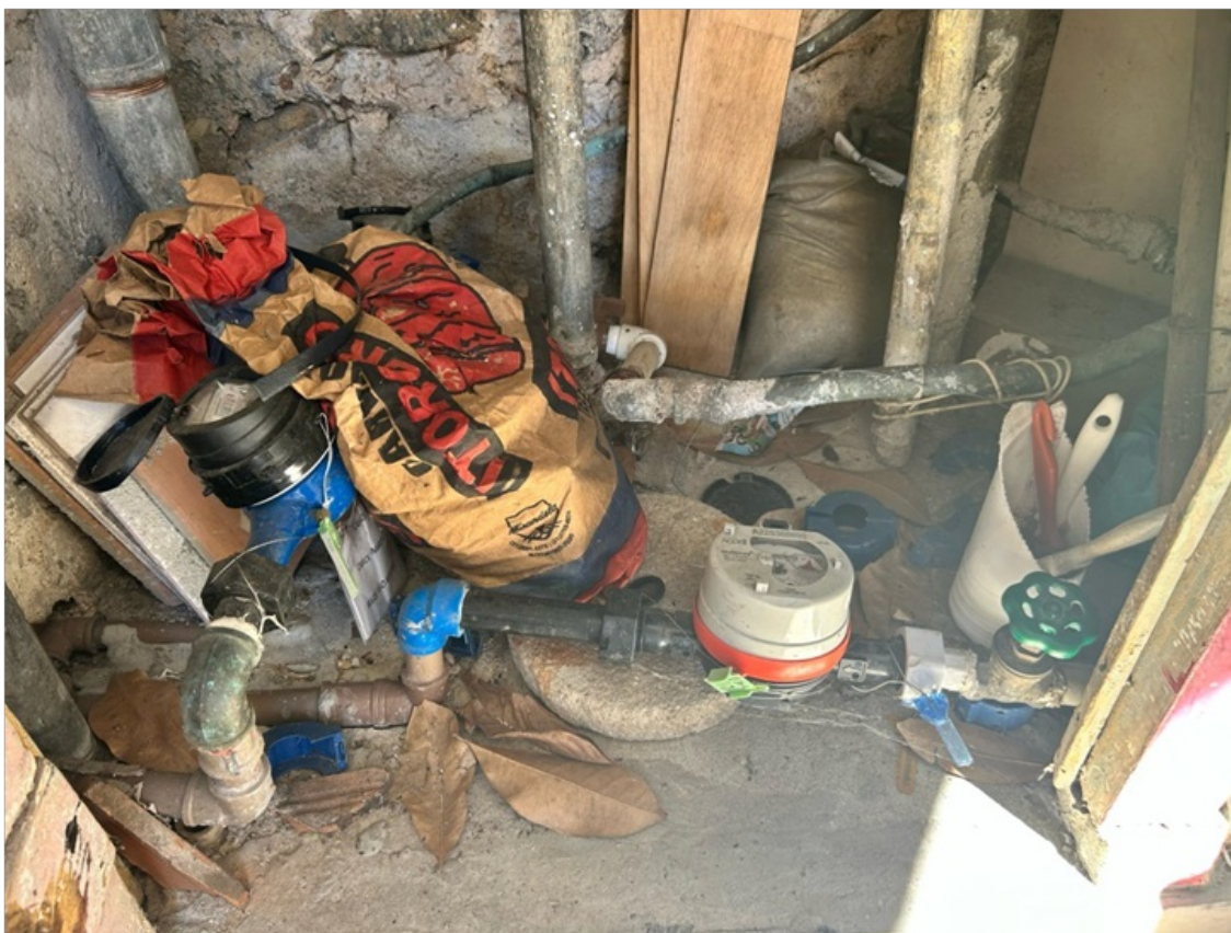
Foto 2 - Localização do hidrômetro no interior do imóvel
