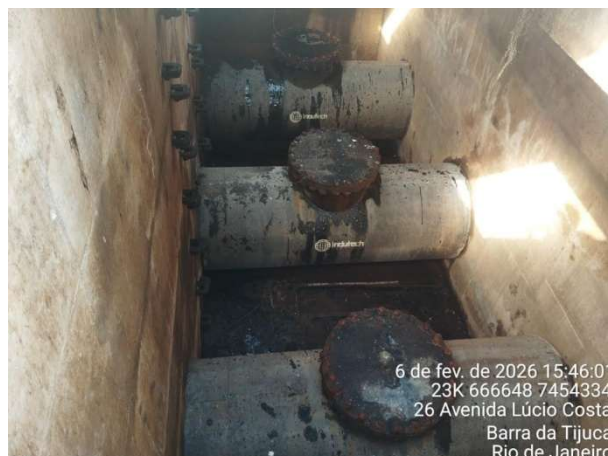
Figura 8: Interior da caixa de transição à jusante da travessia na Lagoa de Marapendi.
