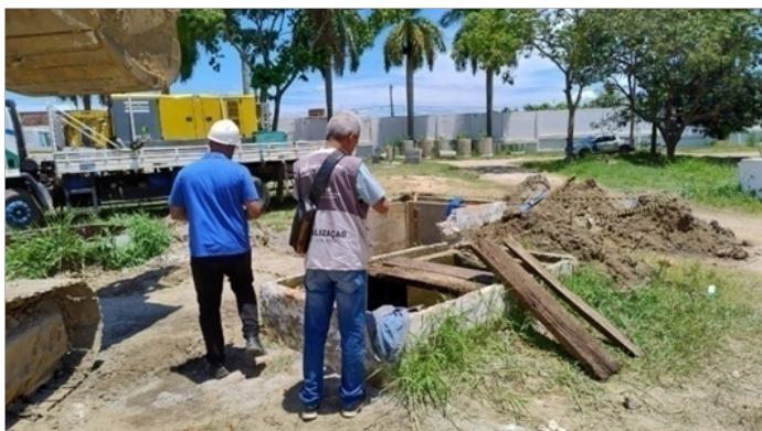
Foto 1: Localização do poço de visita, local onde foi detectado o vazamento.
