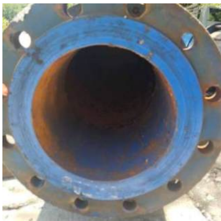
Figura 14: Situação do interior de uma das ventosas quadrifunção retiradas da caixa de transição de montante.
