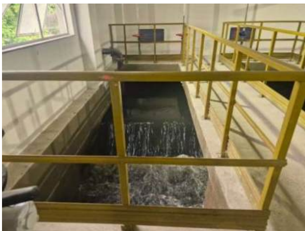
Figura 38: Tanque de chegada da ETE em funcionamento.
