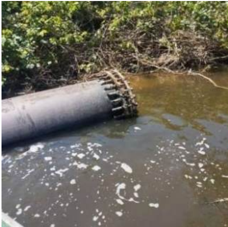
Figura 5: Trecho da tubulação aparente que se desconectou da caixa de transição à jusante (ponta com flange desconectado).
