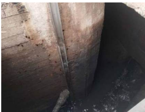
Figura 33: Entrada dos esgotos na EE Jardim Oceânico na calha, sem extravasar.
