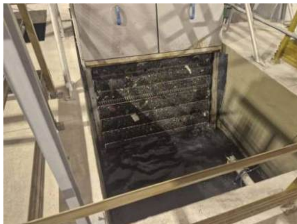
Figura 41: Gradeamento do canal 2 em funcionamento.
