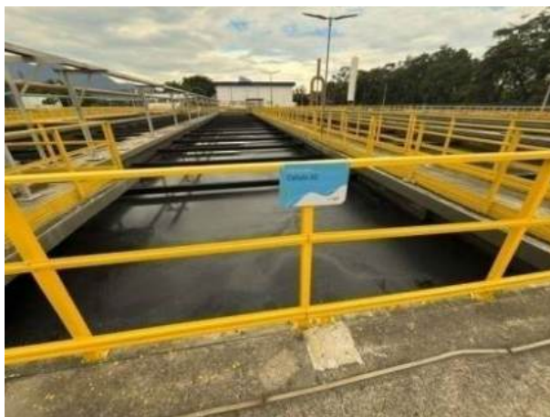
Figura 21: Decantador cheio porém sem operação no início do ligamento do sistema.
