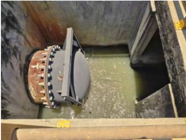
Figura 16: Extravasador da elevatória Marapendi com esgoto bruto sendo lançado ao corpo hídrico.
