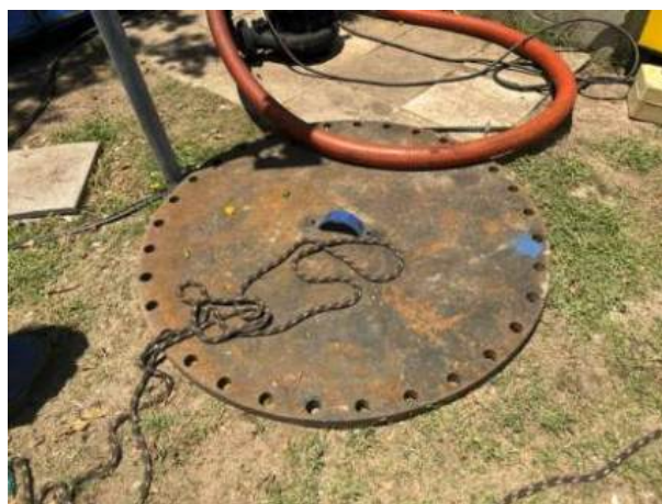
Figura 11: Flange que será colocado no lugar do suposto flange danificado.
