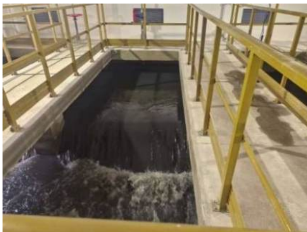
Figura 39: Tanque de chegada da ETE em funcionamento.
