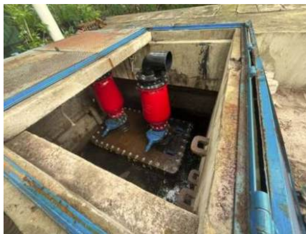
Figura 30: Ventosas novas recém instaladas na caixa à montante da travessia na Lagoa de Marapendi.
