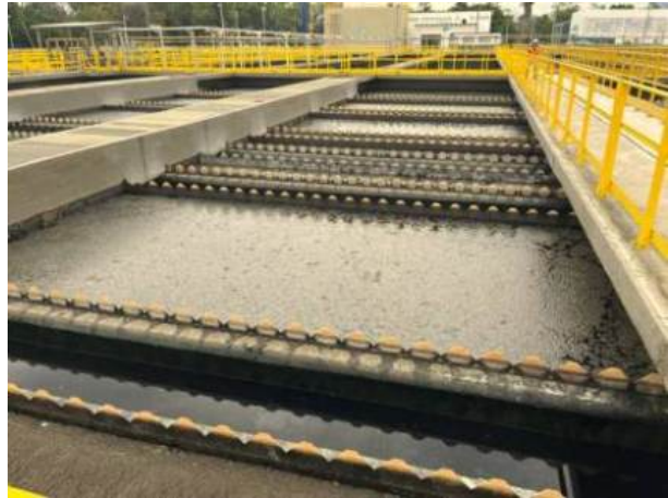
Figura 23: Decantador cheio porém sem operação no início do ligamento do sistema.
