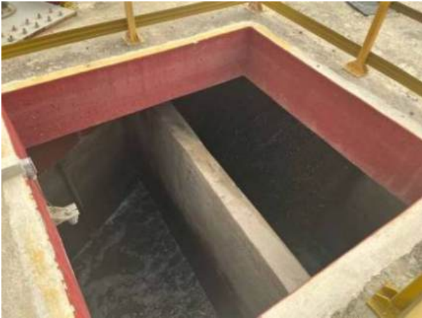
Figura 44: Poço de Sucção da Estação Elevatória final em funcionamento.
