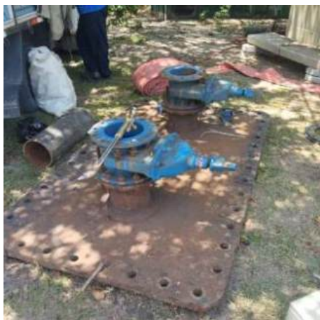
Figura 12: Tampa da caixa de transição pressurizada com registros.
