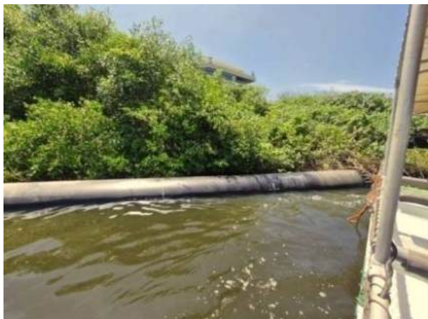
Figura 4: Trecho da tubulação aparente que se desconectou da caixa de transição à jusante.
