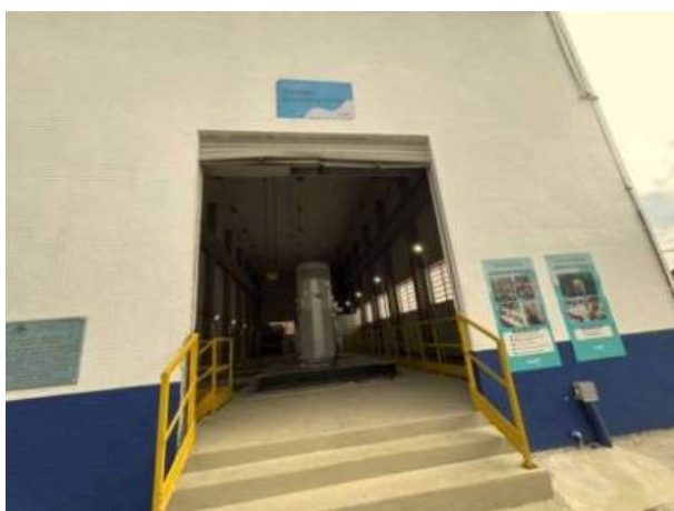
Figura 42: Estação Elevatória final em funcionamento.
