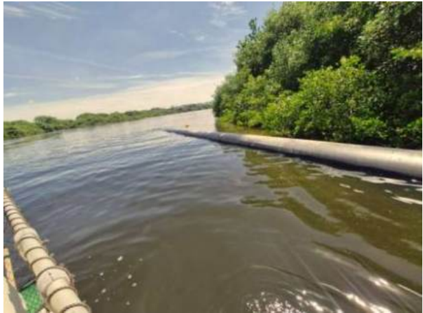
Figura 6: Trecho da tubulação aparente que se desconectou da caixa de transição à jusante.
