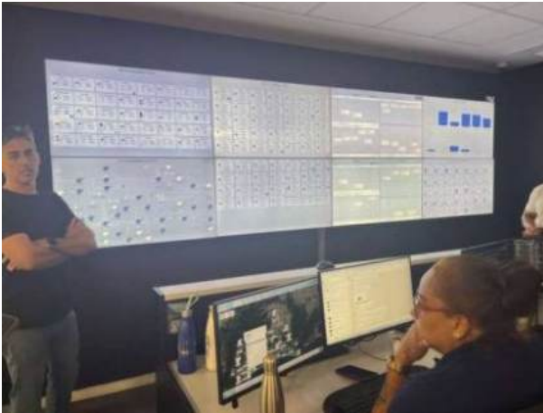
Figura 47: Centro de Controle Operacional (CCO) da Concessionária Iguá.
