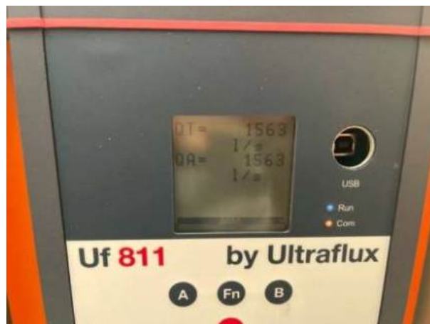
Figura 46: Medidor de vazão medindo 1563 L/s na saída da estação.
