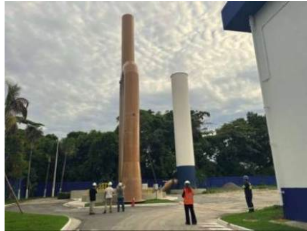
Figura 45: Chaminé de equilíbrio após o recalque da EE Final, onde está instalado o medidor de vazão provisório.
