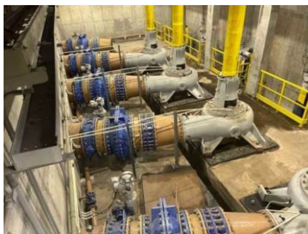
Figura 43: Estação Elevatória final em funcionamento.
