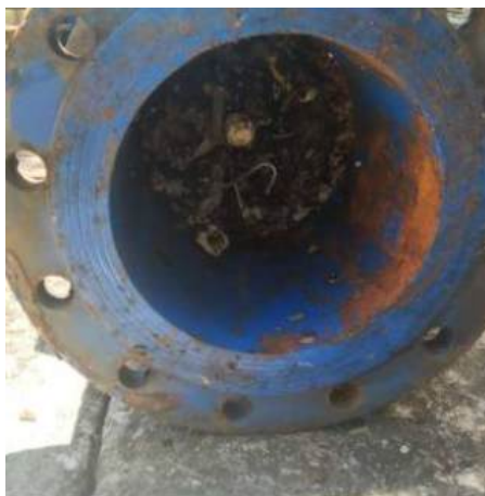
Figura 15: Situação do interior da outra ventosa quadrifunção retirada da caixa de transição de montante, totalmente obstruída com resíduos sólidos.
