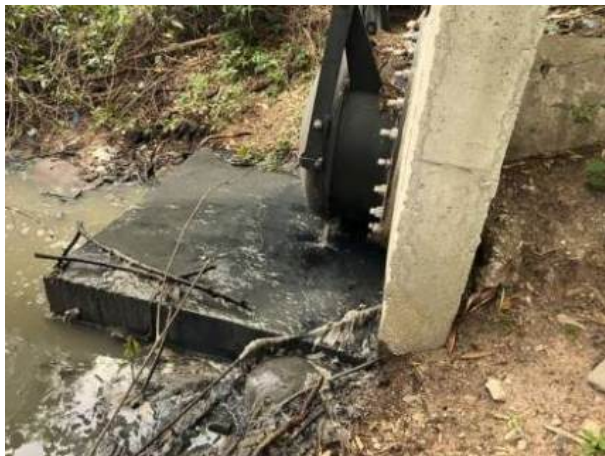
Figura 25: Extravasador da elevatória Lagoa da Tijuca em operação através da válvula Flap.
