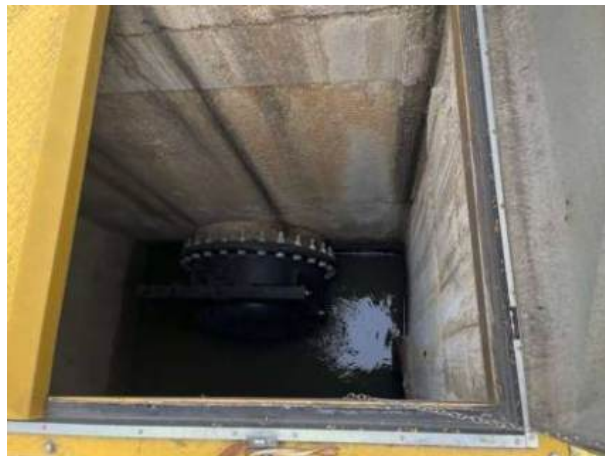
Figura 26: Extravasador da elevatória Península em operação através da válvula Flap.
