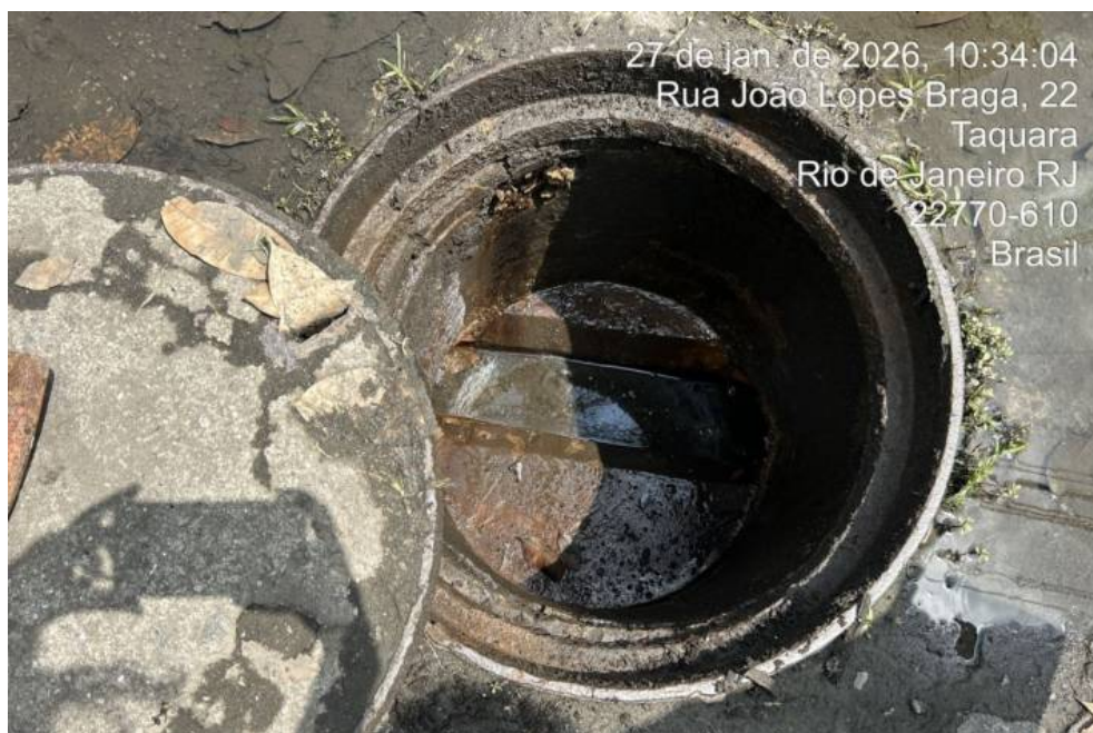
Foto 07 – Poço de visita da rede de esgotos a um terço da rua, sem fluxo
