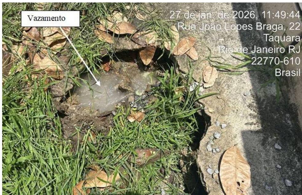
Foto 02 –Vazamento identificação na calçada do imóvel, nº 73
