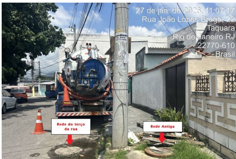
Foto 05 – Localização das redes de esgoto existentes no logradouro
