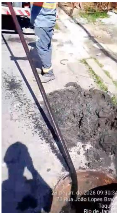
Foto 10 – Limpeza de um dos PVs da rede de esgotos a um terço da rua
