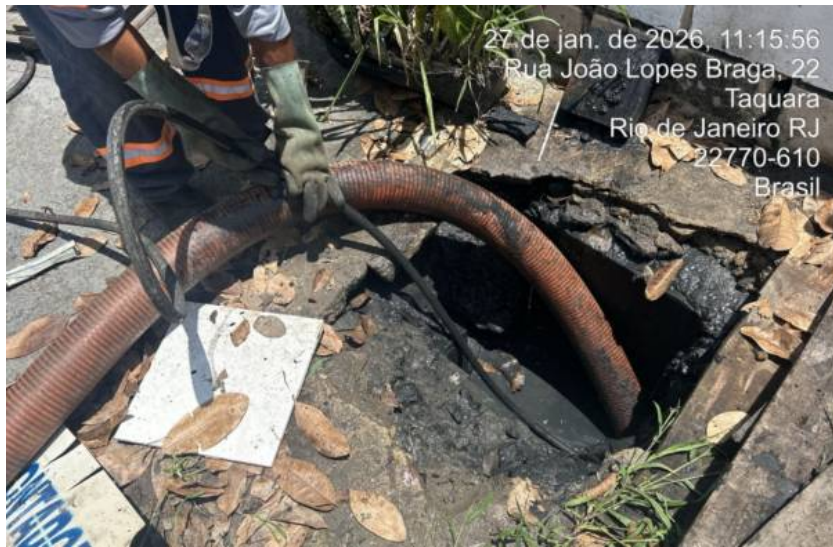
Foto 08 – Tentativa de desobstrução da caixa de inspeção
