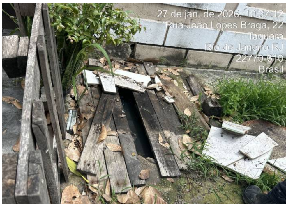
Foto 06 – Caixa de inspeção obstruída em frente ao imóvel nº 73
