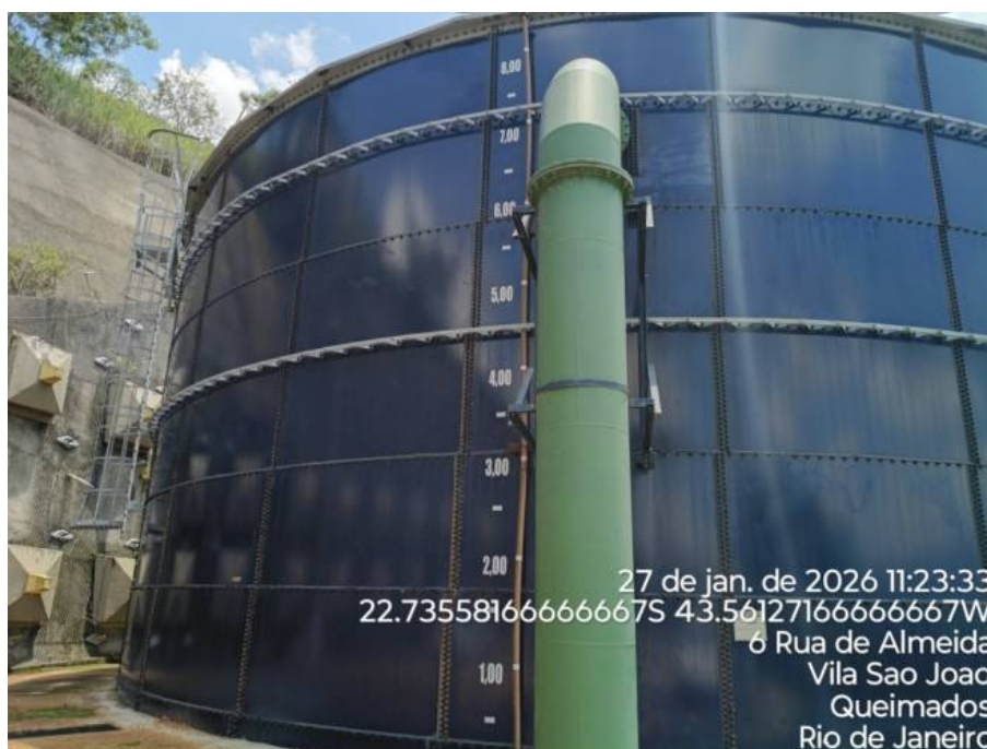
Foto 7: Tubulações de extravasamento em boas condições estruturais, bem como escada de acesso disposta adequadamente.
