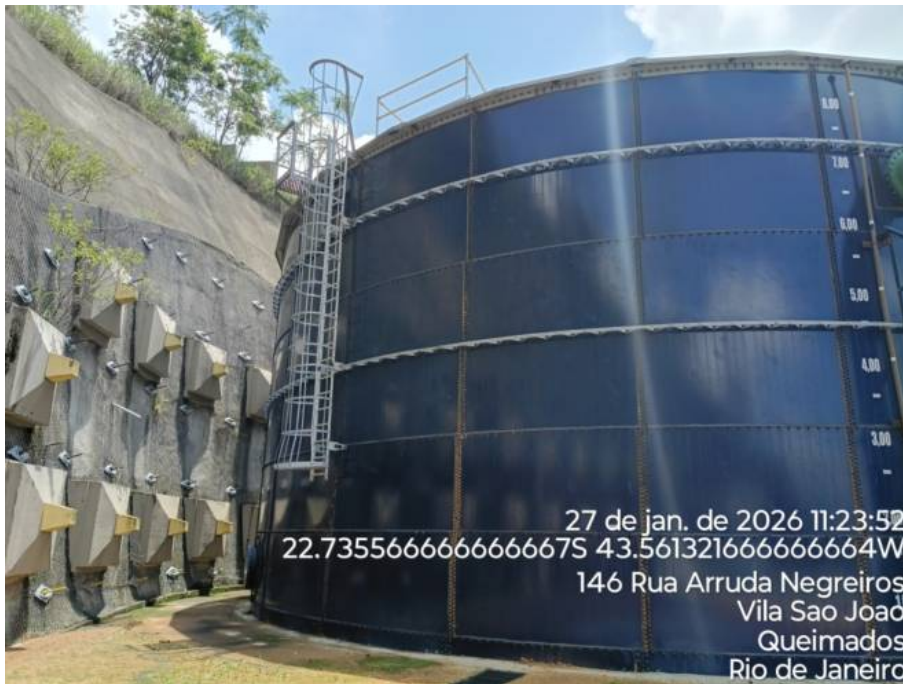
Foto 2: Reservatório com pintura recente e boas condições estruturais. Talude com obra de contenção.
