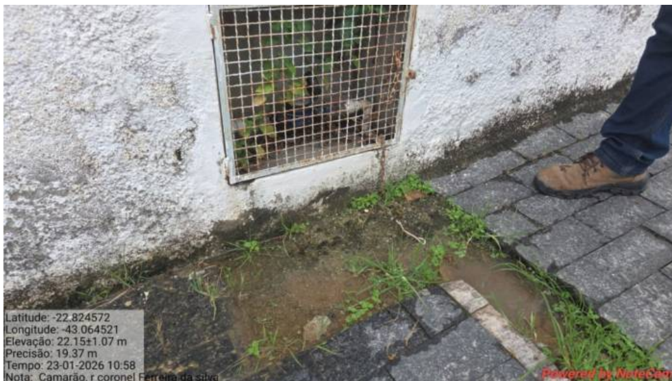
Foto 8 – Vazamento localizado na Rua Coronel Ferreira da Silva
