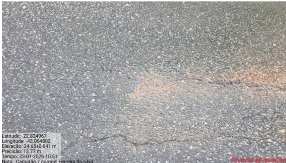
Foto 7 – Vazamento localizado na Rua Coronel Ferreira da Silva
