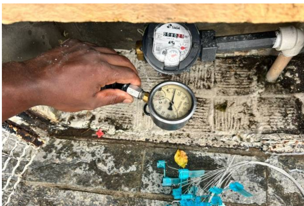
Foto 2 – Medição de pressão no imóvel nº 123
