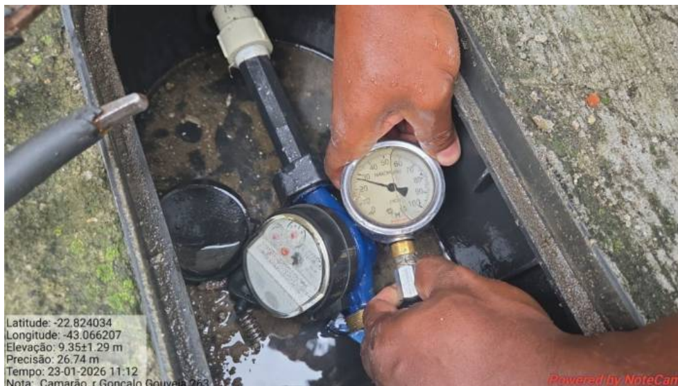
Foto 5 – Medição de pressão no imóvel nº 263
