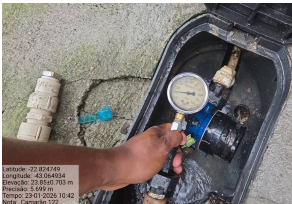
Foto 4 – Medição de pressão no imóvel nº 122
