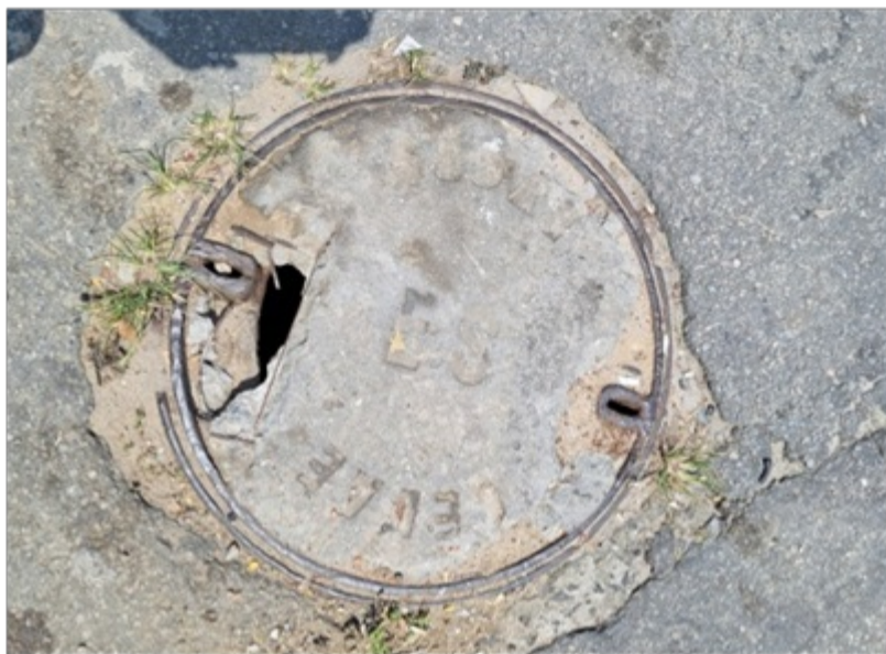
Foto 1 – Poço de Visita identificado a jusante do imóvel (tampão misto parcialmente danificado)
