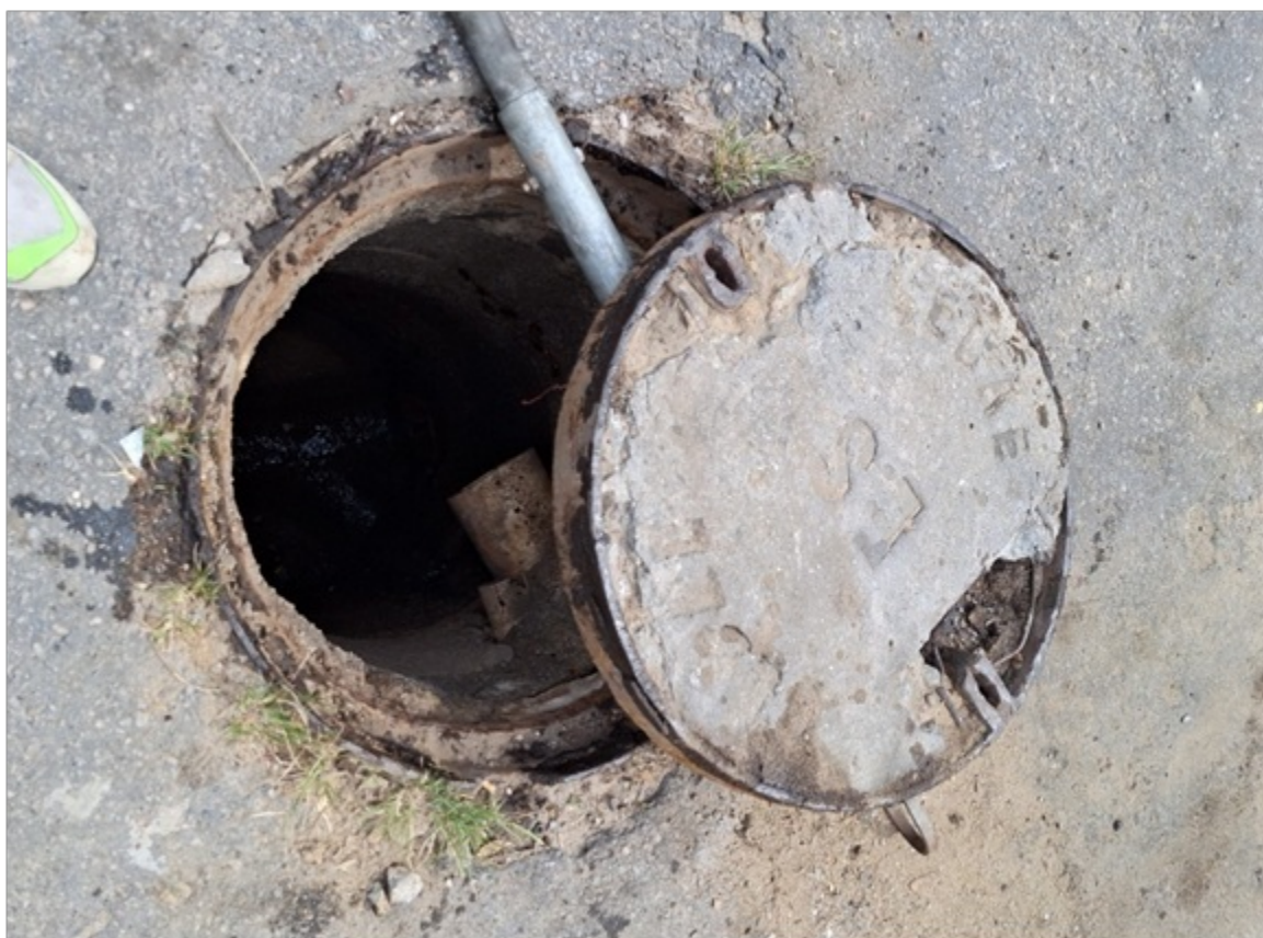
Foto 2 – Poço de Visita aberto com muita dificuldade
