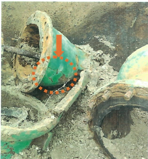
Foto 1- Detalhe da trinca por fadiga do material.
