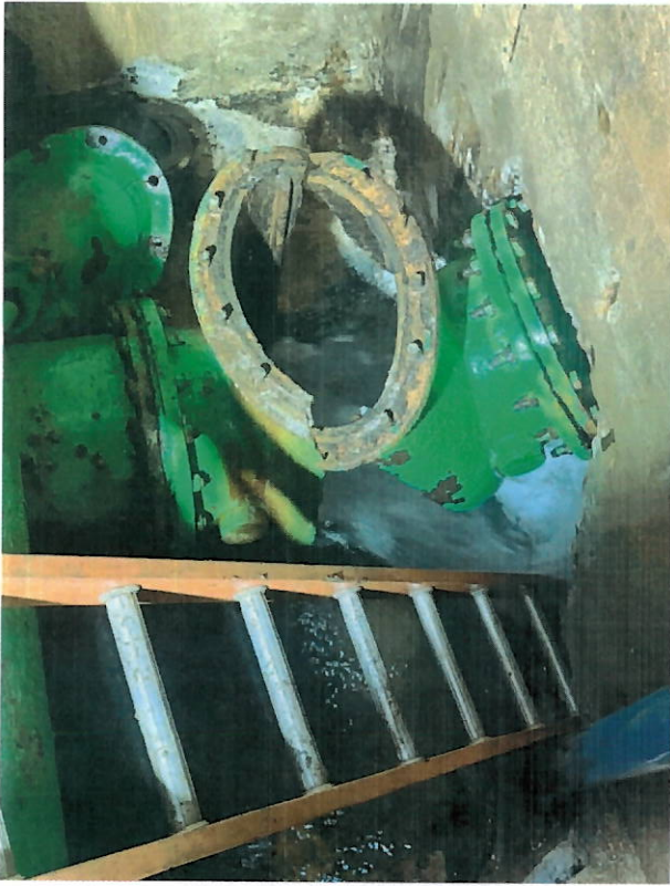
Foto 8 - Detalhe do corpo da válvula após a contenção e seu eixo ser expelido pela pressão hidráulica, observa-se que após a válvula havia um fechamento com um flange cego.
