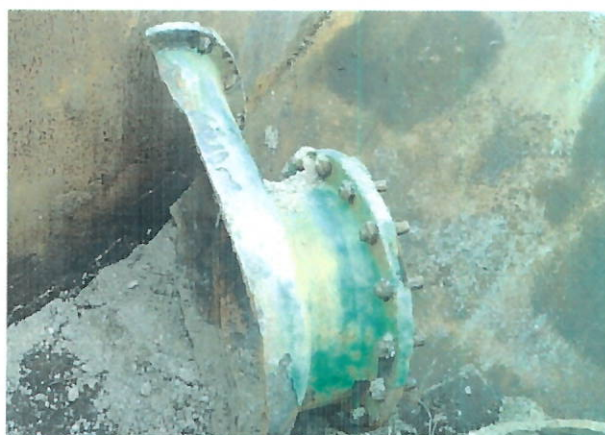
Foto 2 - Detalhe do corpo da válvula (rompido por fadiga do material).
