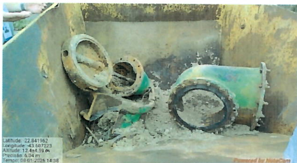
Foto 3 - Detalhe da comportada da válvula que foi expelida e parte do corpo da válvula rompida por fadiga
