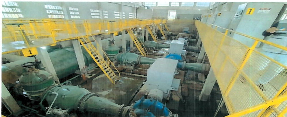
Foto 10 - Vista geral da localização das motobombas da Elevatória do Alto Recalque do Guandu – ARG. Este local foi inundado pelas águas do refluxo das adutoras que abastecem o Reservatório do Marapicu.
