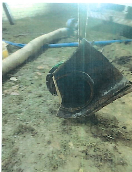
Foto 4 - Detalhe da comportada da válvula que foi expelida e parte do corpo da válvula rompida por fadiga.
