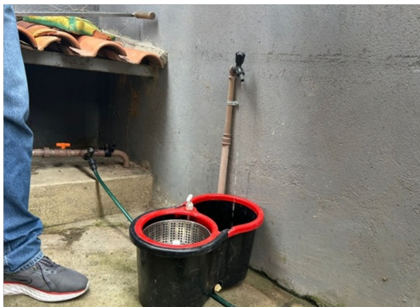
Foto 3 - Pressão de água insuficiente abastecer o reservatório superior
