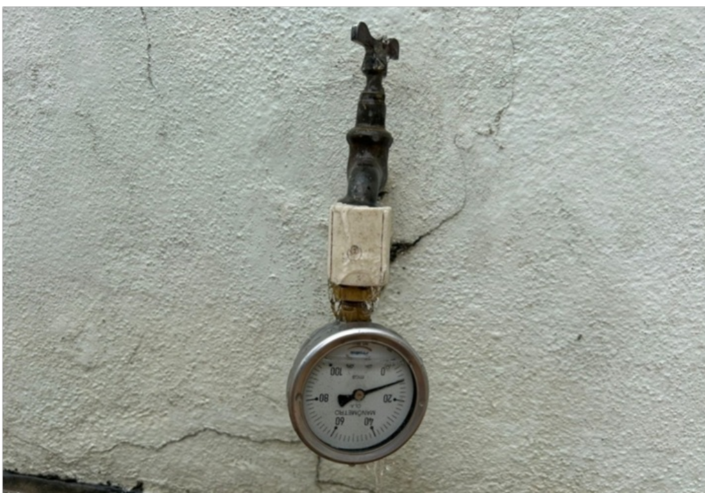
Foto 5 - Pressão manométrica medida de 10 MCA no imóvel nº 533, Rua Albino Paiva
