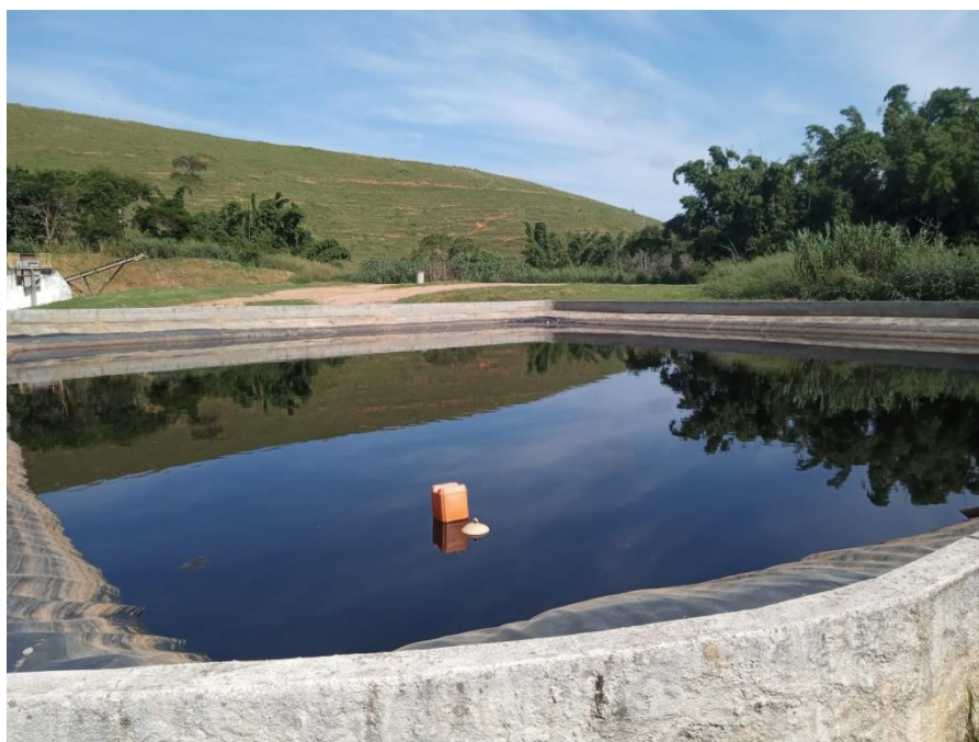
Figura 35: Lagoa de recebimento e armazenagem de chorume.
