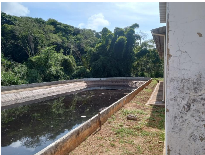
Figura 37: Lagoa de recebimento e armazenagem de chorume.
