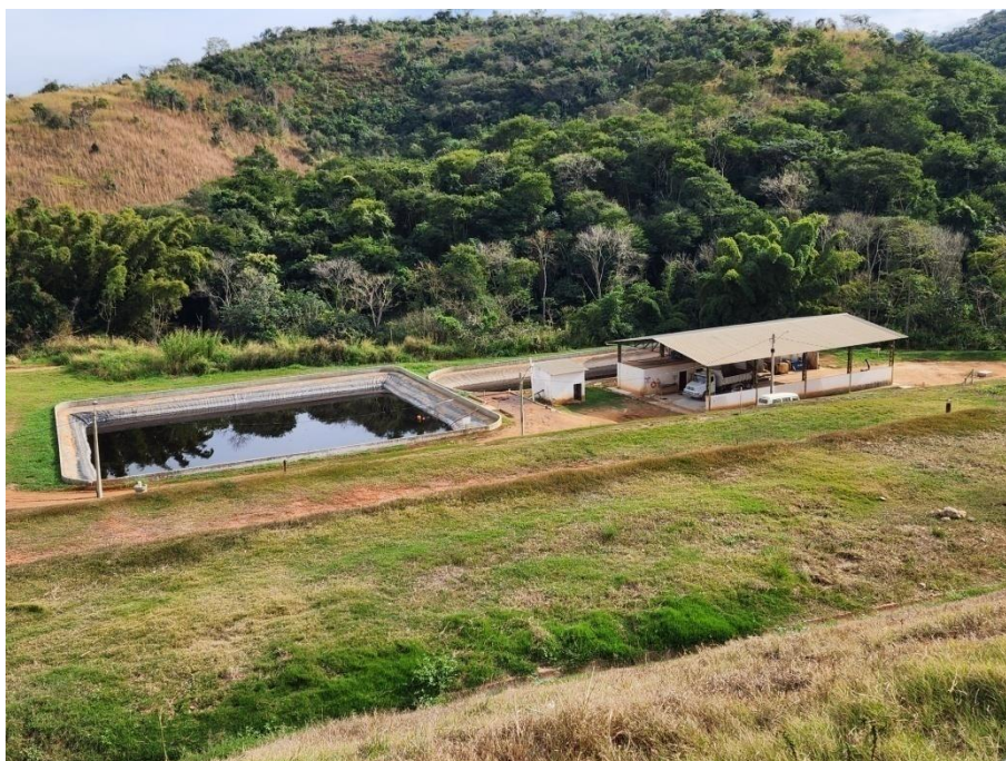
Figura 12: Vista das lagoas de recebimento e armazenagem de chorume
