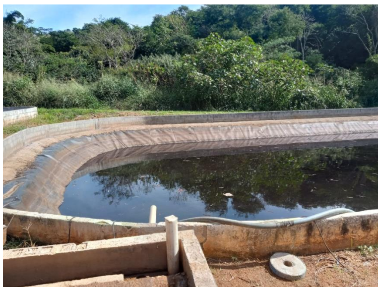
Figura 36: Lagoa de recebimento e armazenagem de chorume.
