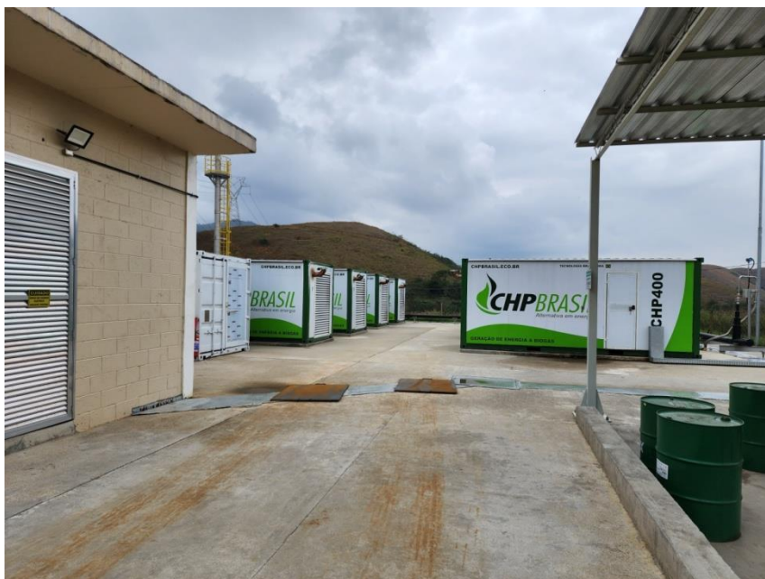
Figura 17: Geradores da estação de biogás
