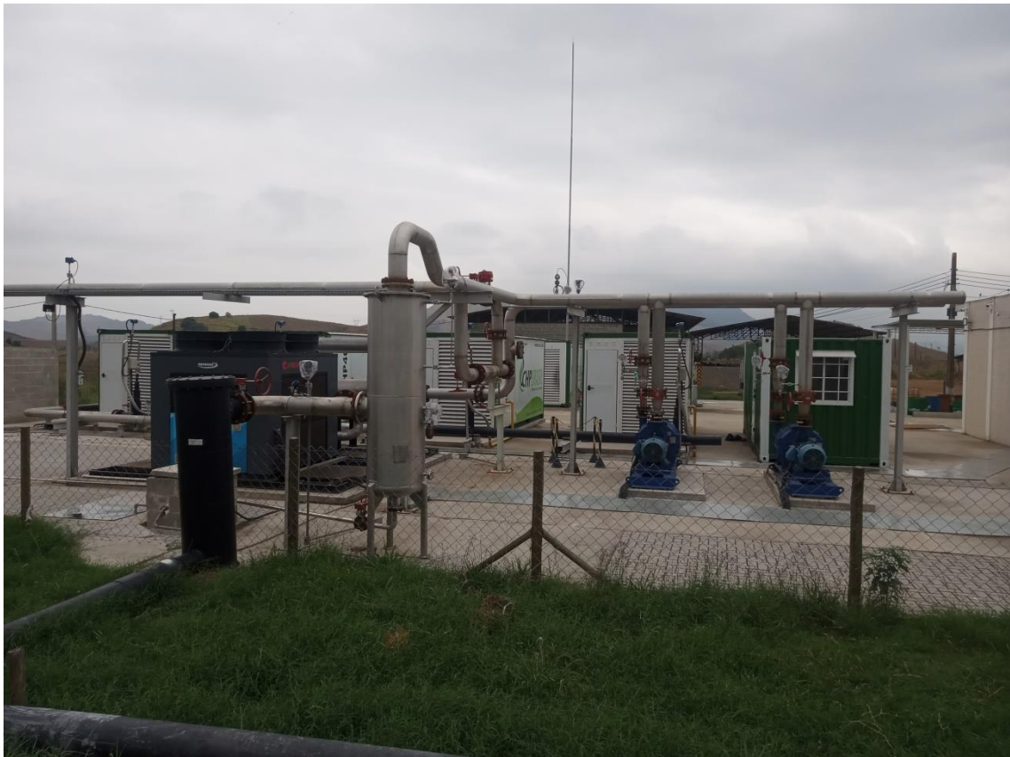
Figura 18: Visão da estação de biogás.
