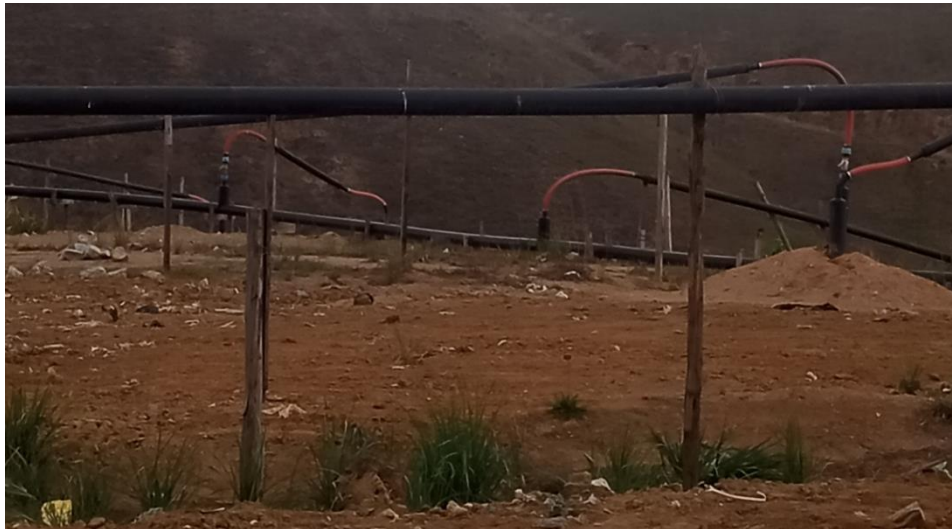
Figura 5: Dutos de captação de gases.
