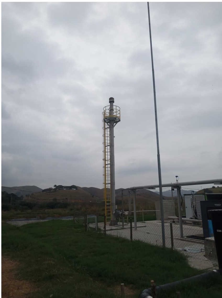
Figura 19: Flare da Estação de Biogás
