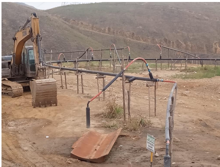
Figura 6: Captação dos gases para a estação de biogás.
