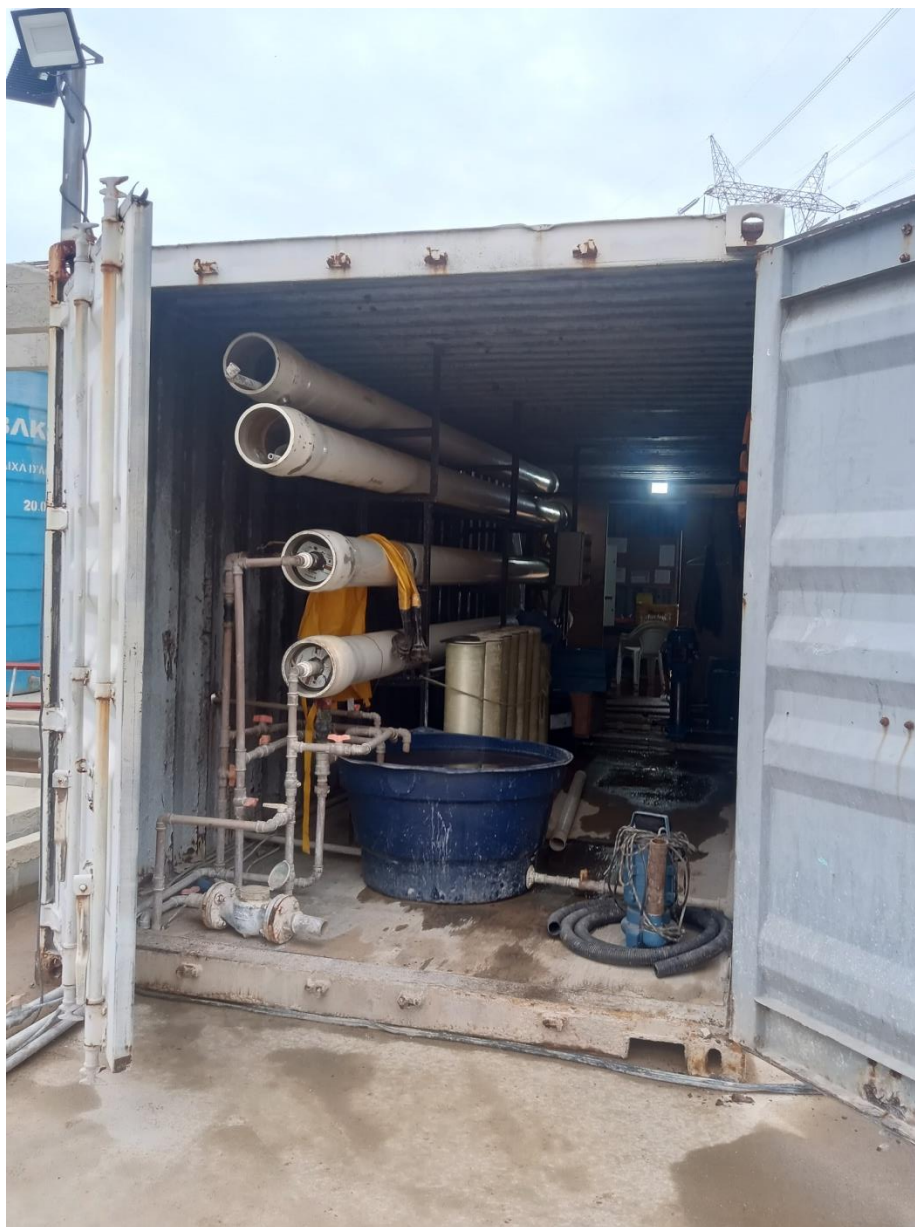
Figura 13 : Equipamento de Osmose reversa para tratamento do chorume
