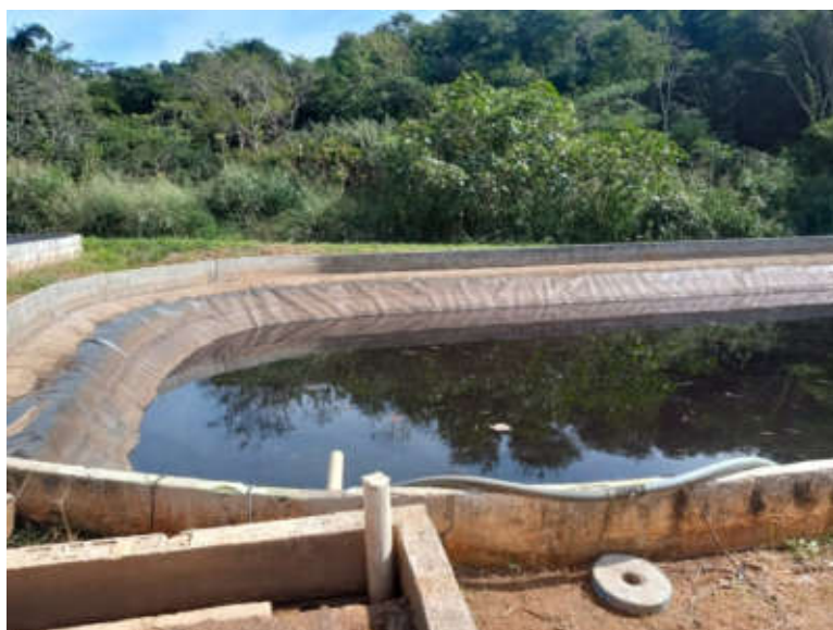
Figura 36: Lagoa de recebimento e armazenagem de chorume.
