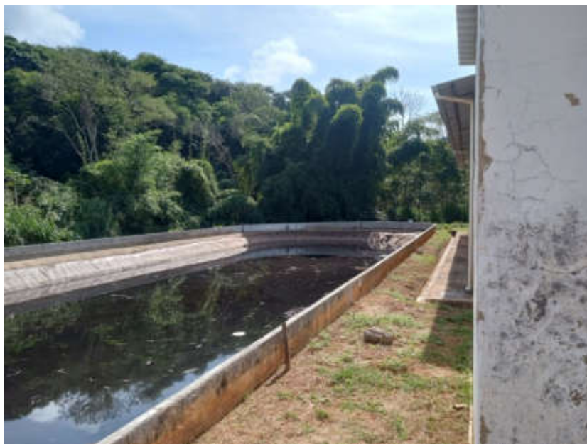
Figura 37: Lagoa de recebimento e armazenagem de chorume.
