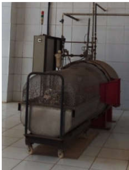
Figura 49: Autoclave disponibilizada para realizar o tratamento de RSS. Inoperante
