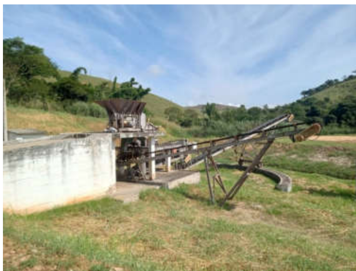
Figura 52: Triturador de resíduos da construção civil. Há um funcionamento muito abaixo do esperado, esporadicamente tem sido posto em operação
