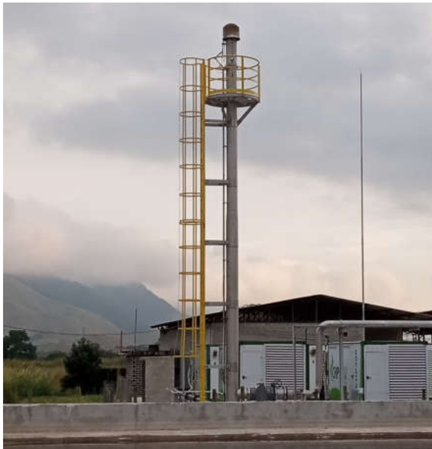
Figura 26: Flare da Estação de Biogás
