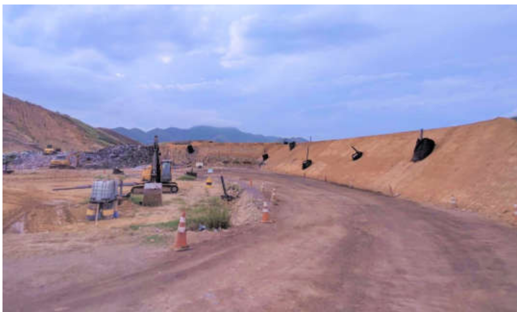
Figura 7: Tubos de captação de gases.
