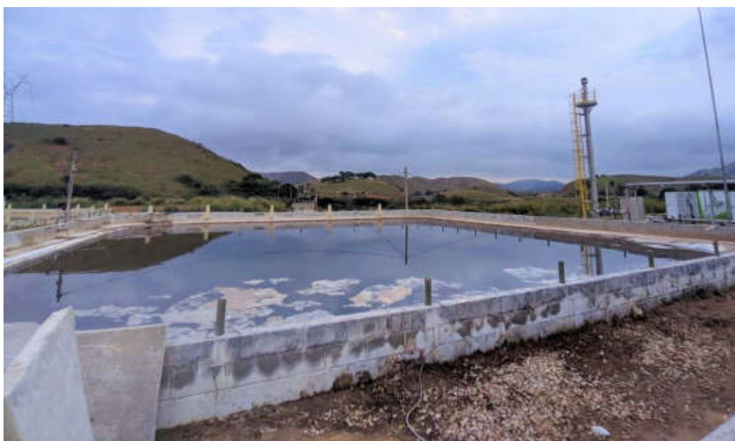
Figura 12: Lagoa de chorume secundária e ao fundo, Flare da estação de biogás.
