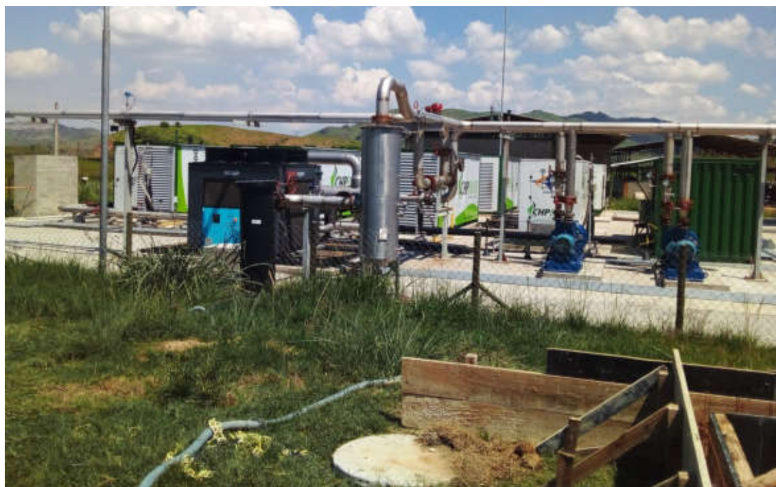
Figura 25: Visão da estação de biogás.
