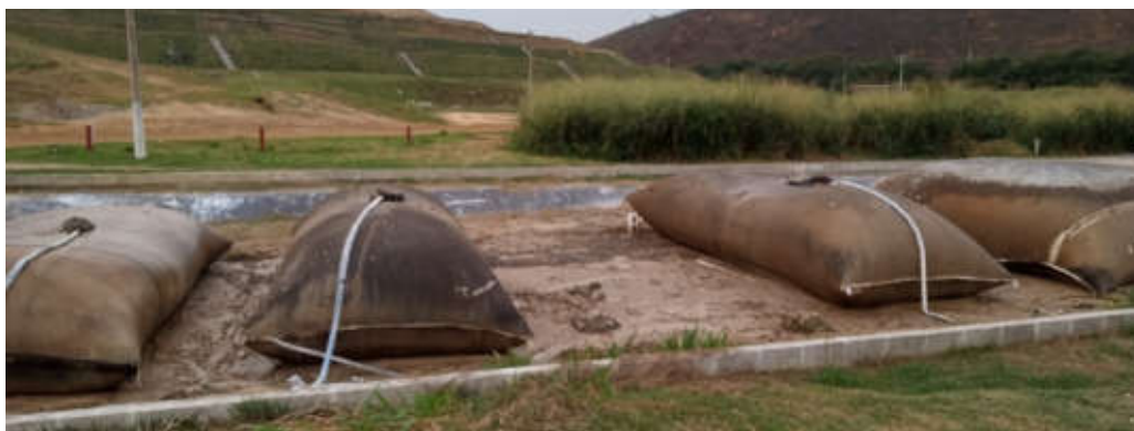
Figura 16: BGS de armazenagem e secagem de lodo.
