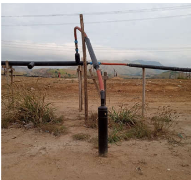
Figura 8: Captação dos gases para a estação de biogás.
