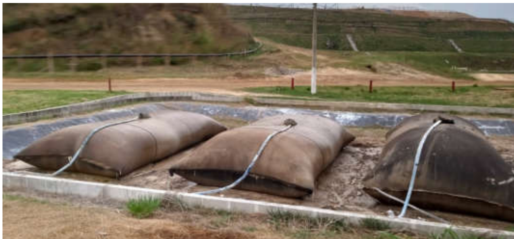
Figura 15: BGS de armazenagem e secagem de lodo.
