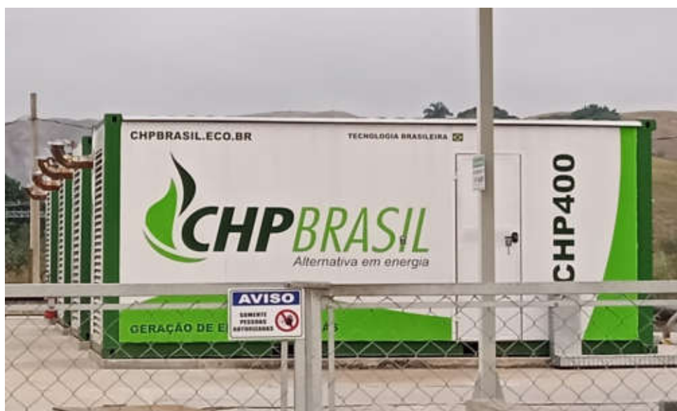
Figura 24: Geradores da estação de biogás.
