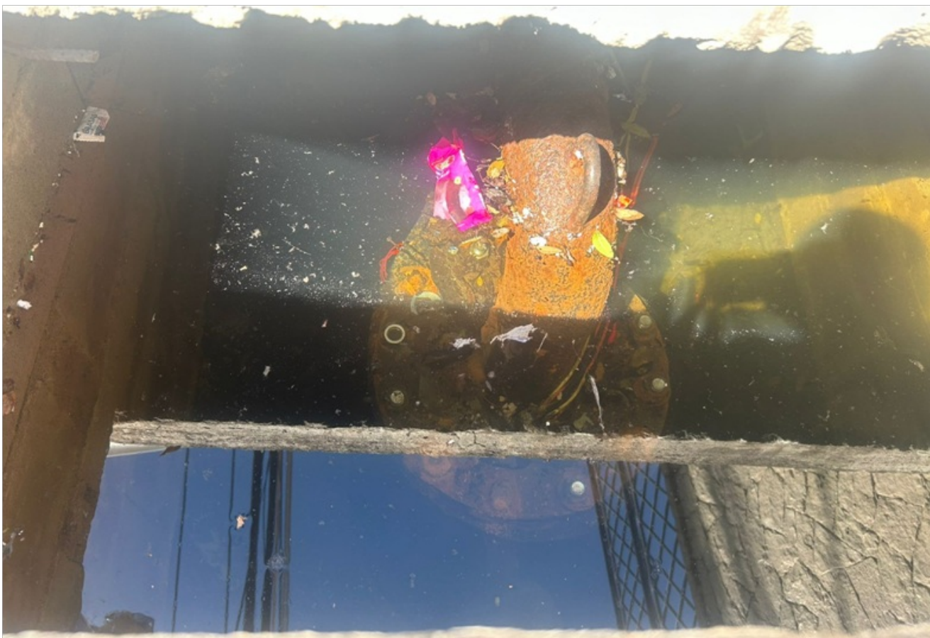
Foto 2 - Abrigo subterrâneo inundado
