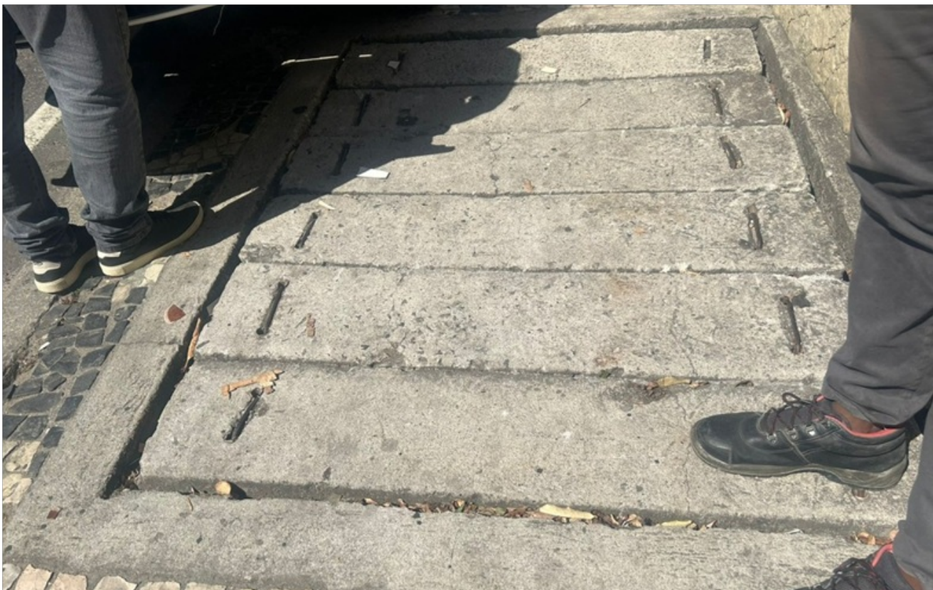
Foto 1 - Tampas do abrigo do conjunto motobomba da EEAT Tabelião Murilo Costa
