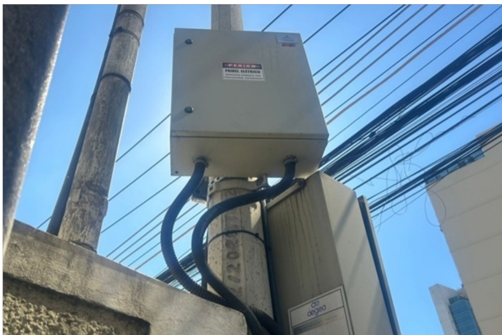
Foto 6 – Abrigo do painel elétrico
