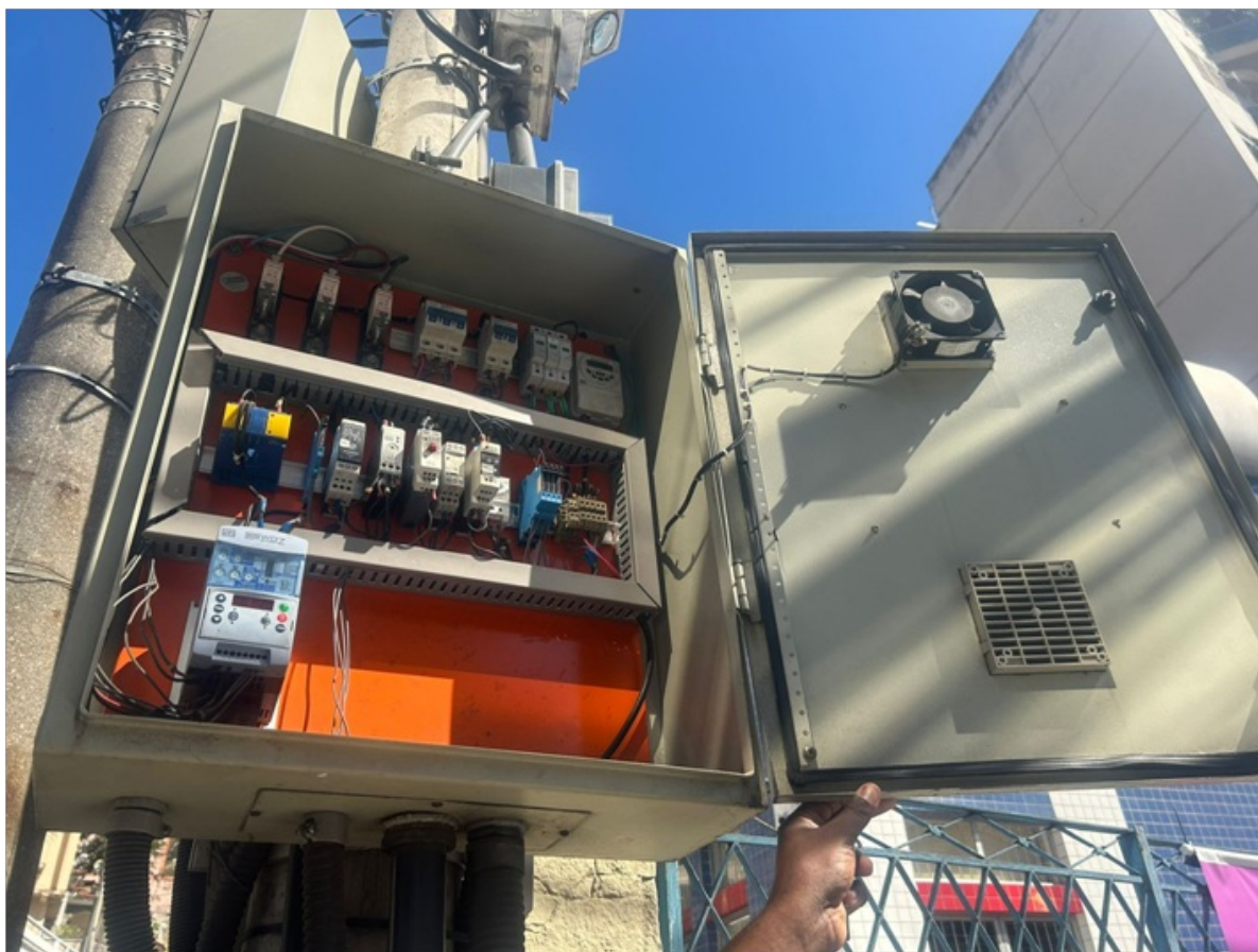
Foto 5 – Pannel em bom estado de conservação
