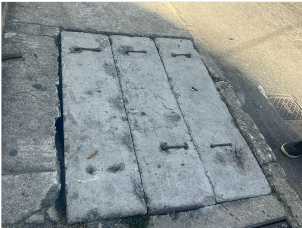
Foto 2 – Tampa de concreto da EEAT
