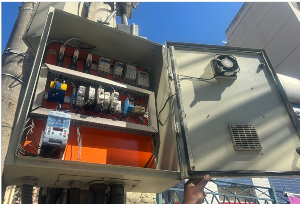
Foto 6 – Interior do abrigo do painel de automação com equipamentos em bom estado de conservação
