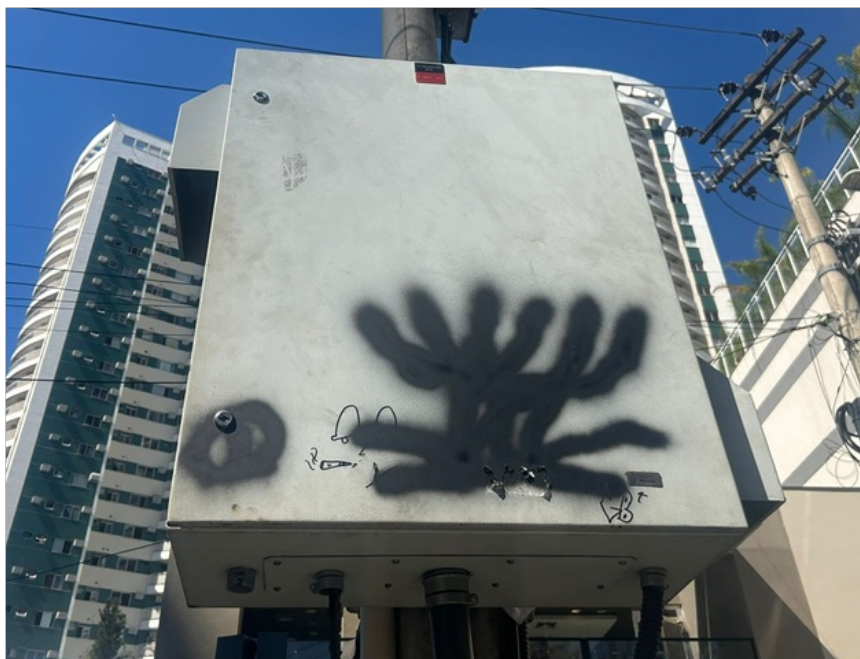
Foto 5 – Abrigo fechado do painel de automação sem sinalização de risco de choque elétrico
