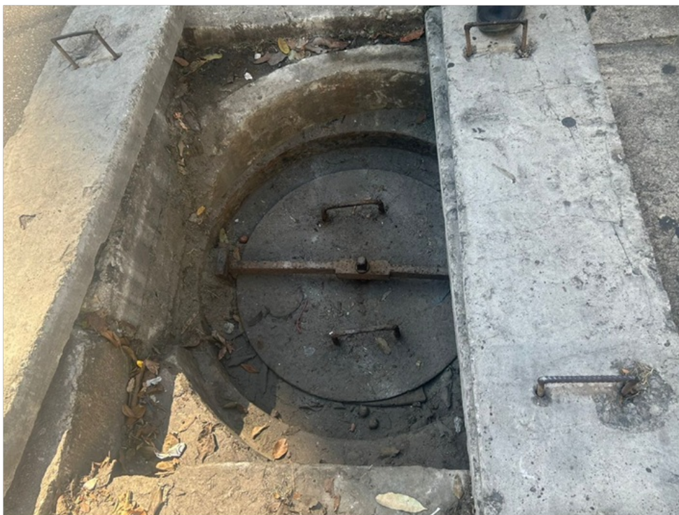
Foto 3 – Tampo de aço do “panelão” da EEAT
