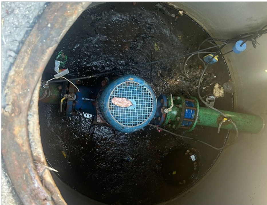
Foto 4 – Conjunto motobomba do tipo centrífuga “in line”
