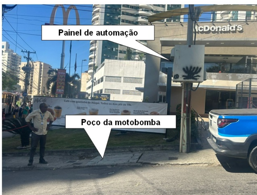
Foto 1- EEAT sem identificação
