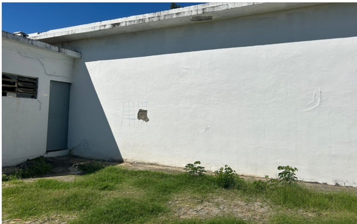
Foto 11 – Vegetação (capim) avançando no pátio em torno do reservatório
