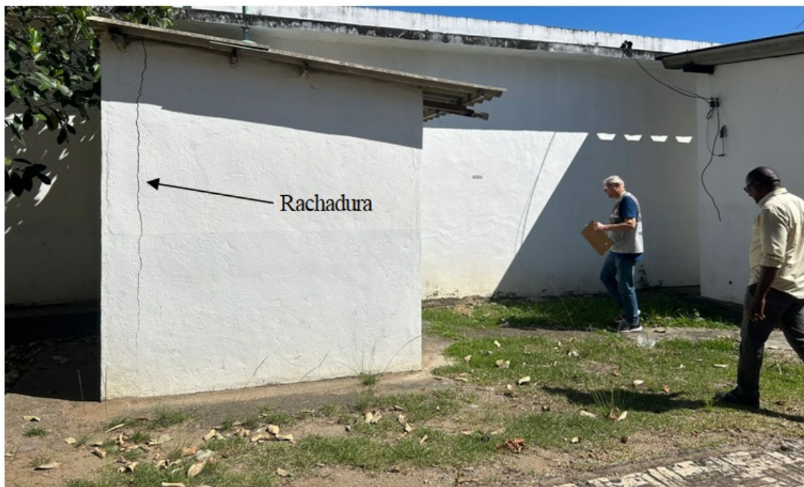
Foto 12 – Rachadura na parede da edícula
