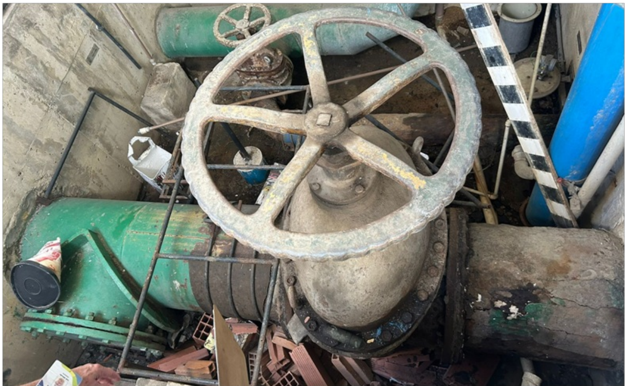
Foto 7 – Plataforma e escada sem piso
