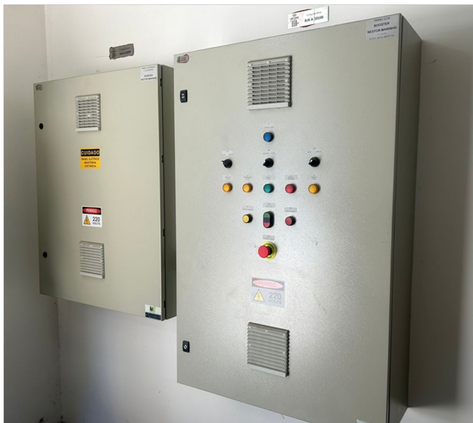
Foto 5 - Painel elétrico e de automação em ótimo estado de conservação e sinalizados quanto ao risco de choque elétrico
