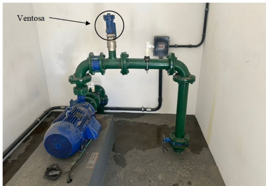
Foto 2 – Conjunto motobomba da EEAT com ventosa na tubulação de recalque
