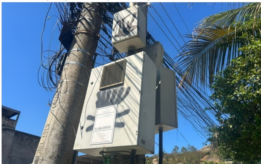
Foto 6 – Painel de automação
