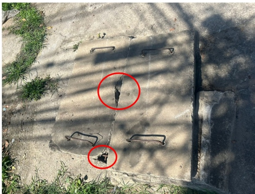
Foto 2 – Tampa de concreto deteriorada
