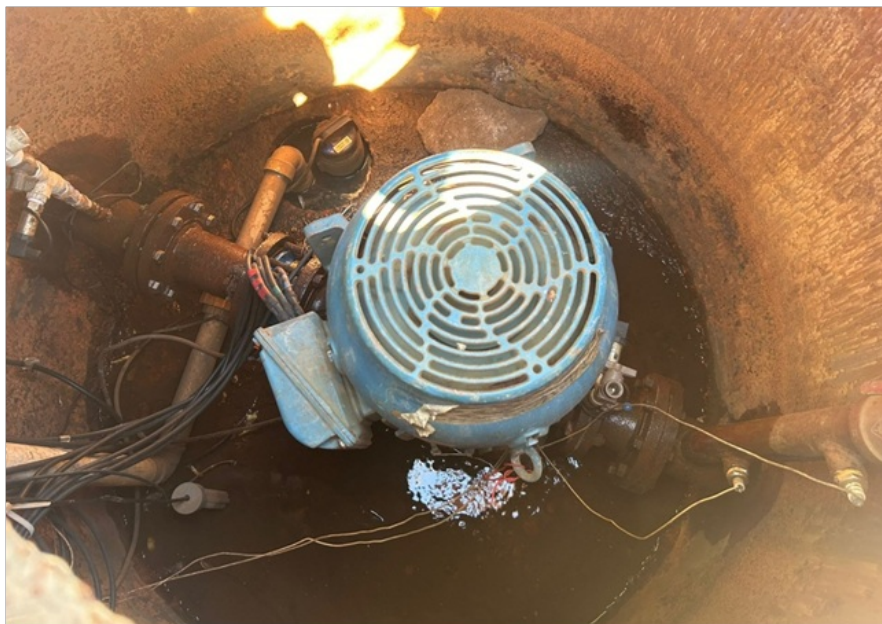
Foto 4 – Conjunto motobomba da EEAT do tipo centrífuga in line
