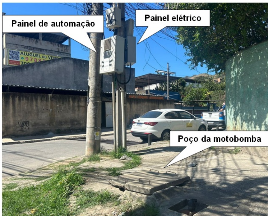
Foto 1 – Localização da EEAT sem identificação
