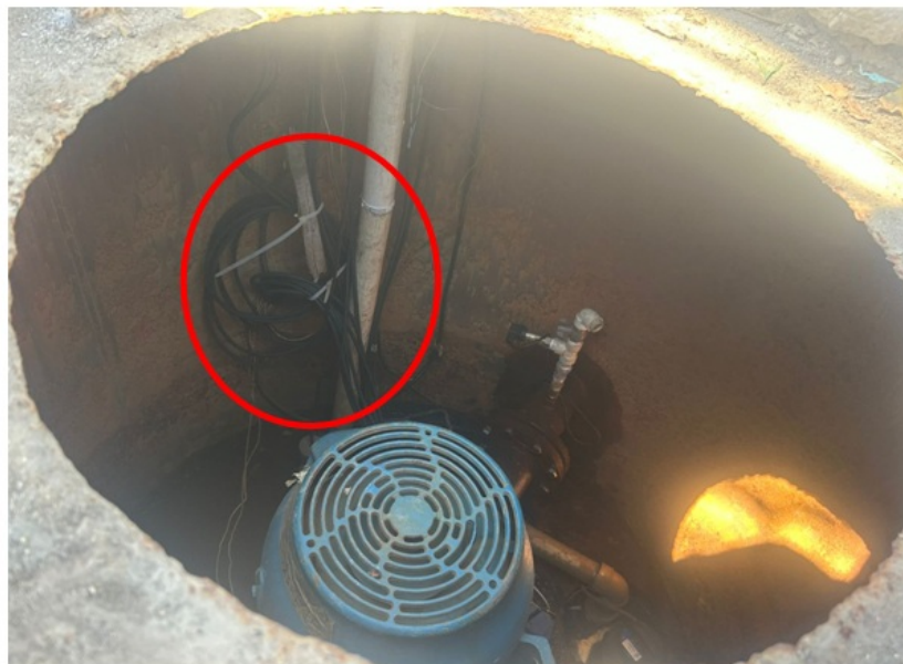
Foto 5 – Disposição irregular da fiação elétrica
