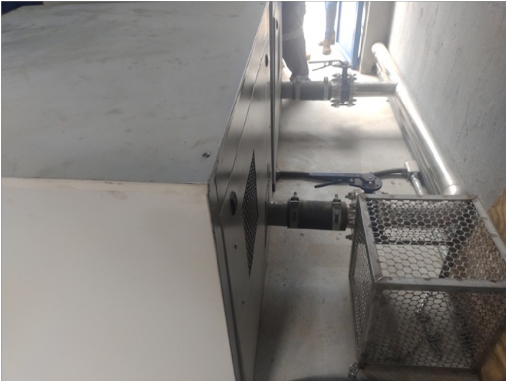
Foto 09 – Sopradores do reator
