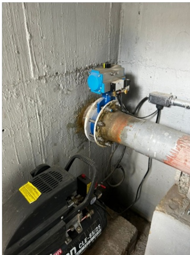
Foto 21 – Válvula de retenção na saída do efluente para calha
