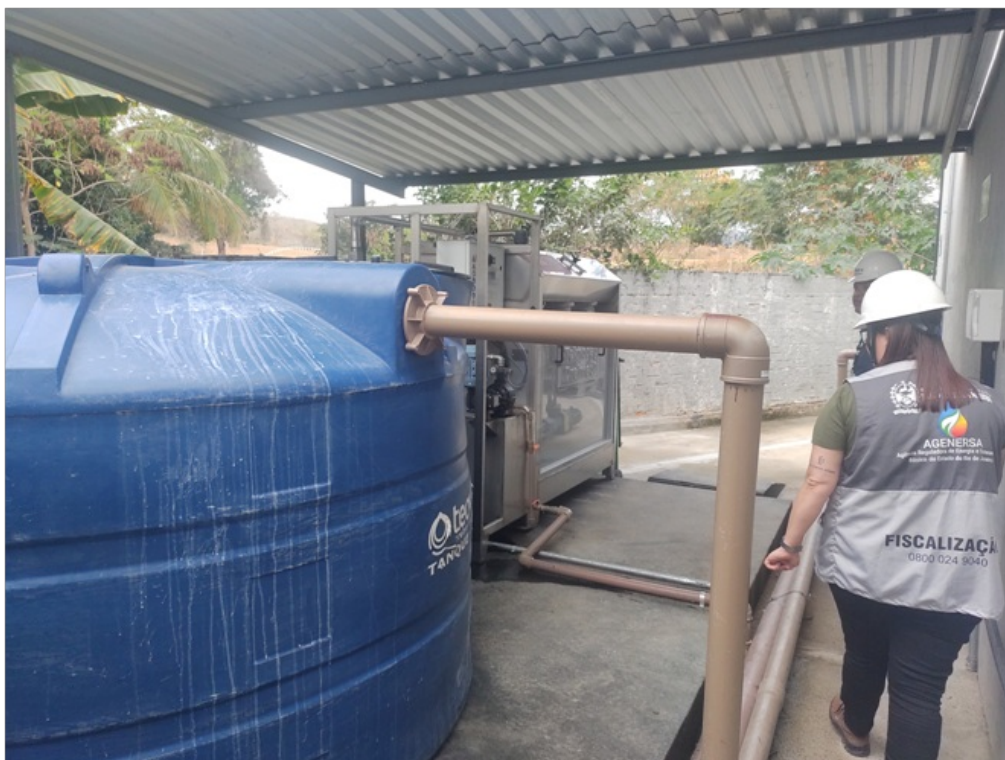
Foto 13 – Tanque de lodo
