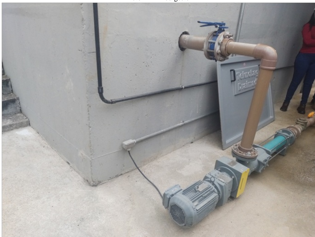
Foto 12 – Tubulação e bomba dreno de lodo
