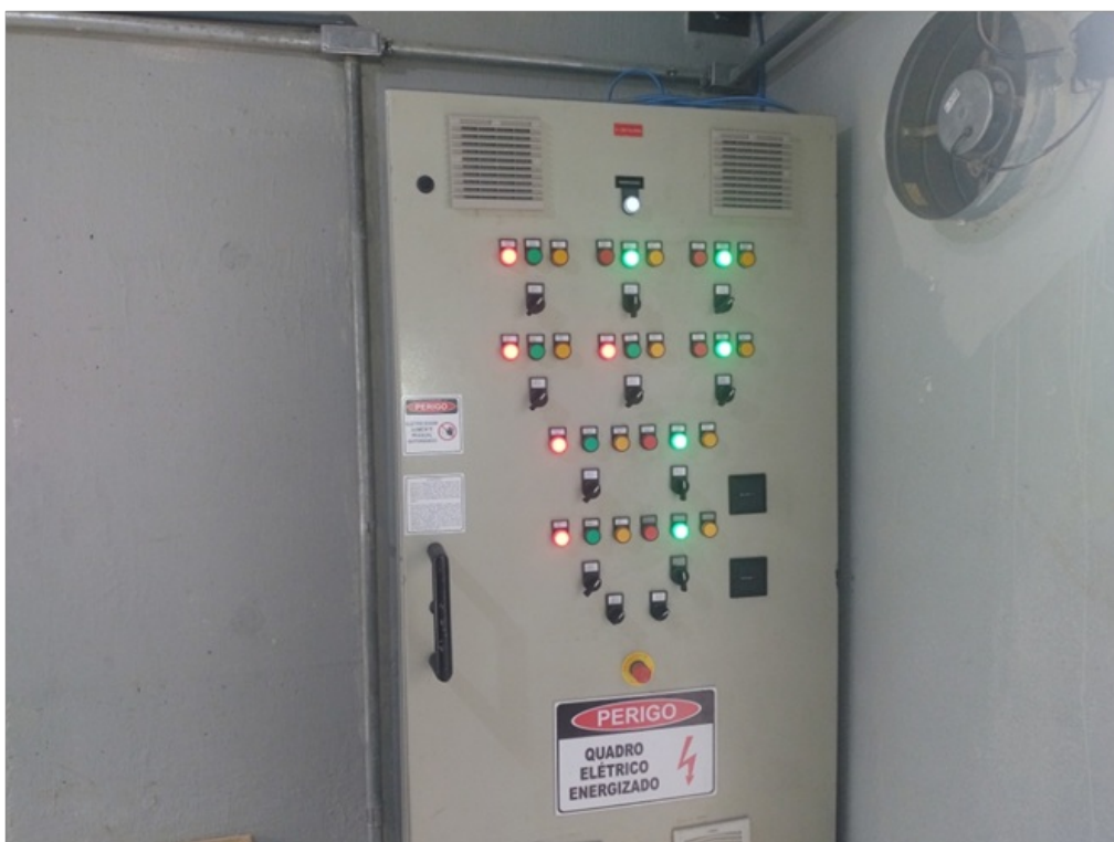
Foto 17 – Quadro de comando
