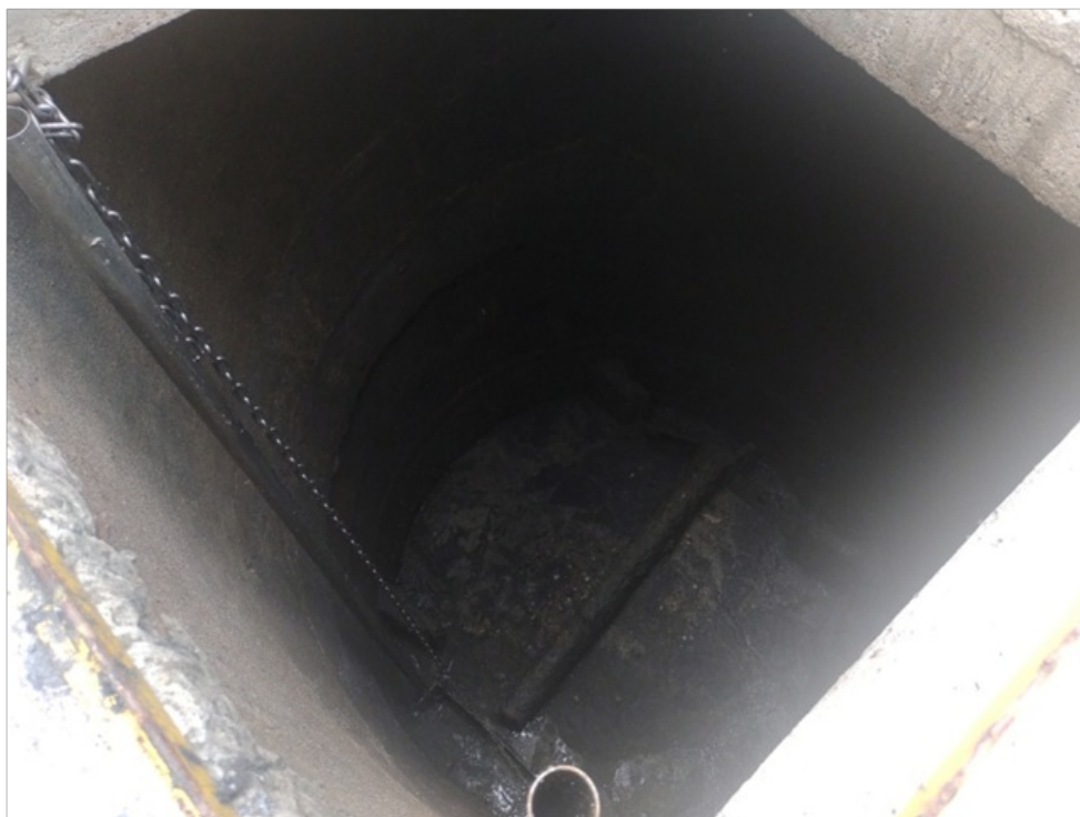
Foto 03 – Caixa de gordura
