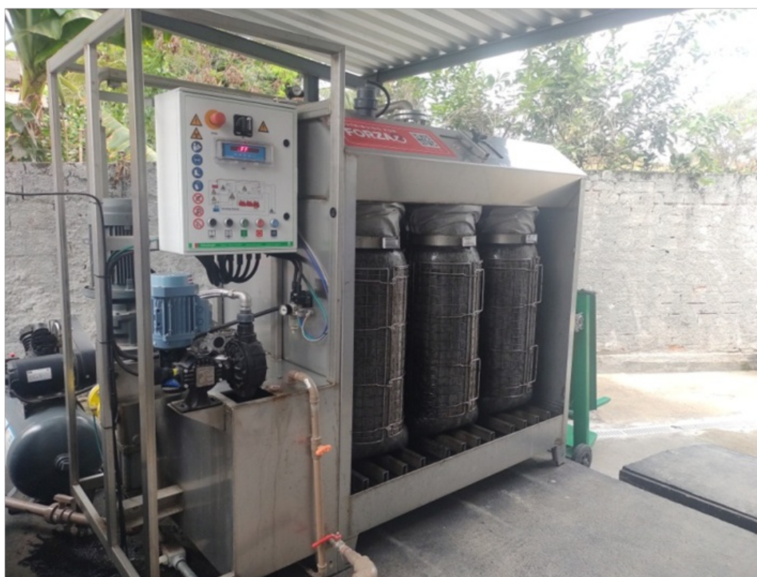
Foto 14 – Planta de desidratação do lodo
