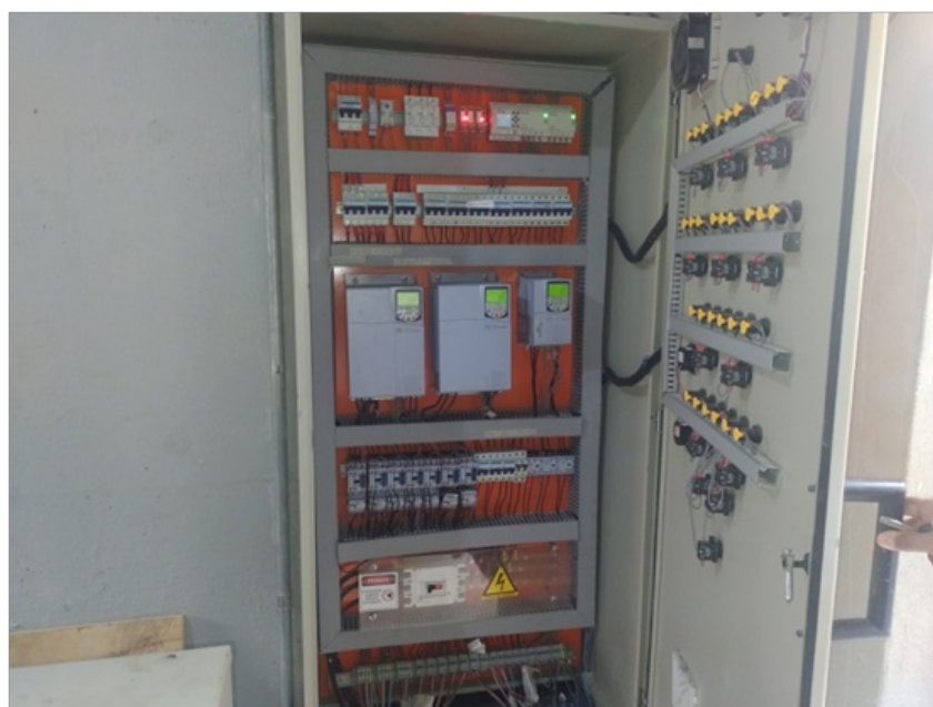
Foto 18 – Quadro de comando em evidência inversores de frequência
