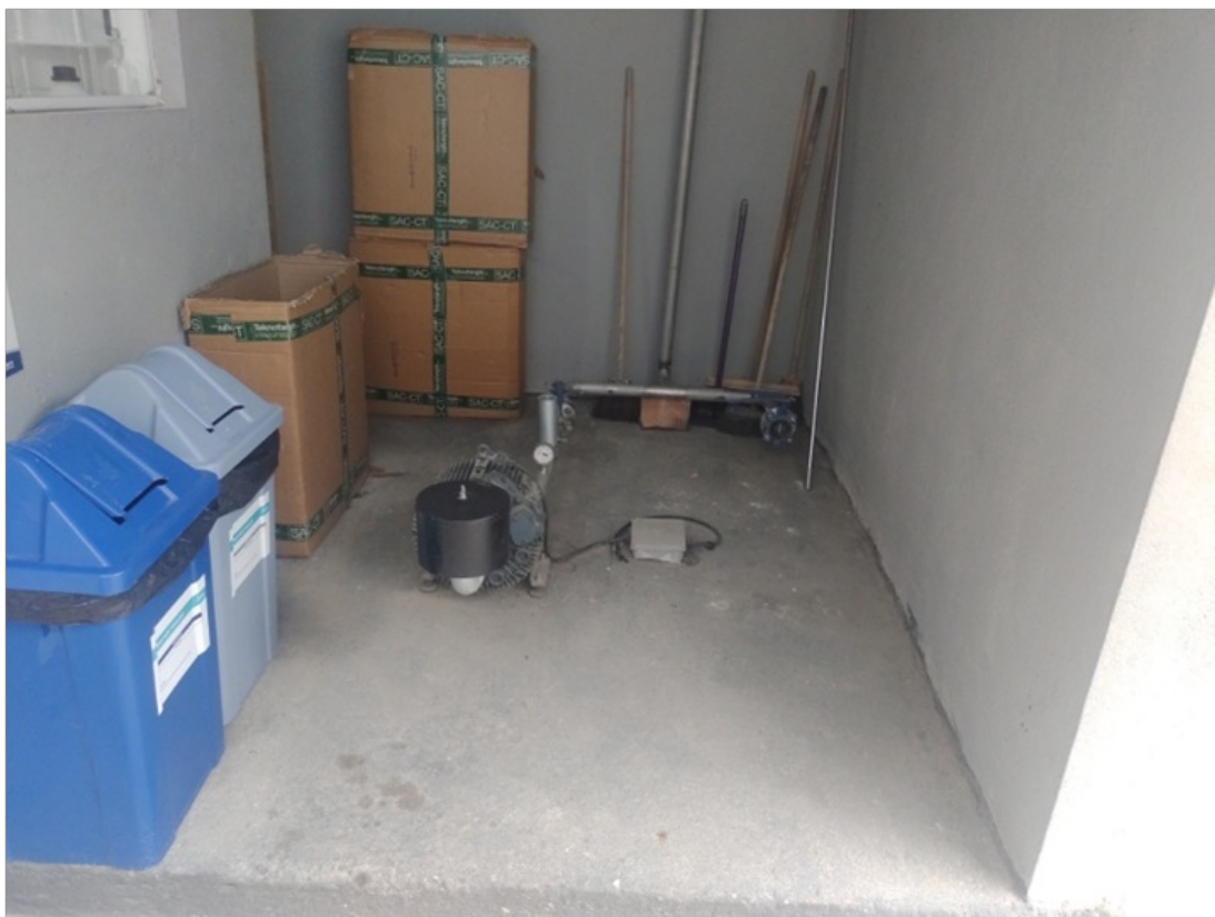
Foto 07 – Soprador da caixa de equalização
