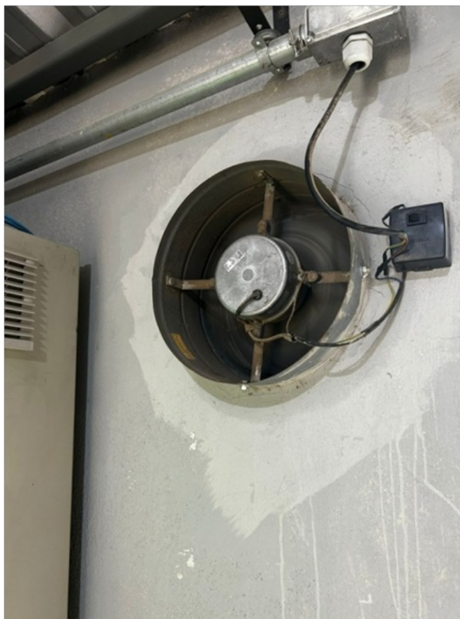
Foto 19 – Exaustor casa de máquinas
