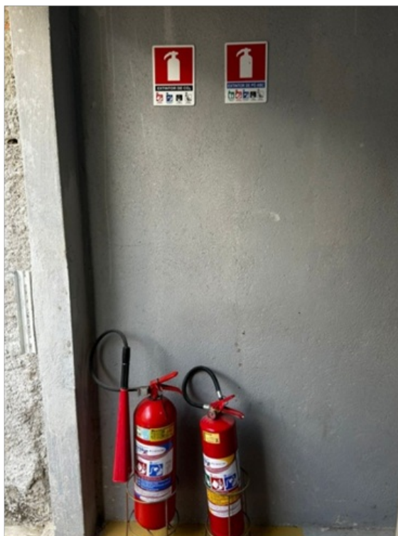
Foto 20 – Extintores casa de máquina
